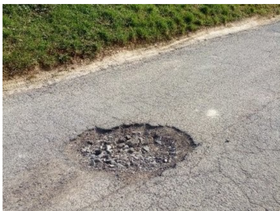
Obrázek 1 Příklad výtluku na pozemní komunikaci (Technické služby Zlín, 2020)
