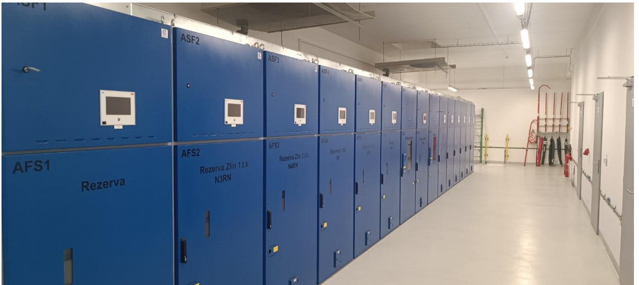
Příloha E - Fotografie rozvaděče 27 kV
