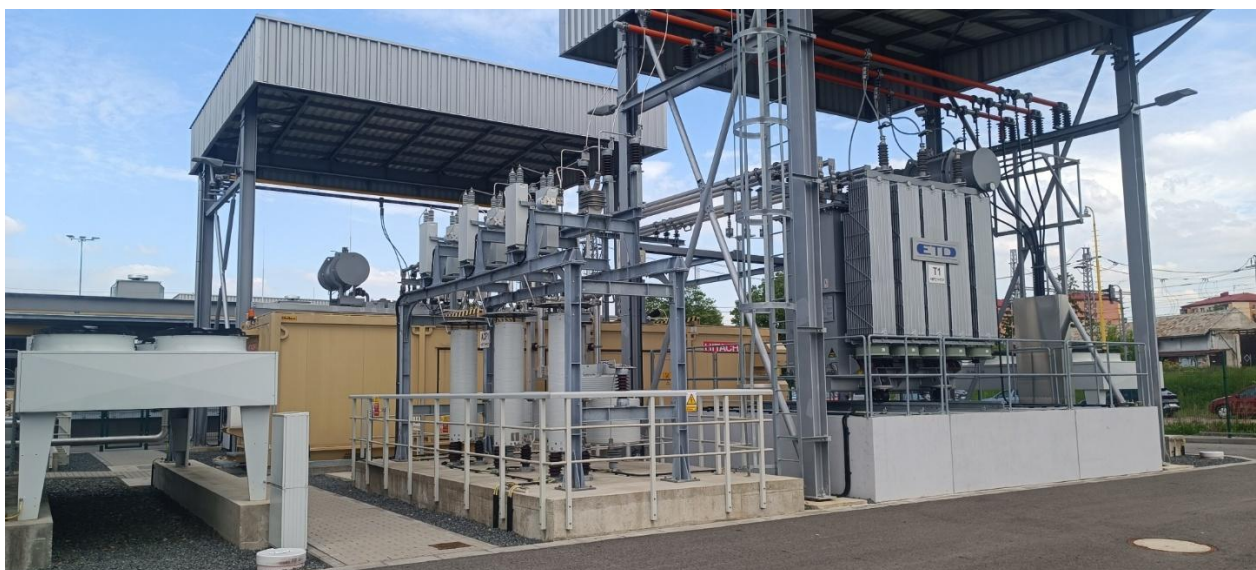
Priloha B - Fotografie privodoveho transformatoru k SFC
