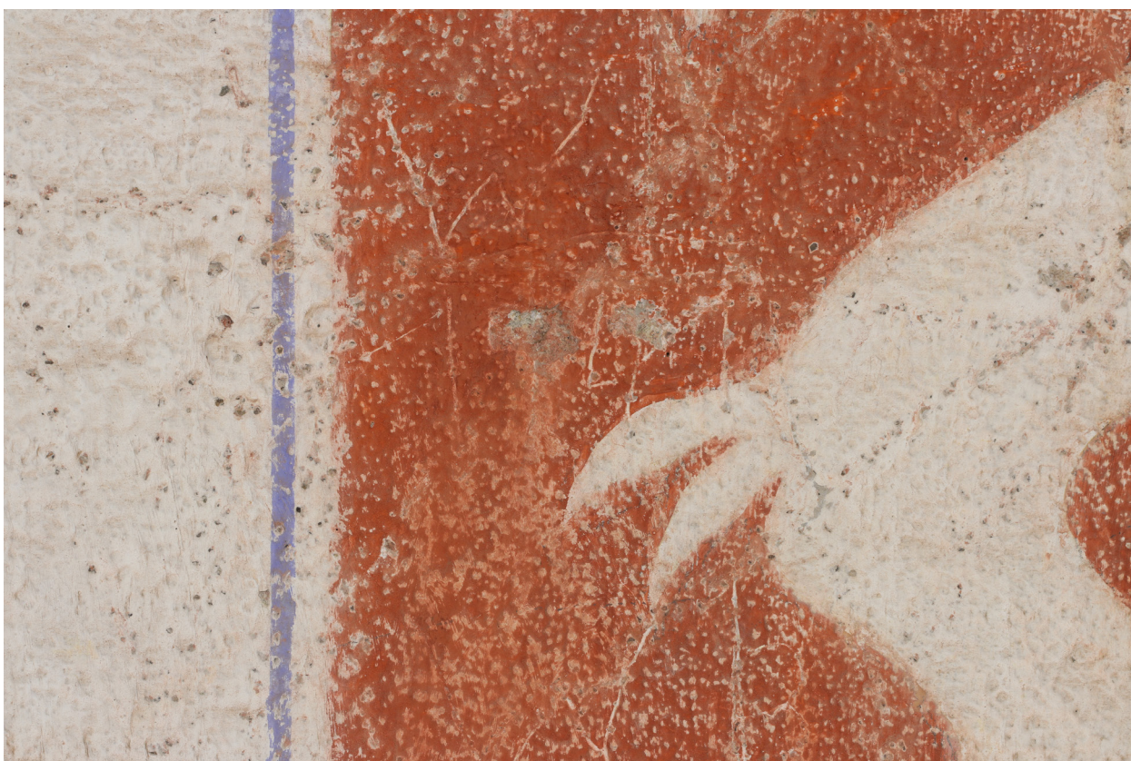
Obr. 26: Zdůraznění struktury stěn s defektem odhalené armatury a s druhotným tmelem na stěně se jmenným seznamem osádky pomocí ostrého bočního nasvícení. Jihozápadní stěna skladu munice v 1. podzemním podlaží. Stav před restaurováním.
