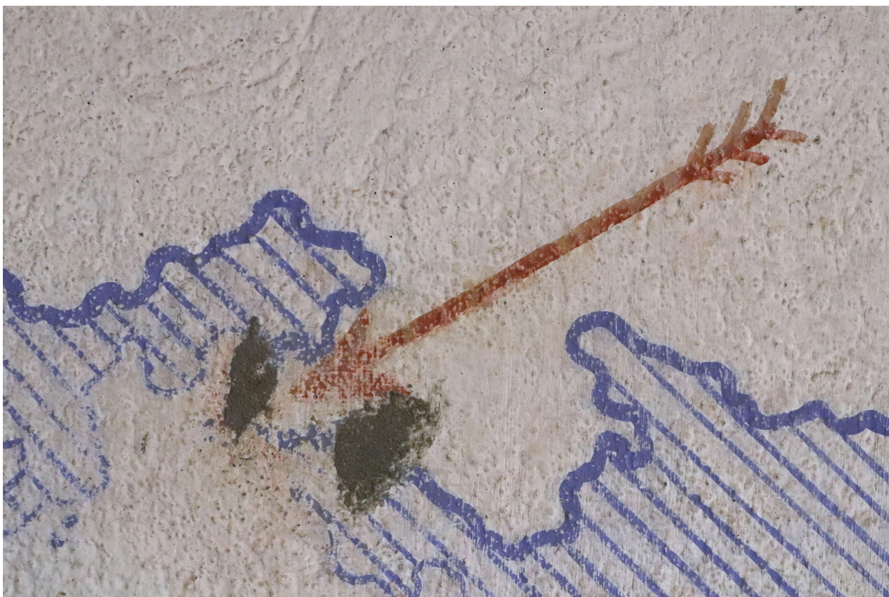
Obr. 20: Detail druhotného osazení fragmentů omítky s malbou a tmelu v oblasti zvonu tanku. Severovýchodní stěna skladu munice v 1. podzemním podlaží. Stav před restaurováním.
