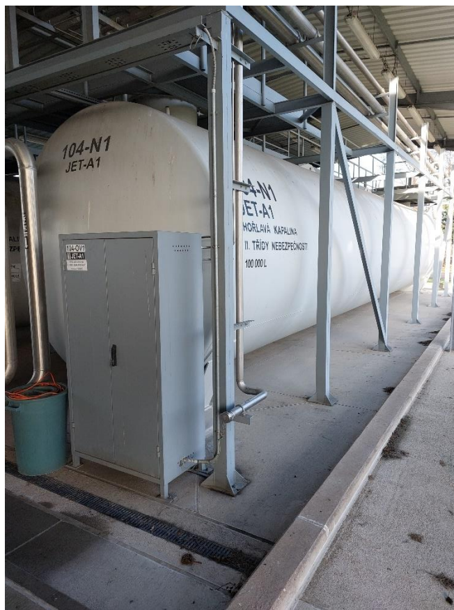
Obrázek 5 Skladovací nádrž na letecký petrolej JET-A1 na letišti v Pardubicích. Zdroj: autor 2024.
