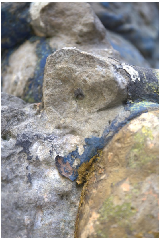
obrázek 24 detail levé nohy, odpadlé chodidlo, otvor po armatuře
