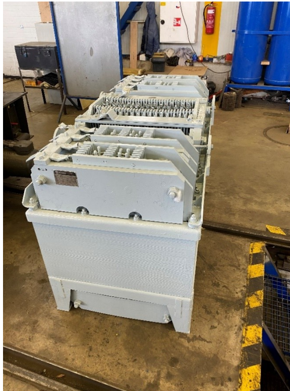
Obr. 16 Souprava tlumivek lokomotivy 363 vytažená z transformátorové skříně.
