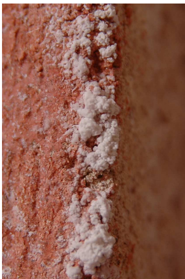
Obr. 32 Krystalizace solí na povrchu omítky
