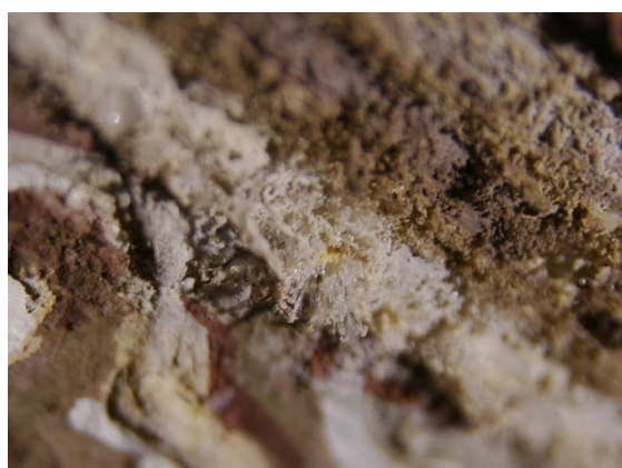
Obr. 6 Eflorescence na povrchu nástěnné malby (Palais Pálffy, Vídeň)
