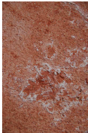
Obr. 33 Krystalizace solí na povrchu omítky
