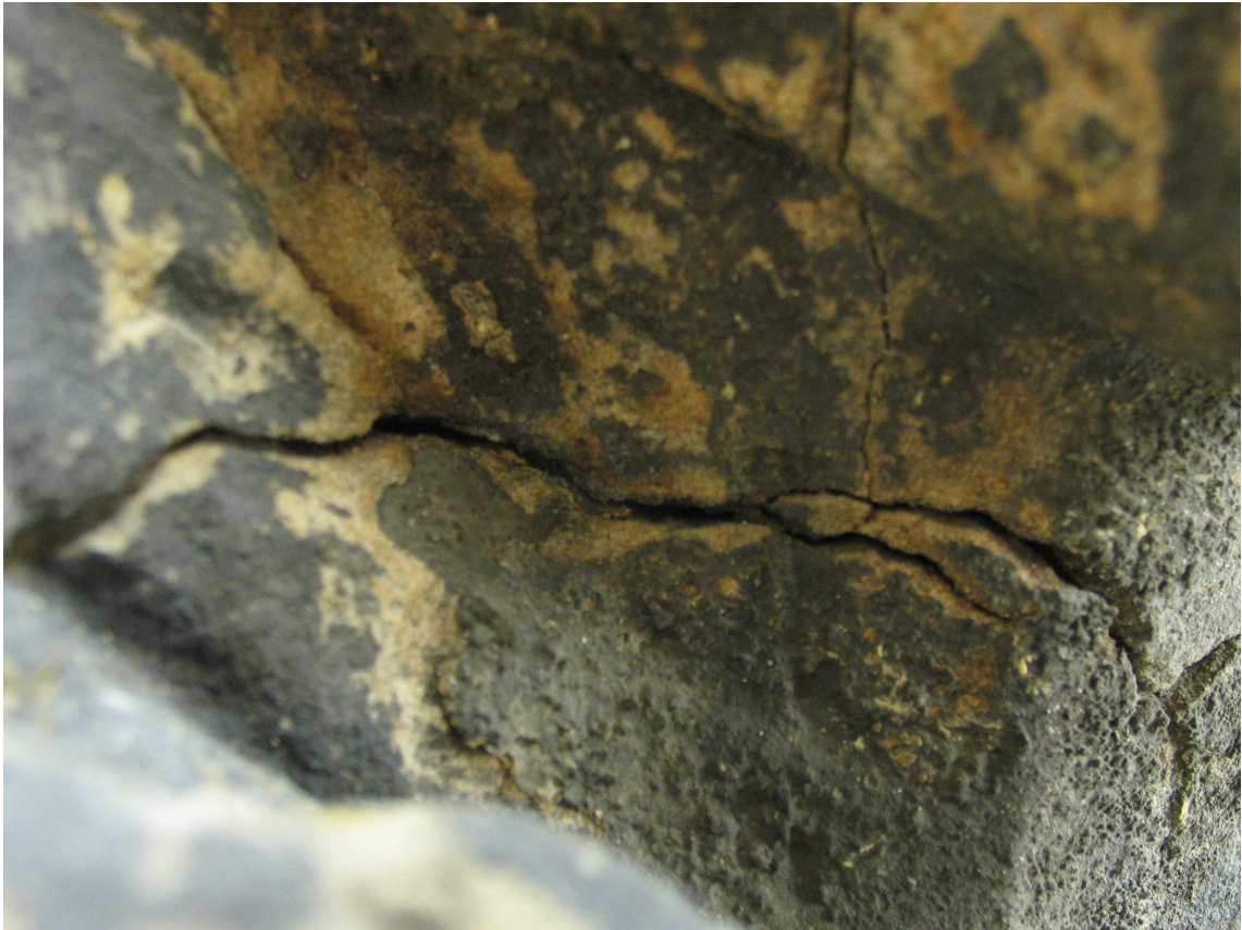
Obr.62 - praskliny v kameni
