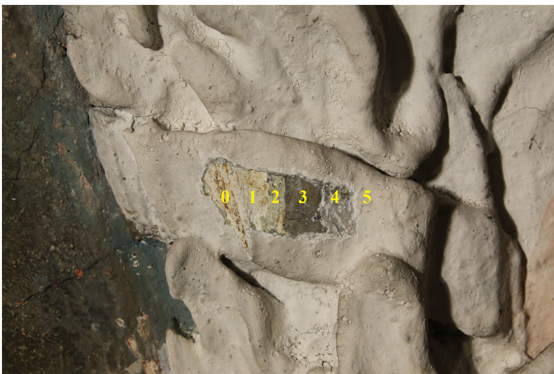
Obr.24: Sondážní průzkum. Stratigrafická sonda S2 na štukové stužce vpravo na kartuši okolo svatováclavského výjevu: 0) světlý vápenný štuk, 1) vrstva okrově žluté se zlacením, 2) světle zelený nátěr, 3) tmavě šedý nátěr, 4) světle šedý nátěr, 5) několik vrstev bílého vápenného nátěru.
