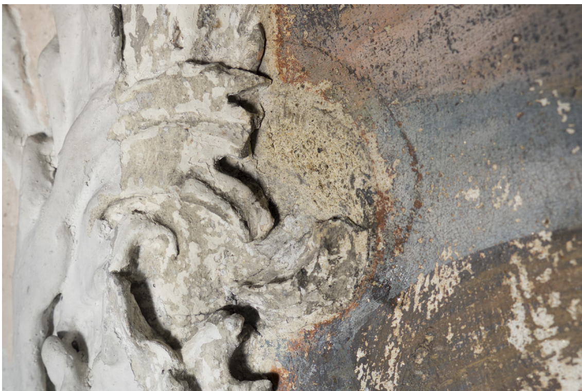
Obr. 55: Výjev na klenbě: štuková kartuš vlevo. Stav po očištění. Detail poškození: ztráta části štukového rámu štuk.
