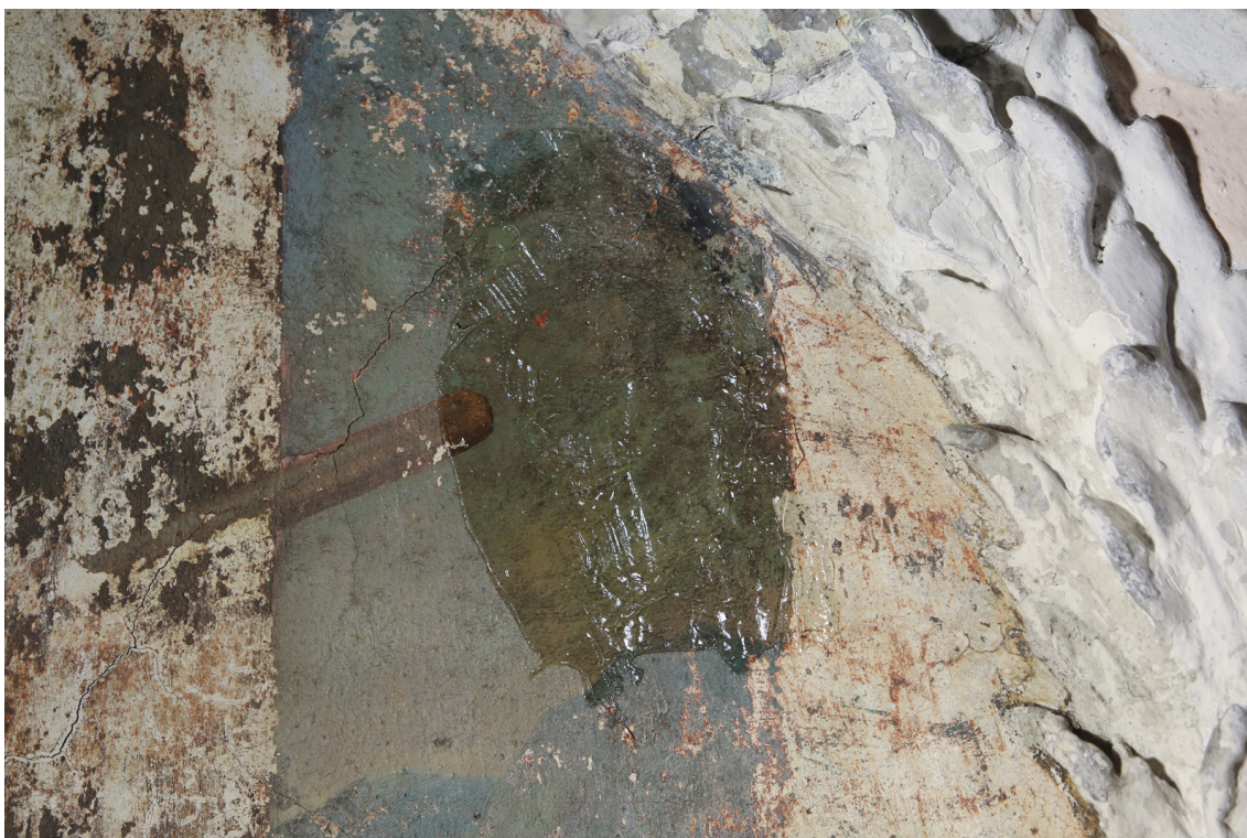
Obr.41: Výjev na klenbě: oblast oblohy v pravé části výjevu. Stav v průběhu čištění: nanášení carbopolového gelu.
