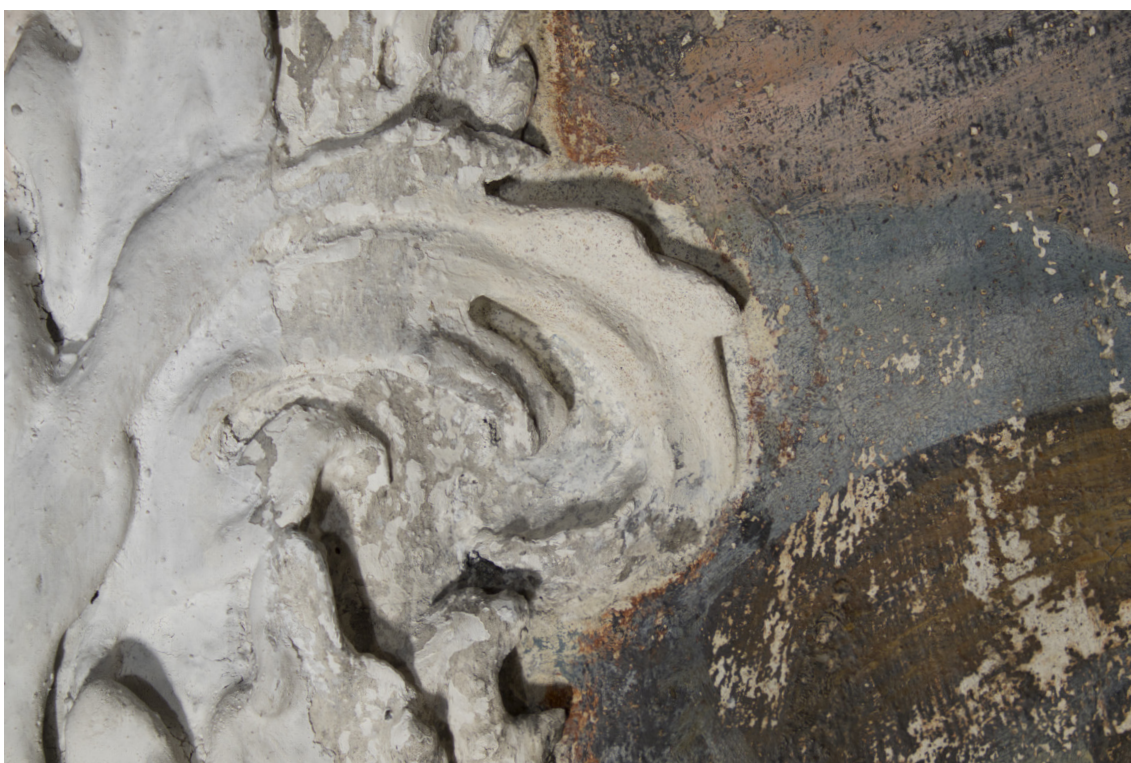
Obr. 56: Výjev na klenbě: štuková kartuš vlevo. Stav po dotmelení chybějící části štuk.
