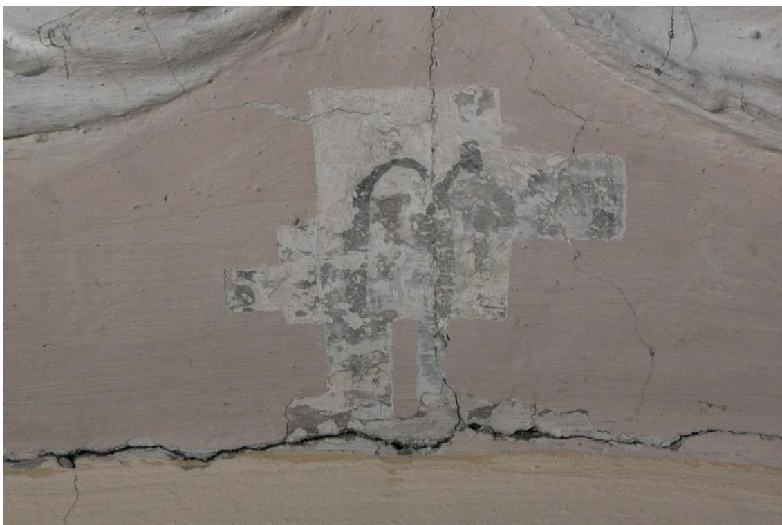
Obr.23: Sondážní průzkum. Sonda S1 odhalující zachovalou část nápisu na stěně pod středovou partií štukového zrcadla se svatováclavským výjevem..
