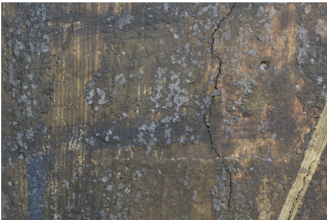
Obr. 26: Detail malby na klenbě: střední část výjevu (stěna stodoly). Stav před restaurováním. Detail poškození: biologické napadení.
