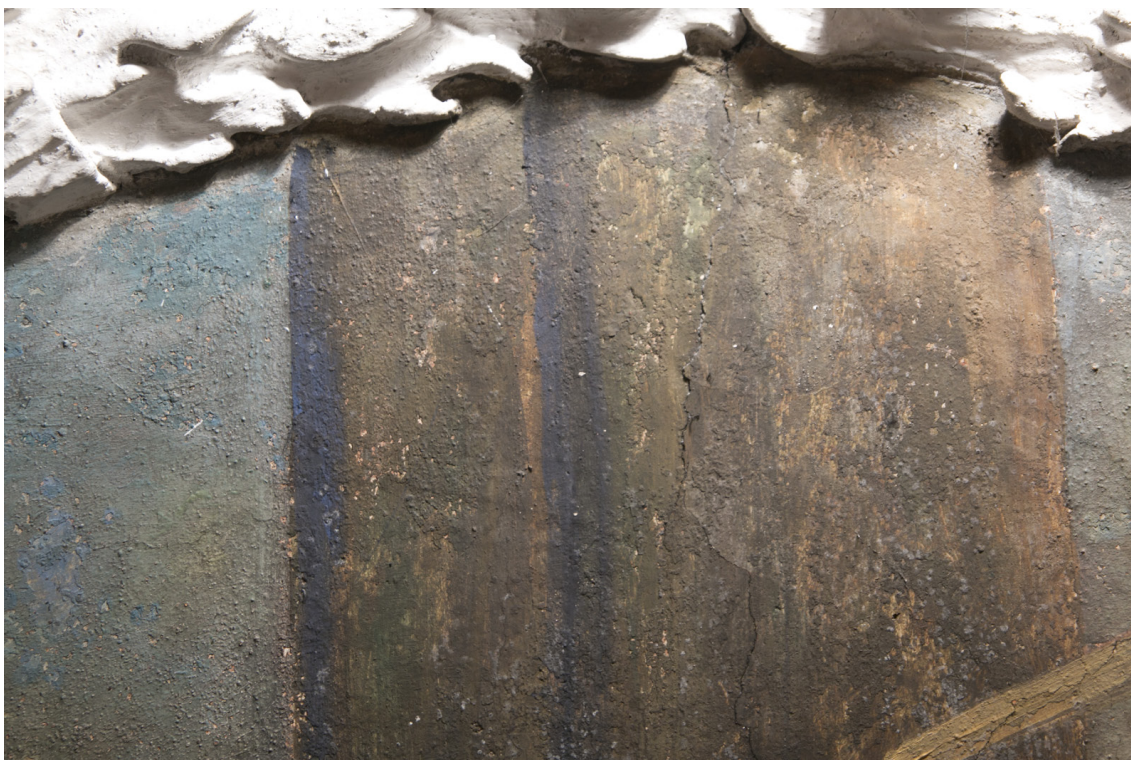
Obr.21: Průzkum v bočním nasvícení. Detail malby na klenbě v oblasti horní části výjevu. Stav před restaurováním. V místech větších ztrát původní barevné vrstvy jsou lépe čitelné ostrůvky originálu.
