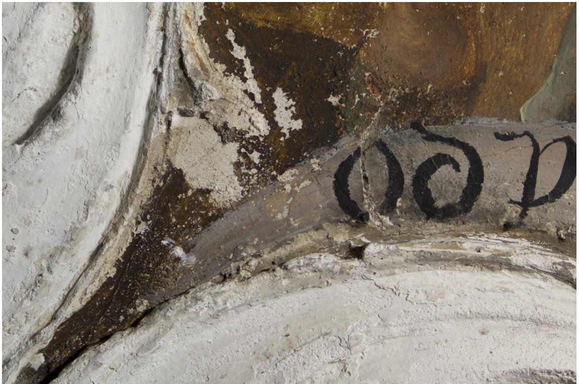
Obr. 30: Detail výjevu na vítězném oblouku: levý kraj nápisové stužky ve spodní části výjevu. Stav po očištění a sejmutí přemaleb. Detail poškození: ztráta barevné vrstvy a prasklina způsobující výškový rozdíl.
