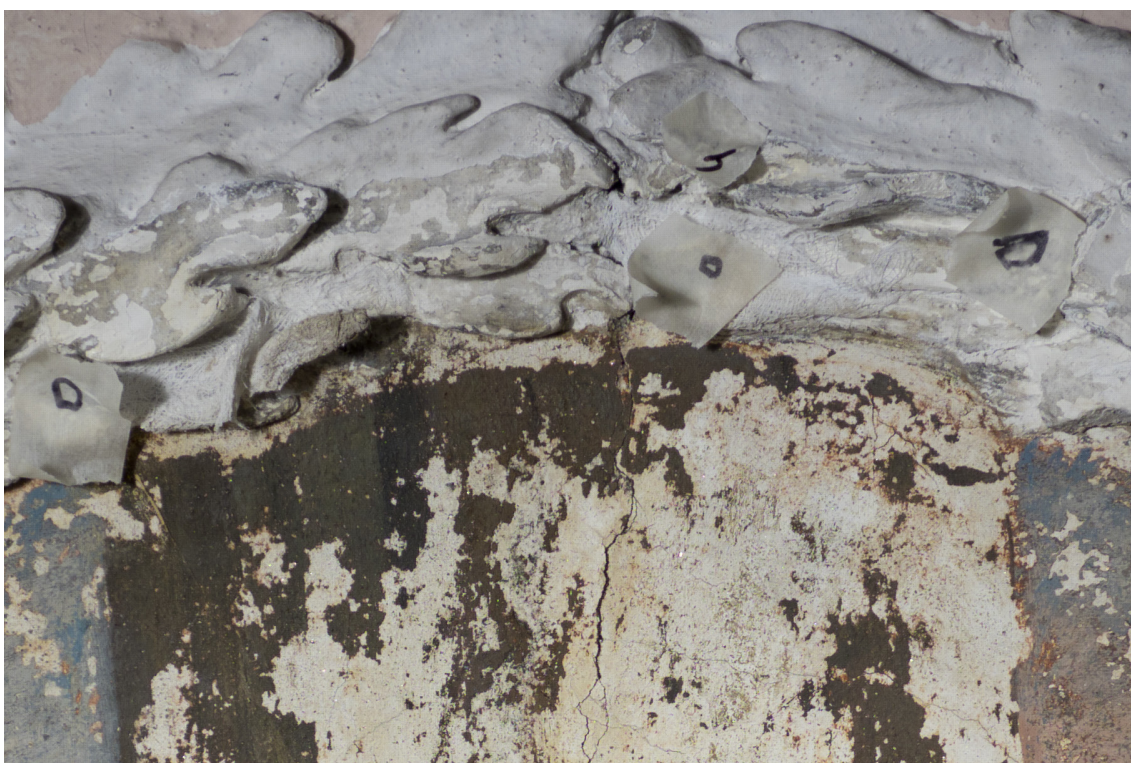
Obr.42: Horní část tukové kartuše okolo výjevu na klenbě. Zajištěné odpadávající části pomocí přelepů.
