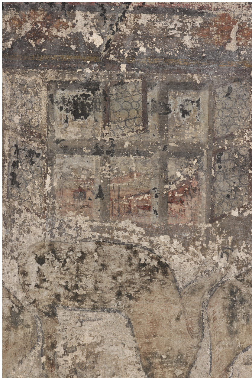
Obr. 14: Detail malovaného okna ve středové části jihovýchodní stěny – ztráta barevné vrstvy, znečištění sazemi.
