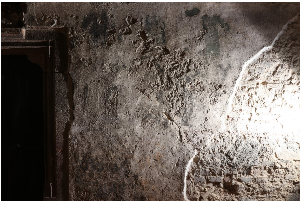
Obr. 18: Levá střední část jihovýchodní stěny – rozsáhlé ztráty omítkových vrstev. Ostré boční nasvícení.
