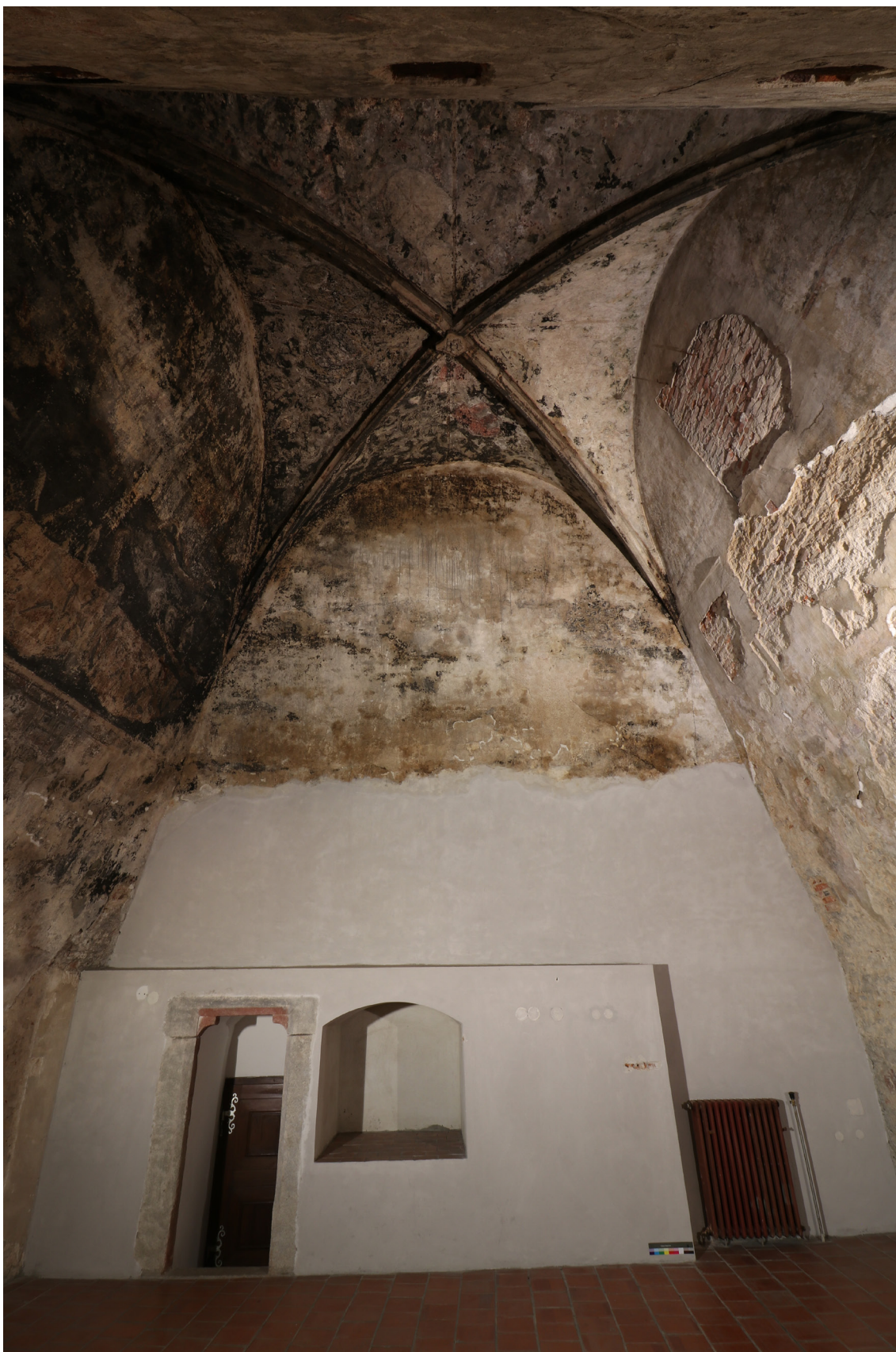
Obr. 41: Pohled na jihozápadní stěnu – umělé bílé světlo.
