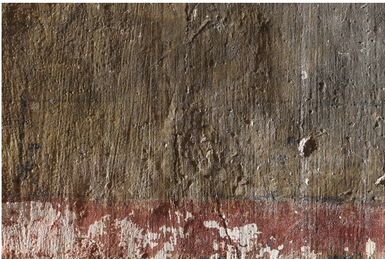
Obr. 20: Levá dolní část jihovýchodní stěny – zvlnění omítky.
