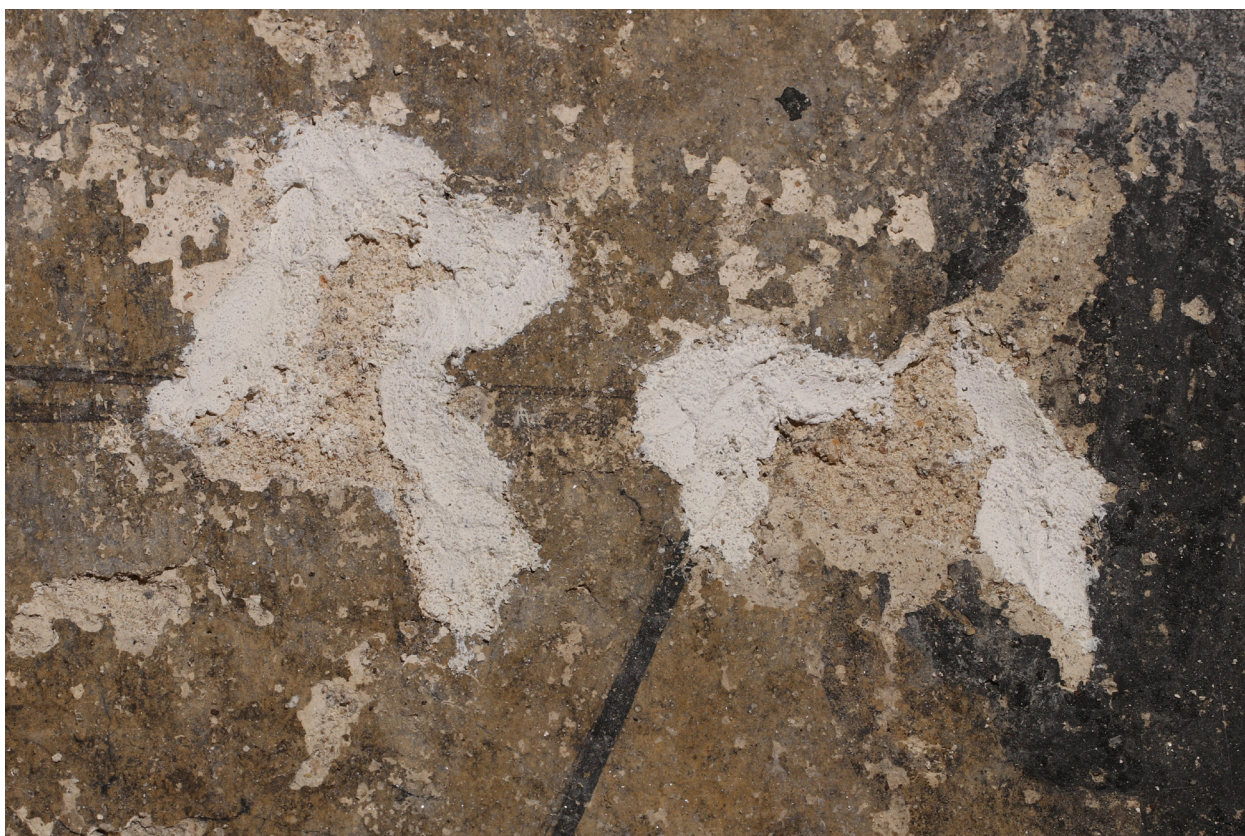
Obr. 08: Detail pravé dolní části jihovýchodní stěny – ztráta adheze omítkové vrstvy a její zajištění tmelem s nevhodnou barevností i povrchem.
