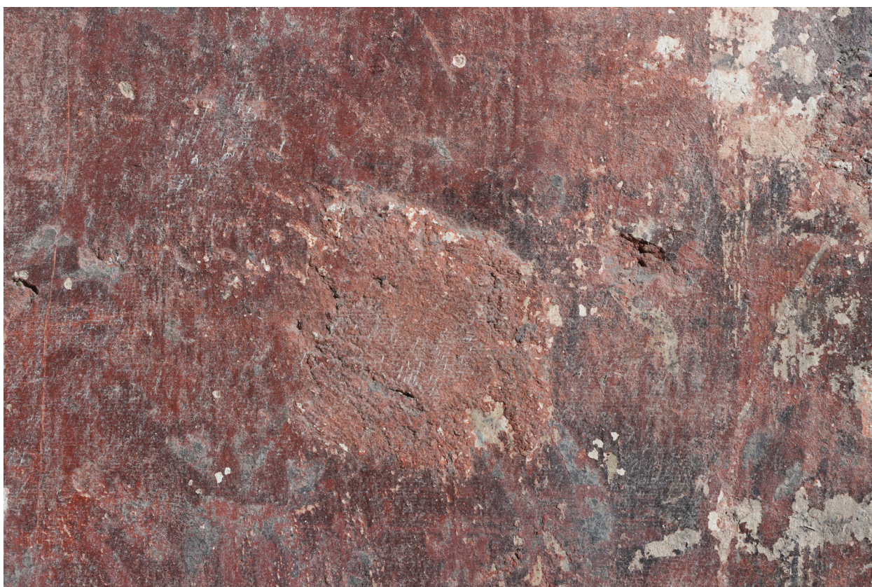
Obr. 12: Detail levé dolní části jihovýchodní stěny – stopy gázových přelepů.
