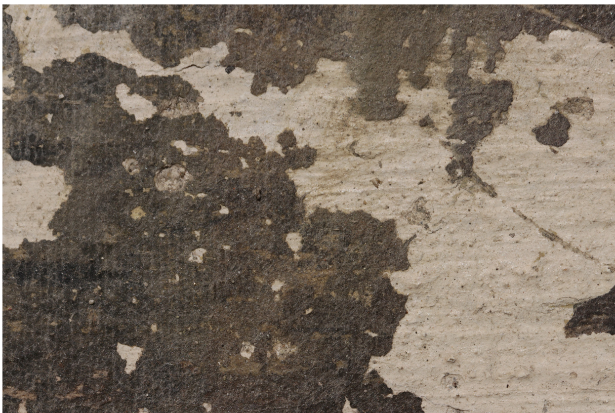
Obr. 16: Detail v pravé dolní části jihovýchodní stěny – ztráta adheze omítkové vrstvy.
