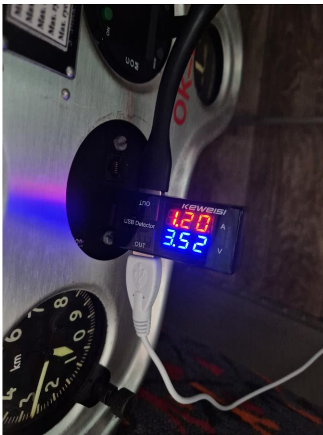
Obrázek 14: Fotografie se zaznamenanými skutečnými hodnotami odběru elektrického napětí a proudu 31
