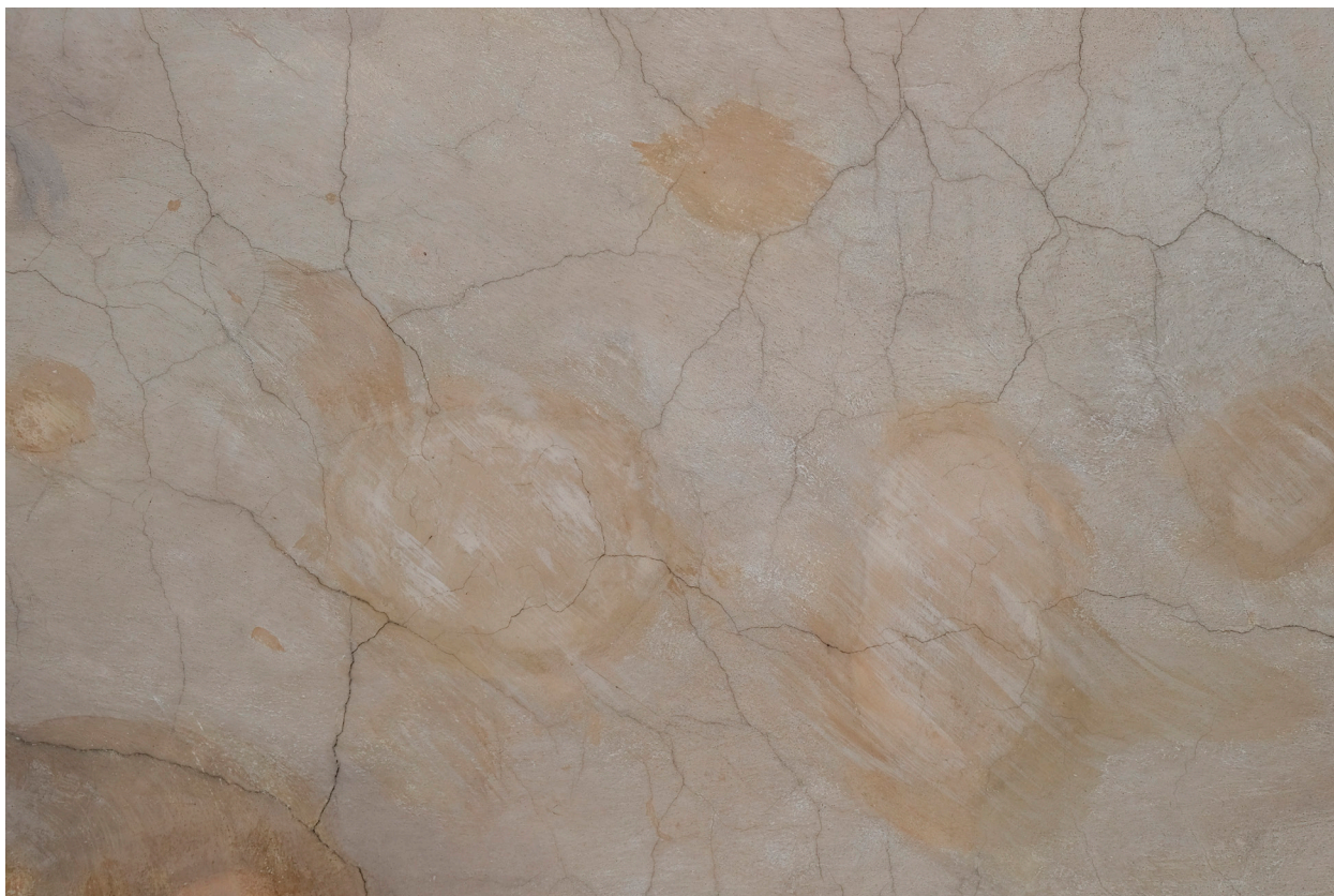
Obr. 47: Esteticky nevyhovující tmely a druhotná retuš společně s neaktivní trhlinou v oblasti oblohy v horní části výjevu. Na snímku jsou patrné také vlasové trhliny zvýrazněné zatečením fixážního prostředku a prachovými depozity.
