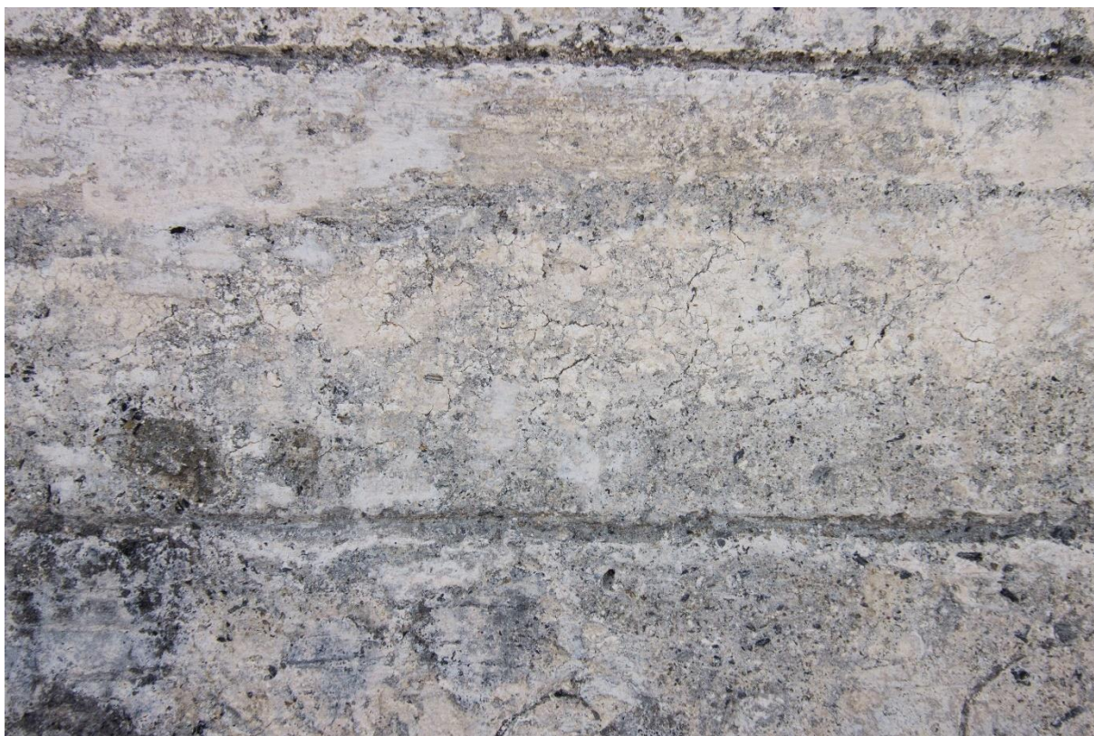
Obr. 21. V bílých vápenných vrstvách lze pozorovat primární praskliny. Na rozhraní výjevů č. 26 a 33 lze také pozorovat rozhraní denních dílů. Podle jejich překryvu lze říci, že byly nanášeny směrem dolů.
