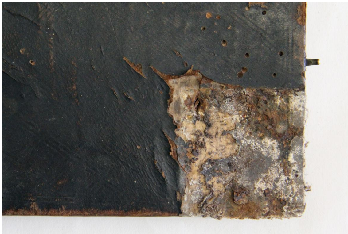
Obr. č. 59 – detail poškození pod dolní nárožnicí (přední deska) - stav před restaurátorským zásahem
