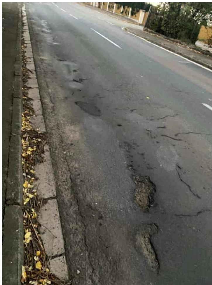
Obrázek 9 Poruchy vozovky v intravilánu obce
