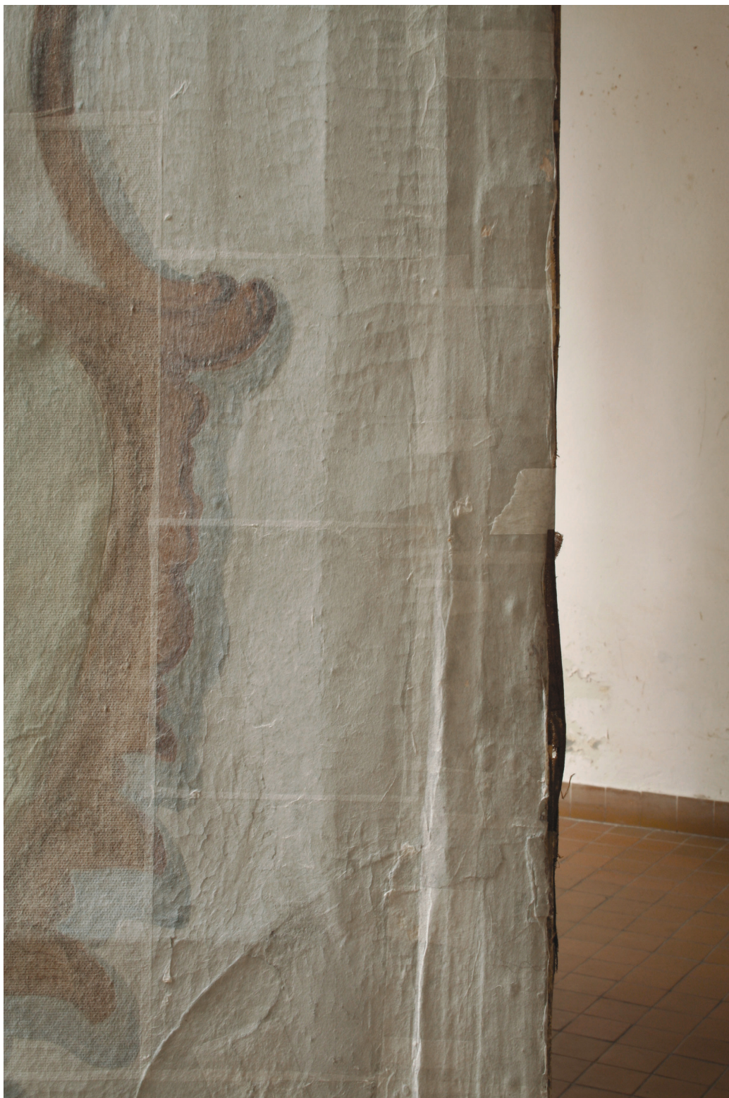
Obr.6 Stav před restaurováním – líc, pravá strana, detail poškození – krakeláž barevné vrstvy, podél okraje je patrná hrana křídélka.
