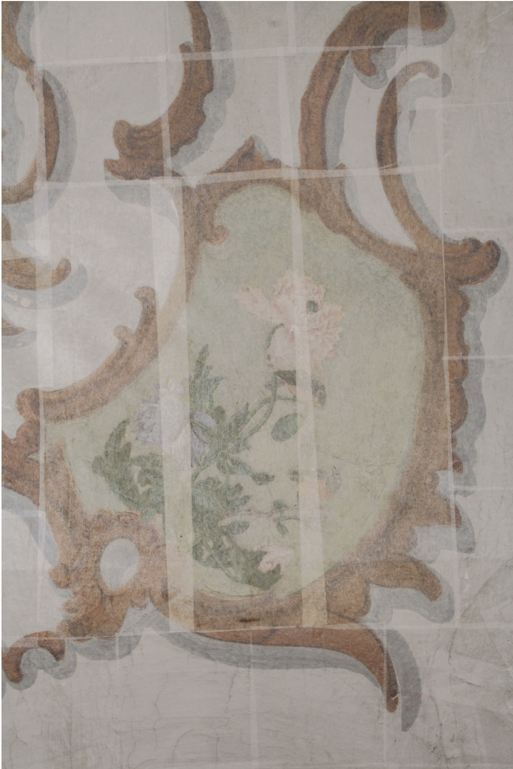
Obr.12 Stav před restaurováním – líc, detail přelepené malé papírové aplikace.
