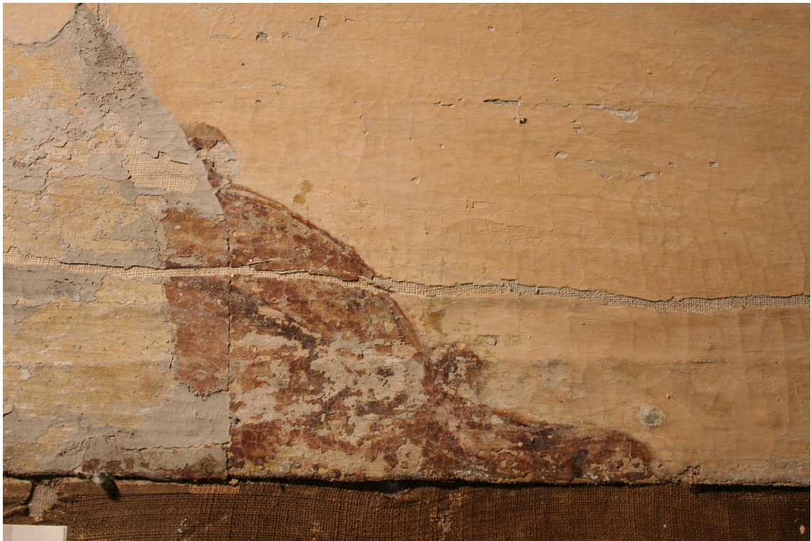
Obr.51 Detail poškození– průběh snímání přemalby.
