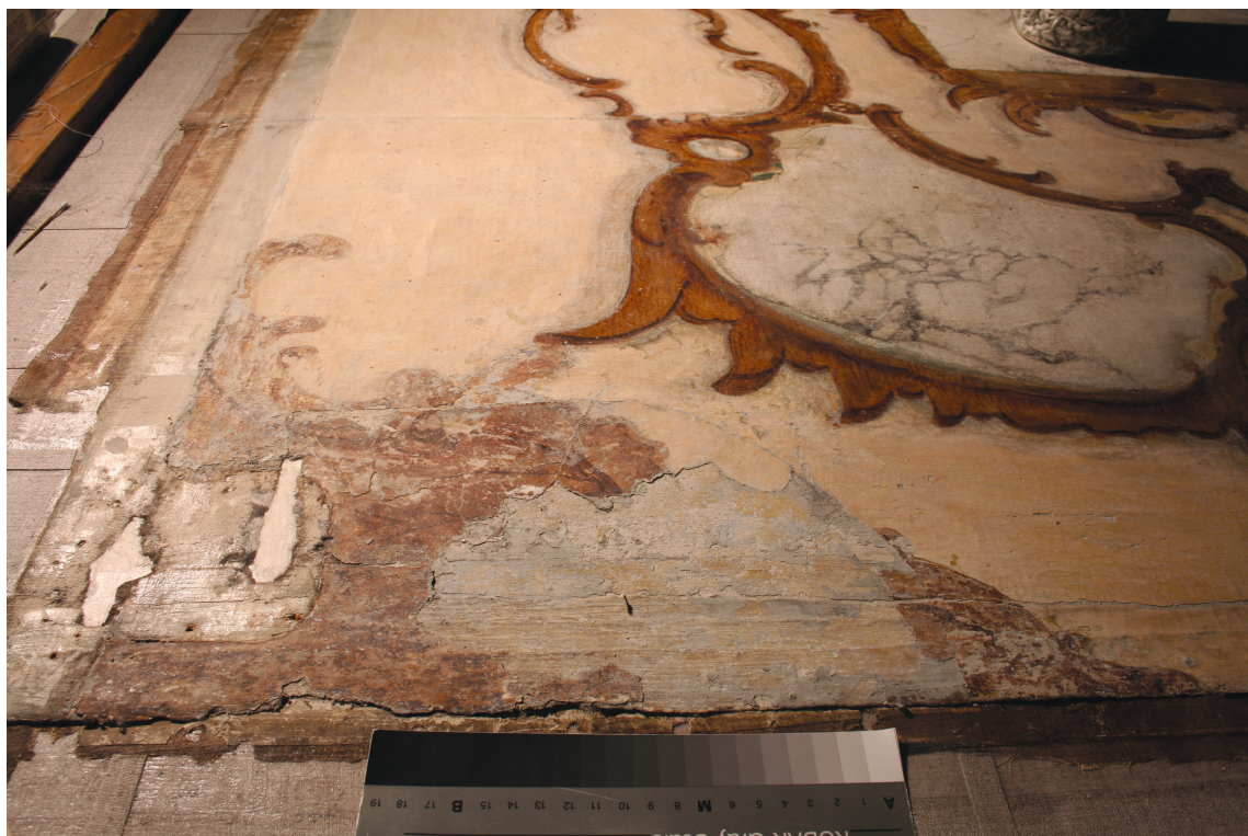
Obr.49 Pohled na odkrytou část dekorativní rozviliny přemalovanou v 60.letech.
