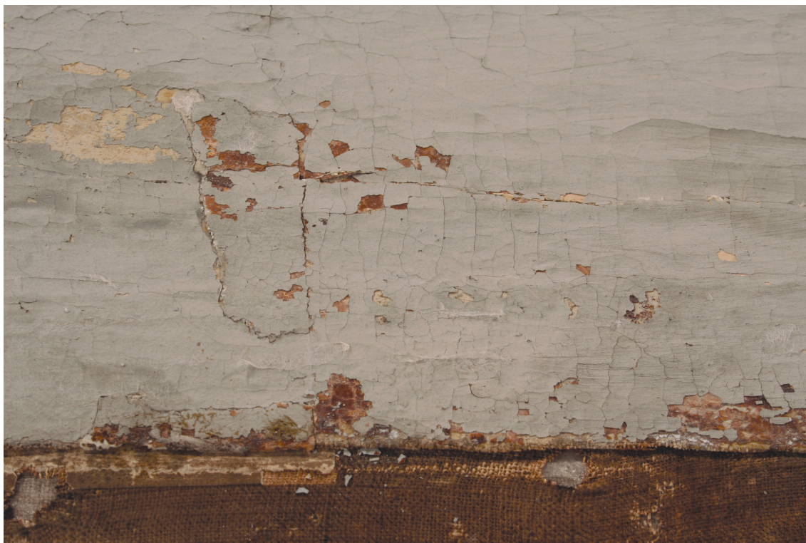
Obr.36 Detail poškození – krakeláž a odlupování se barevné vrstvy.
