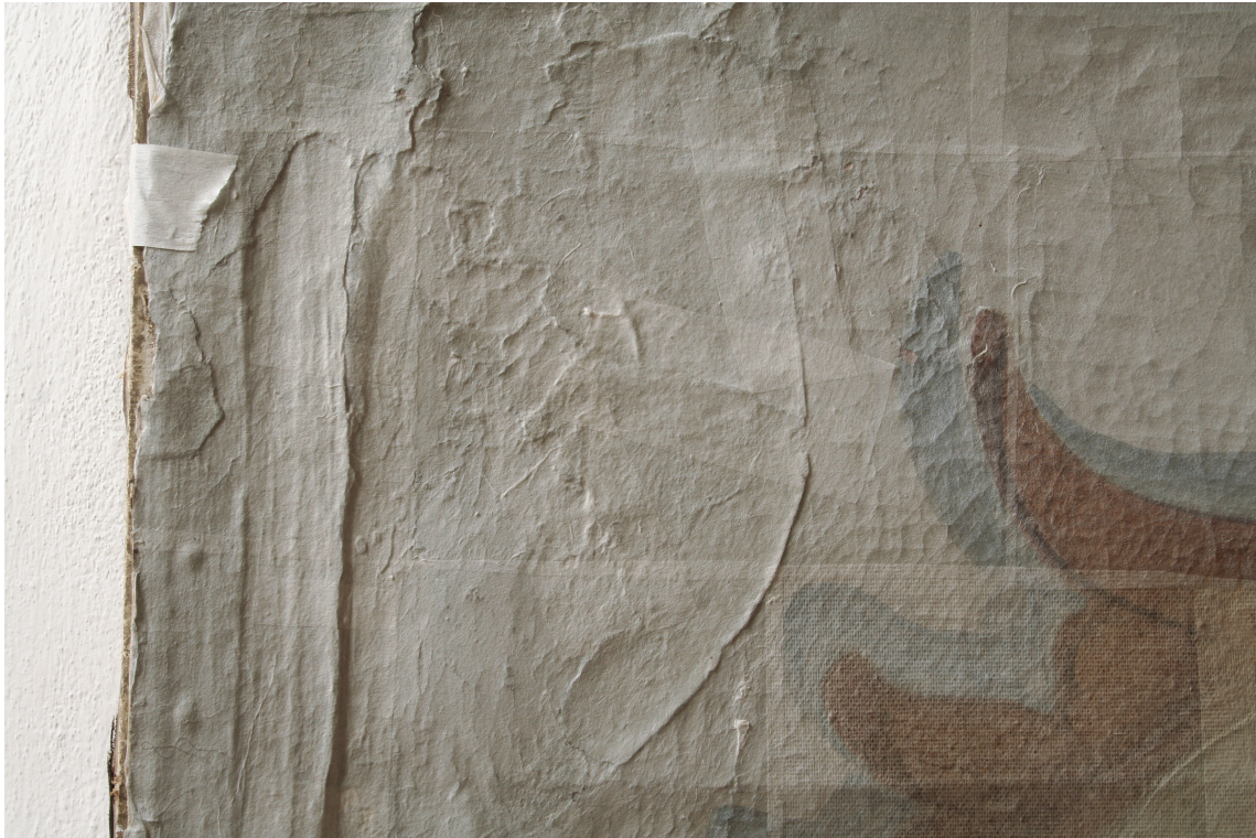
Obr.7 Stav před restaurováním – líc, detail poškození – krakeláž barevné vrstvy, křídélko, zpod křídélka reliéfně vystupuje kovový obvodový pás.
