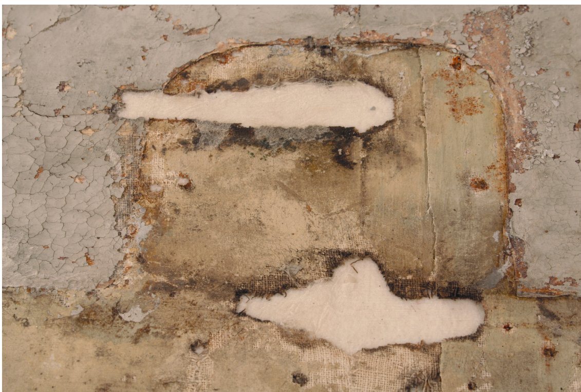
Obr.38 Detail poškození – otvory po zámku a klice, kde se zachovala původní barevná vrstva.
