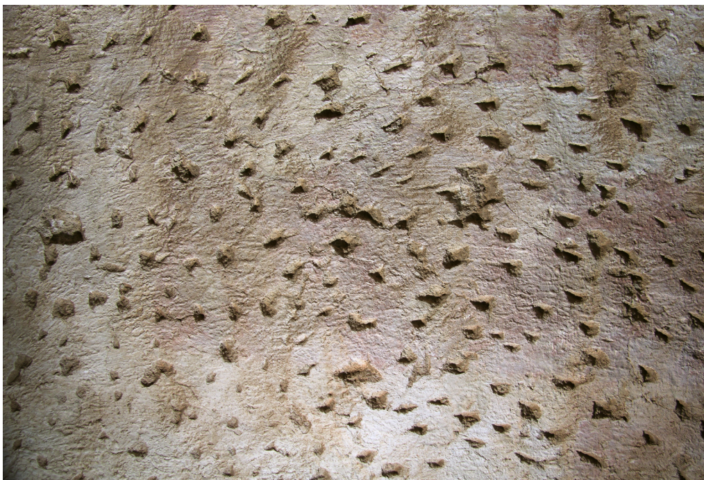
Obr. 12 Fragment malby na severní stěně lodi kostela, sv. Markéta, stav před restaurováním.
