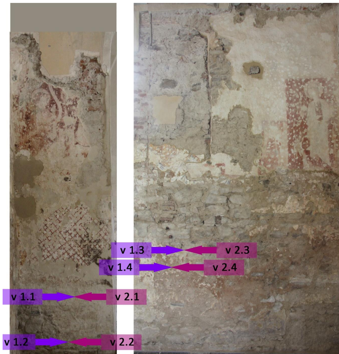
Obr. 65, 66 Východní a severní stěna hlavní lodi kostela (detail), grafický zákres míst odběrů vzorků odsolovacích zábalů o velikosti 10 × 10 cm.
