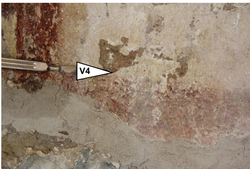
Obr. 74 Severní stěna hlavní lodi kostela, vzorek V4, detail.
