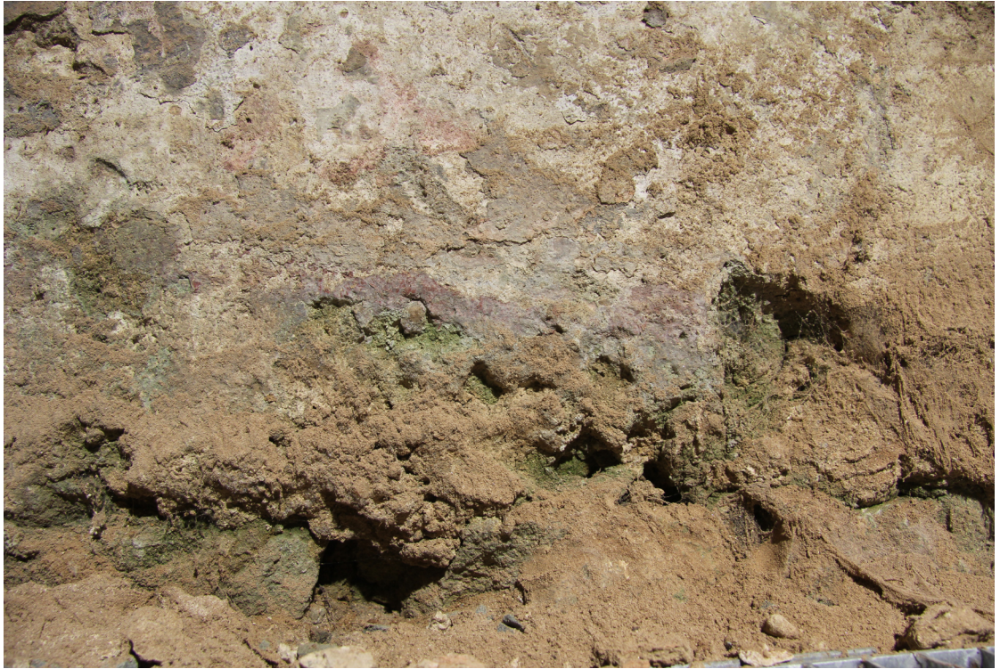
Obr. 24 Dolní část severní stěny, biologické napadení plenty a omítkových vrstev, stav před restaurováním.
