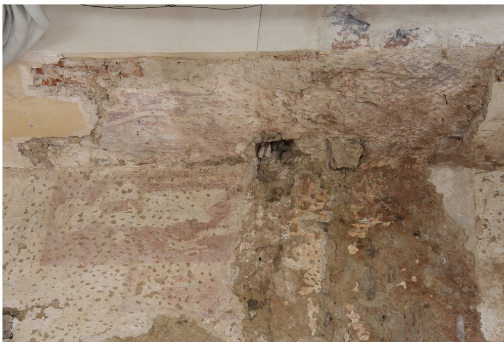
Obr. 30 Severní stěna a pravé rameno vítězného oblouku, figurální část (detail), stav po očištění.
