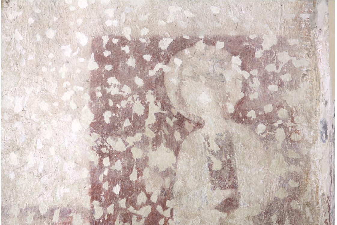
Obr. 39 Severní stěna, postava sv. Markéty (detail), stav po vytmelení.
