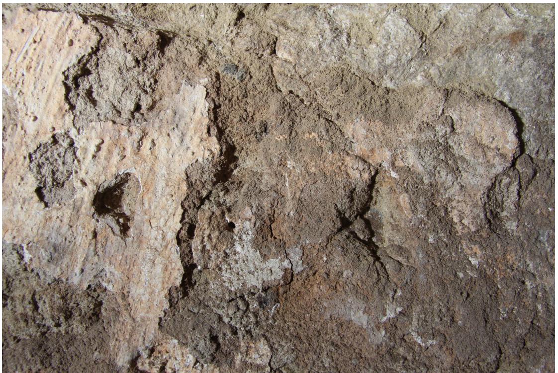
Obr. 19 Severní stěna (detail), fragment gotické omítky, mechanické poškození (pekování) a ztráta adheze barevných vrstev, stav před restaurováním.
