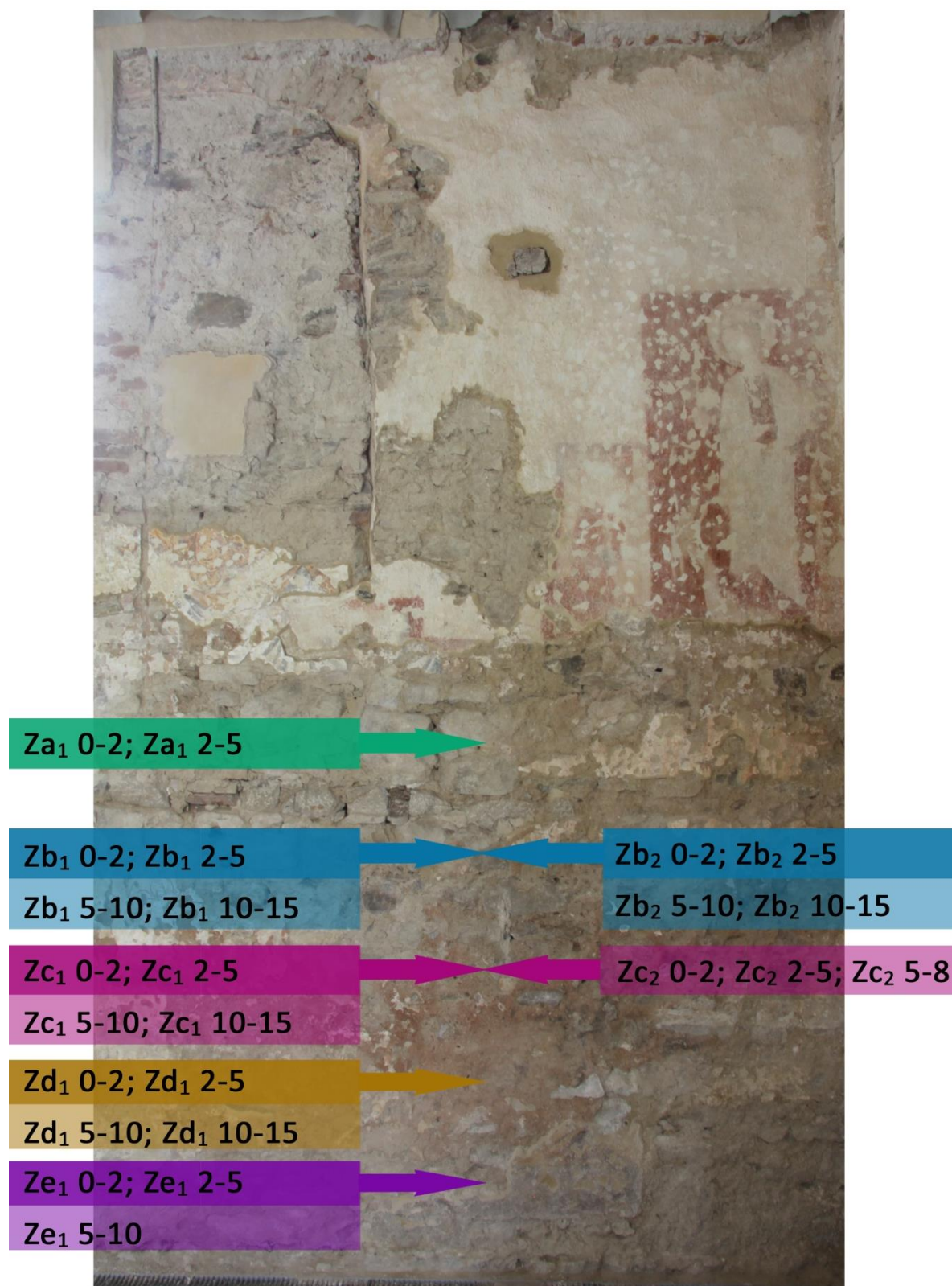
Obr. 64 Severní stěna hlavní lodi kostela, grafický zákres míst odběrů vzorků vrtné moučky určených ke stanovení množství vodorozpustných solí, případně vlhkosti.
