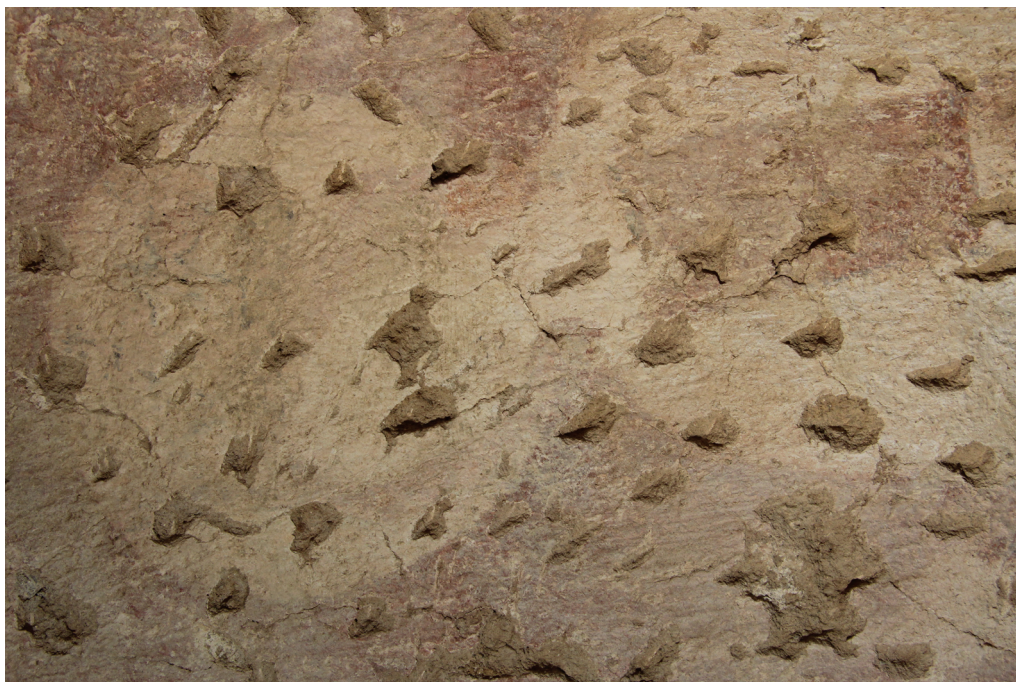
Obr. 22 Severní stěna, stav před restaurováním.
