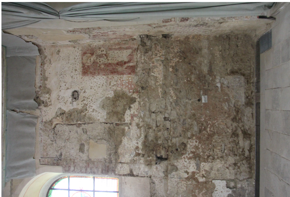
Obr. 27 Severní stěna, celkový pohled, stav po očištění. Sytá barevnost je dána přítomností zbytkové vlhkosti po čištění.
