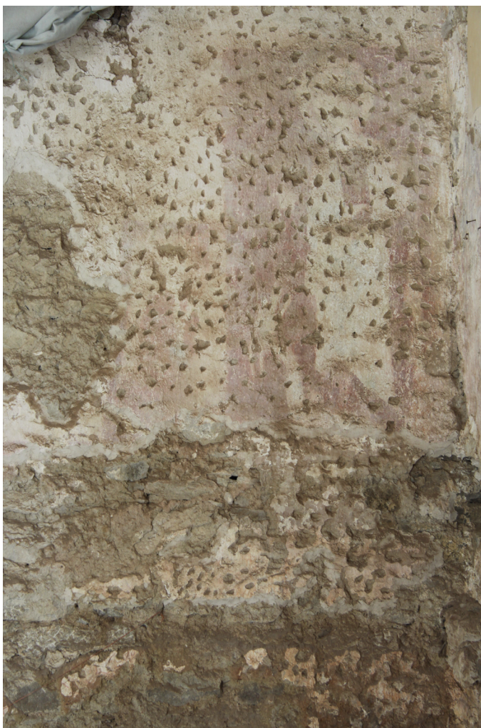
Obr. 10 Fragmenty maleb na severní stěně lodi kostela při vítězném oblouku, stav před restaurováním.
