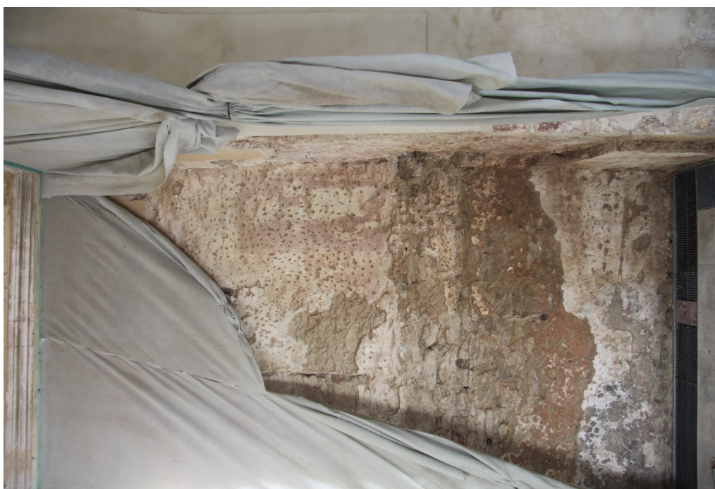
Obr. 9 Severní stěna kostela při levé stěně vítězného oblouku, stav před restaurováním.
