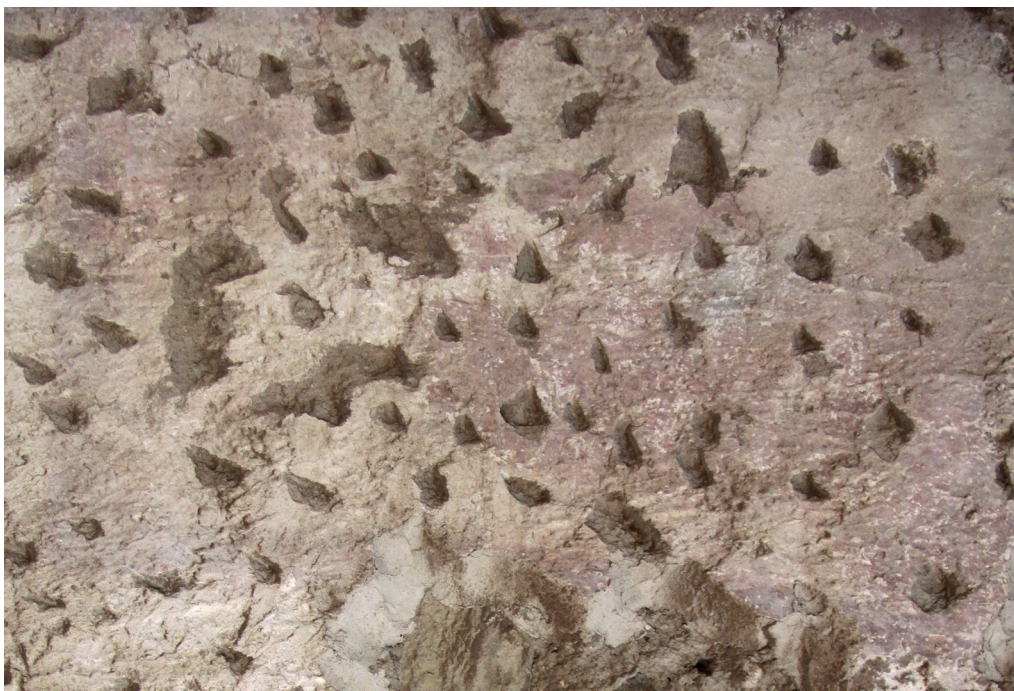
Obr. 14 Severní stěna (detail), postava kléčícího oranta, stav před restaurováním.
