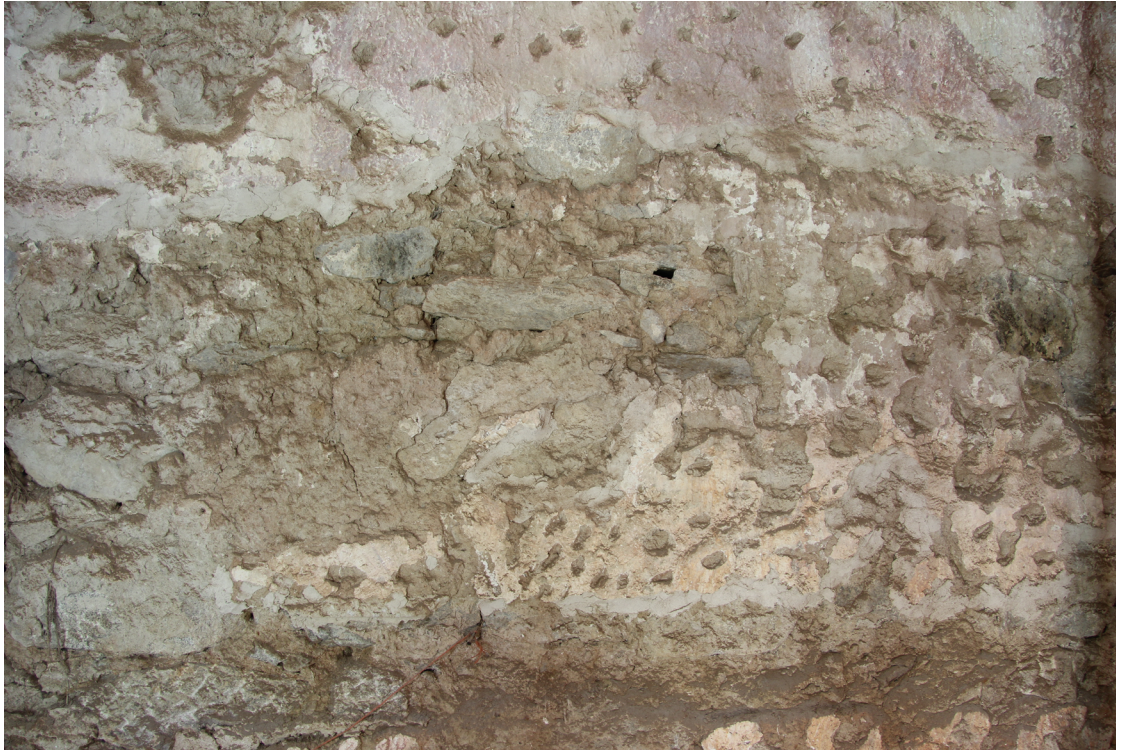
Obr. 20 Severní stěna (detail), fragment gotické omítky, stav před restaurováním.
