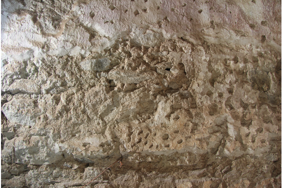
Obr. 21 Severní stěna (detail), fragment gotické omítky, razantní boční osvětlení. Zvýraznění mechanického poškození (pekování) a prasklin v bočním osvětlení. Stav před restaurováním.
