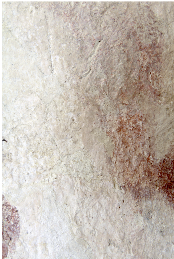
Obr. 44 Severní stěna, postava sv. Markéty (detail krku svěťice), stav po restaurování.
