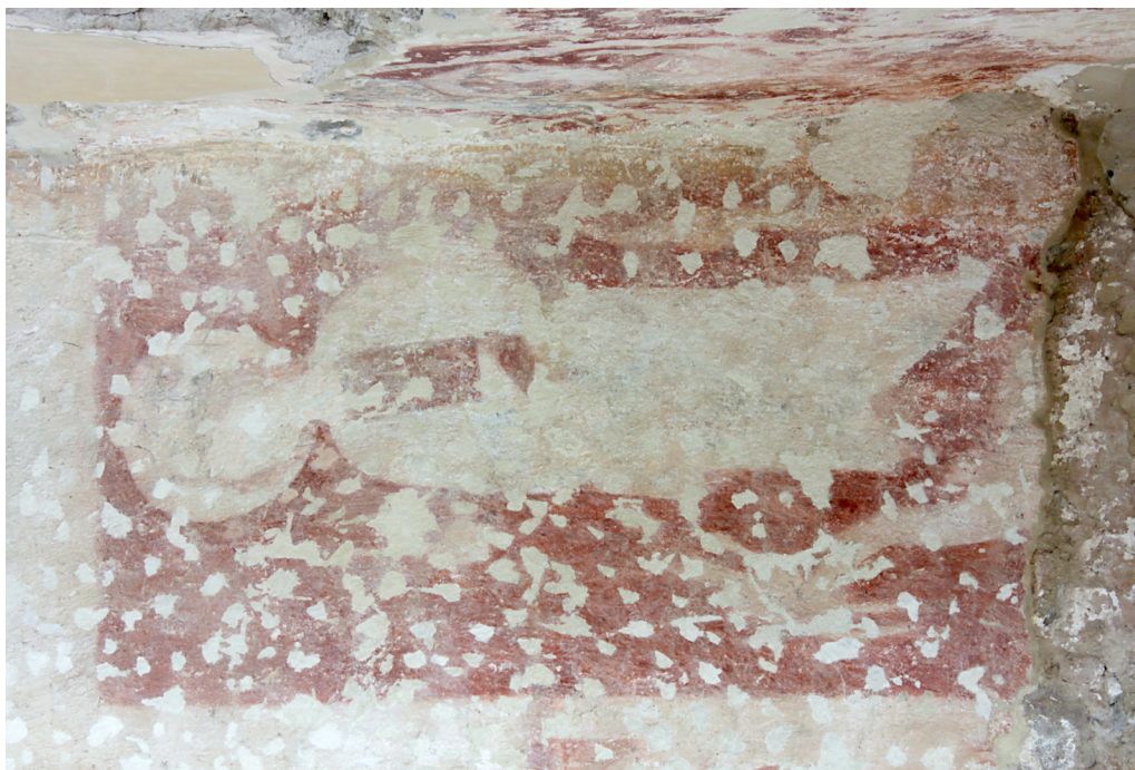
Obr. 35 Severní stěna, postava sv. Markéty, stav po tmelení.
