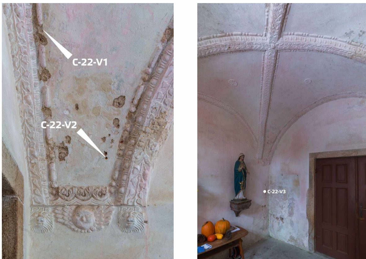
Obr. 64 Dešná, kostel sv. Jana Křtitele, předsíň, strukturální poškození omítky a štukových dekorací. V místech největších defektů byl proveden odběr vzorků pro optickou mikroskopii C-22-V1 a stanovení obsahu vodorozpustných solí C-22-V2, C-22-V3. Kostel sv. Jana Křtitele, předsíň, východní stěna, foto: Vojtěch Krajíček.
