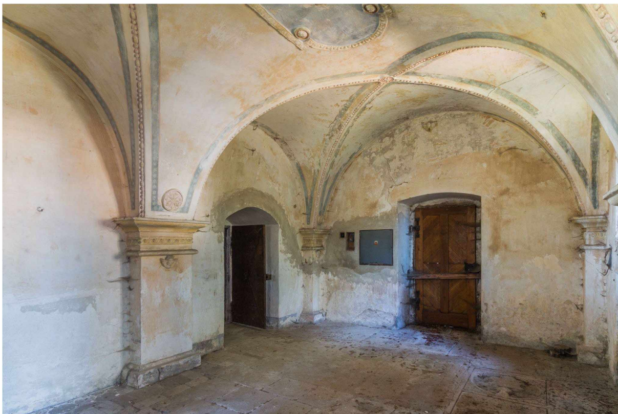
Obr. 39 Jindřichův Hradec, kostel Nejsvětější Trojice, necitlivé druhotné zásahy v okolí elektroinstalace, přemalby a rozsáhlá poškození povrchových vrstev, foto: Vojtěch Krajíček.
