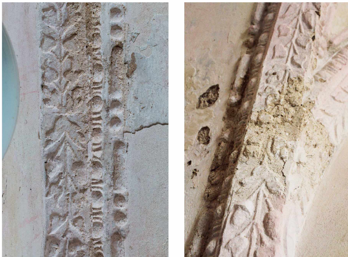
Obr. 65 Dešná, kostel sv. Jana Křtitele, předsíň, detail poškození povrchu štukového ornamentu způsobené zatékáním a působením vodorozpustných solí, foto: Vojtěch Krajíček, Zdeněk Kovářík.
