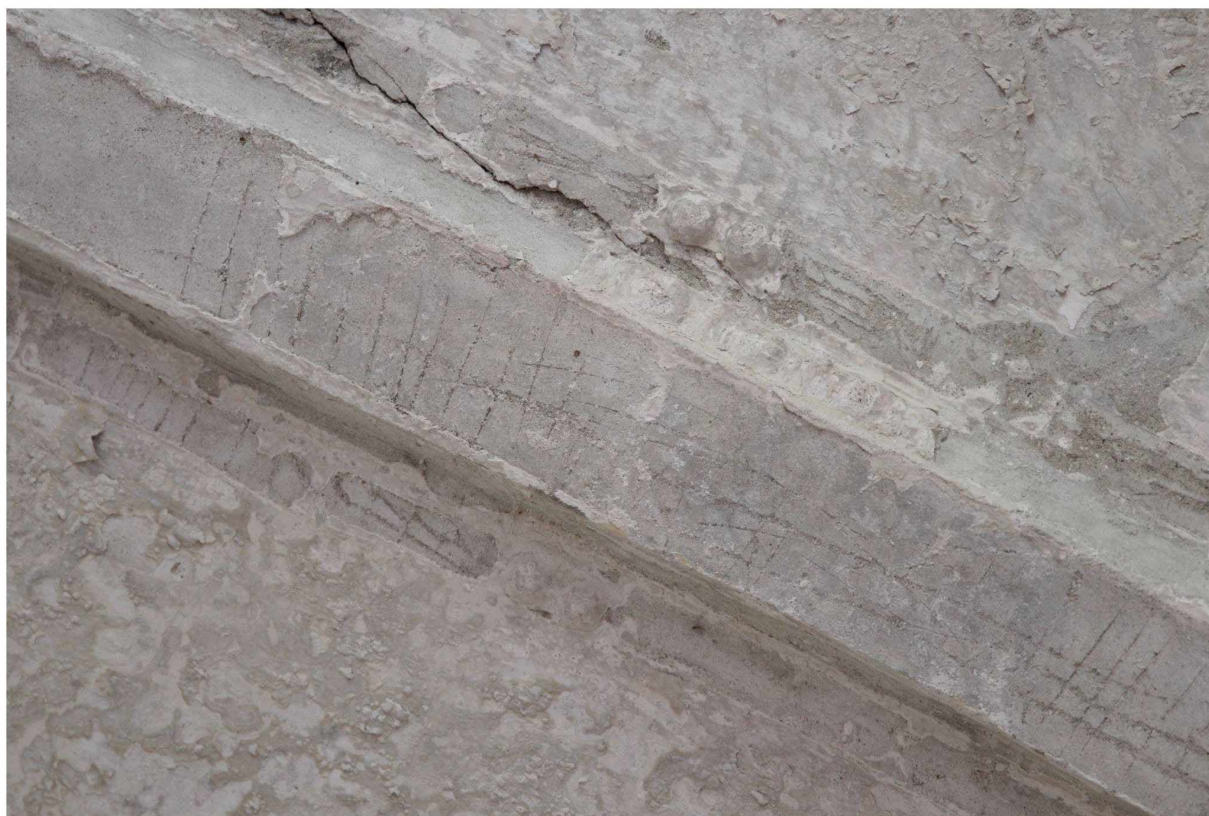
Obr. 10 Zámek Uherčice, místnost č. 221, předvytažený štukový rám, defekt po odpadnutí pásového ornamentu a části perlovce, patrné přípravné škrábání povrchu pro lepší přilnutí ornamentu, foto: Zdeněk Kovářík.
