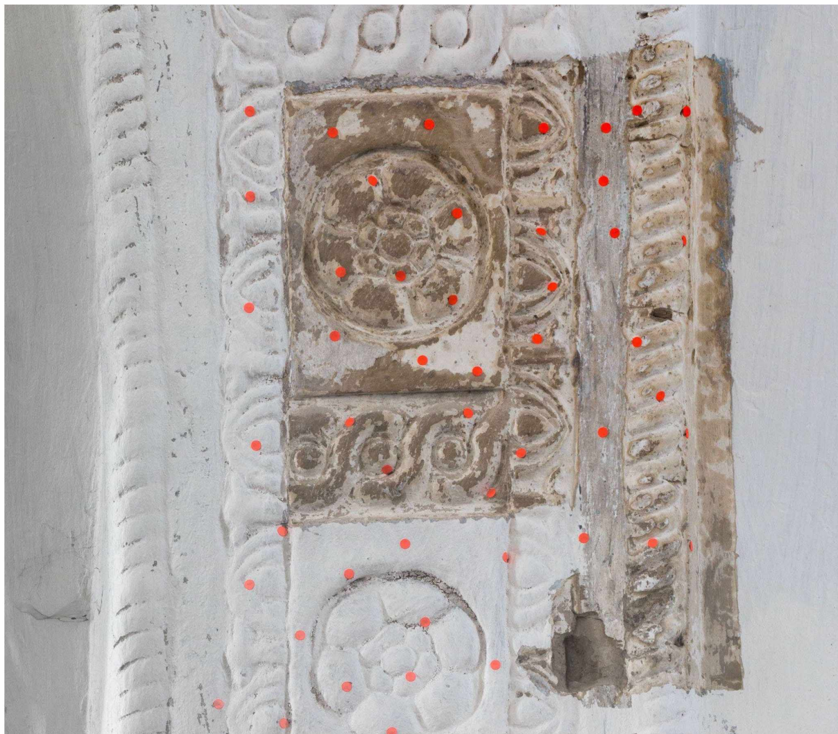
Obr. 11 Kostel sv. Michaela, Polička, identifikace armatur (kovových hřebíčků) pomocí detektoru kovu, foto: Vojtěch Krajíček.
