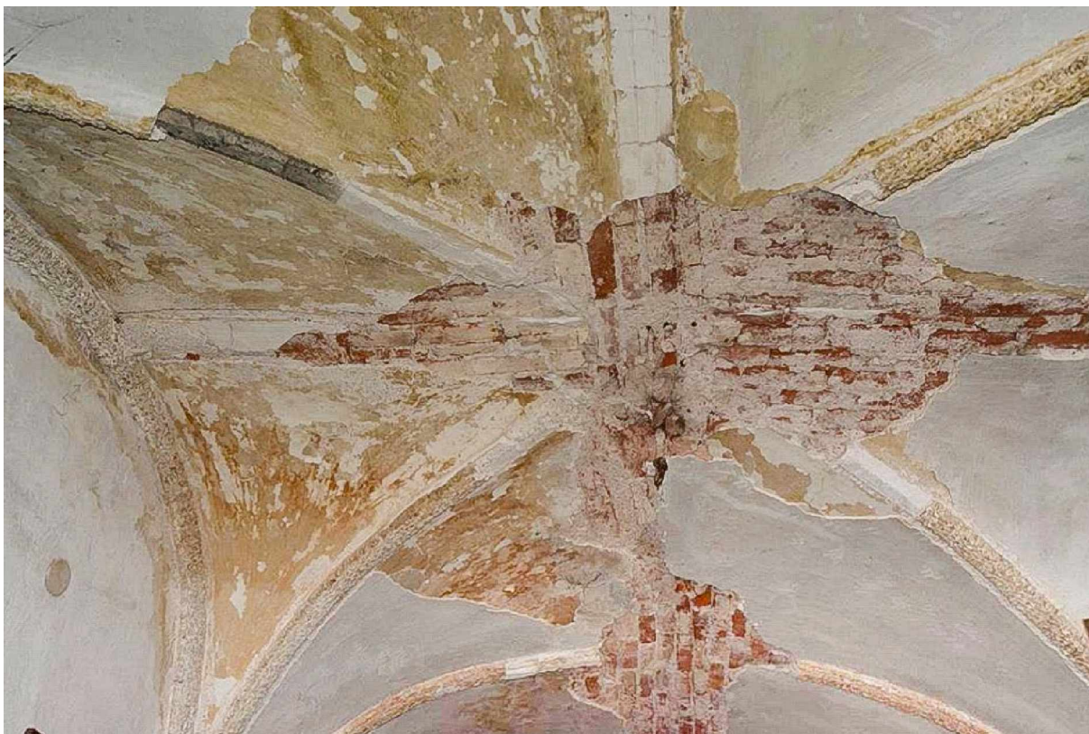
Obr. 18 Moravská Třebová, dům čp. 146, poškození klenby, stav před restaurováním v roce 2014, foto: Zdeněk Šmahel.
