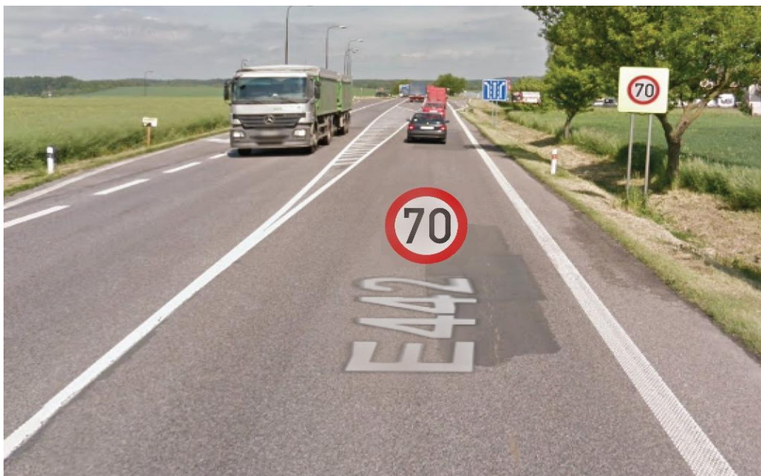
Obrázek 19 Vodorovné dopravní značení omezující dovolenou rychlost.
