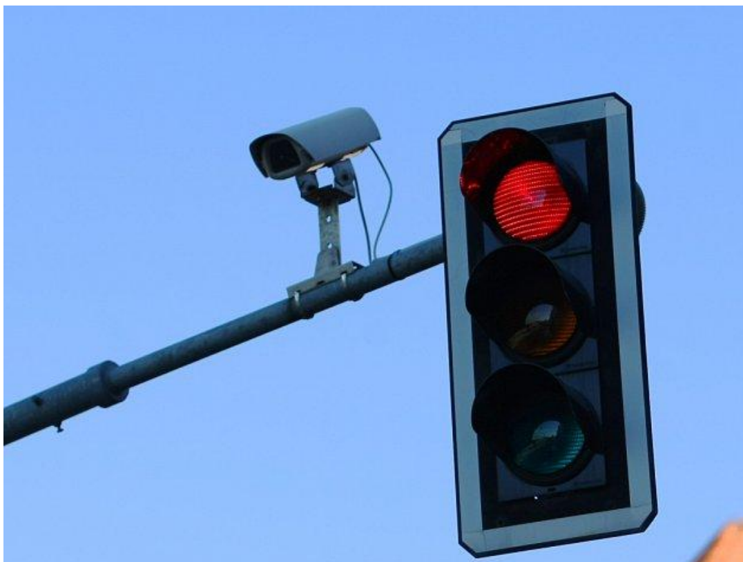
Obrázek 21 Světelné signalizační zařízení
