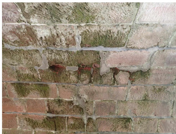
Foto č. 2 - K 01, Degradace v místě trhlín 1,52 m a 1,9 m zleva nad O01.
