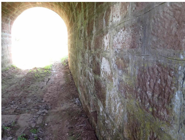
Foto č. 5 - O 01, 4,7 - 6,46 m zleva boulení opěry až o 50 mm.
