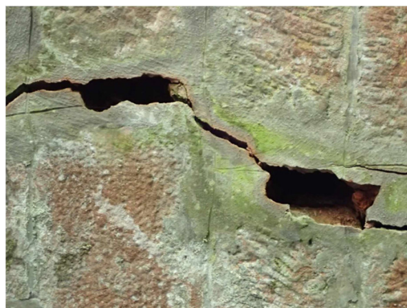
Foto č. 2 - K 01, vrchol 1,83 m zleva, detail degradace a rozevření trhliny..
