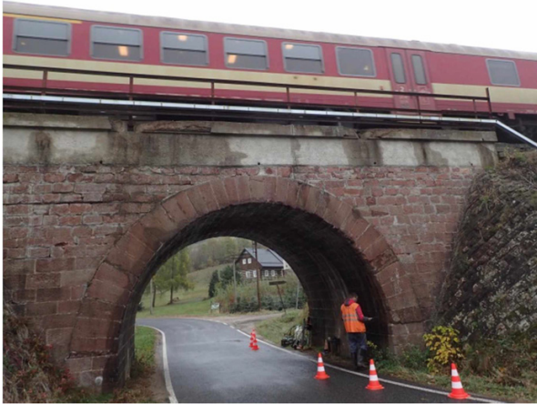
Foto č. 3 - K 01, římsový nosník vlevo, silné průsaky vody v místě trhlin.
