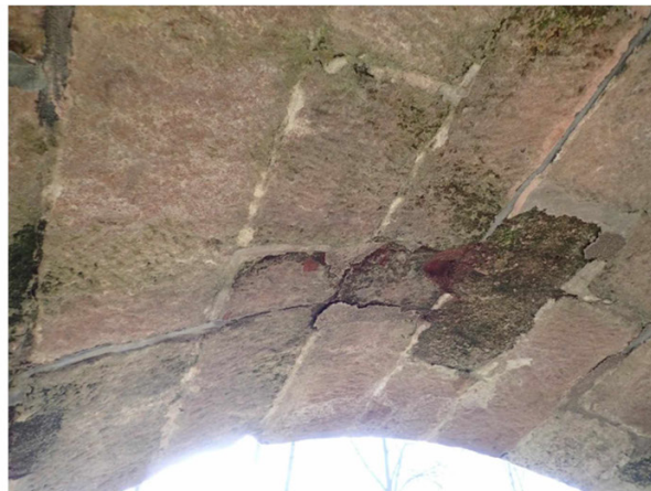
Foto č. 4 - K 01, Vrchol 0,55 m zprava, podélná trhlina, degradace do 60 mm.
