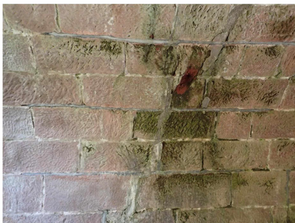
Foto č. 1 - K 01, Trhlina ve vzdálenosti 1,52 m zleva směrem nad O02.
