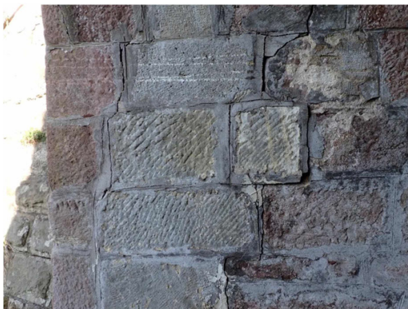
Foto č. 9 - O 02, 1,08 m zleva trhlina a výsun kvádrů
