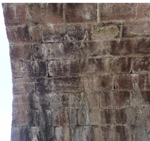
Foto č. 1 - K 01, Trhlina ve vzdálenosti 0,6 m zleva směrem nad O02.
