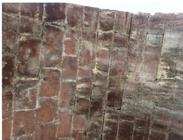
Foto č. 2 - K 01, Trhlina ve vzdálenosti 0,6 m zleva, vrchol.
