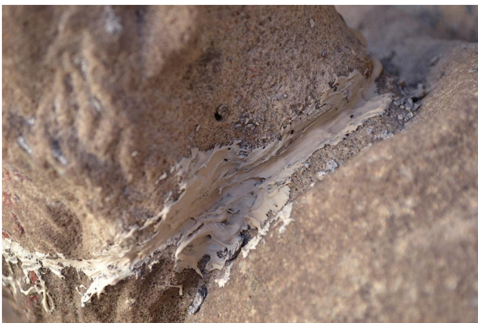
Obr. 4. 11 Detail poškození – znečištění lepicí směsí spoje hlavy sv. Františka
