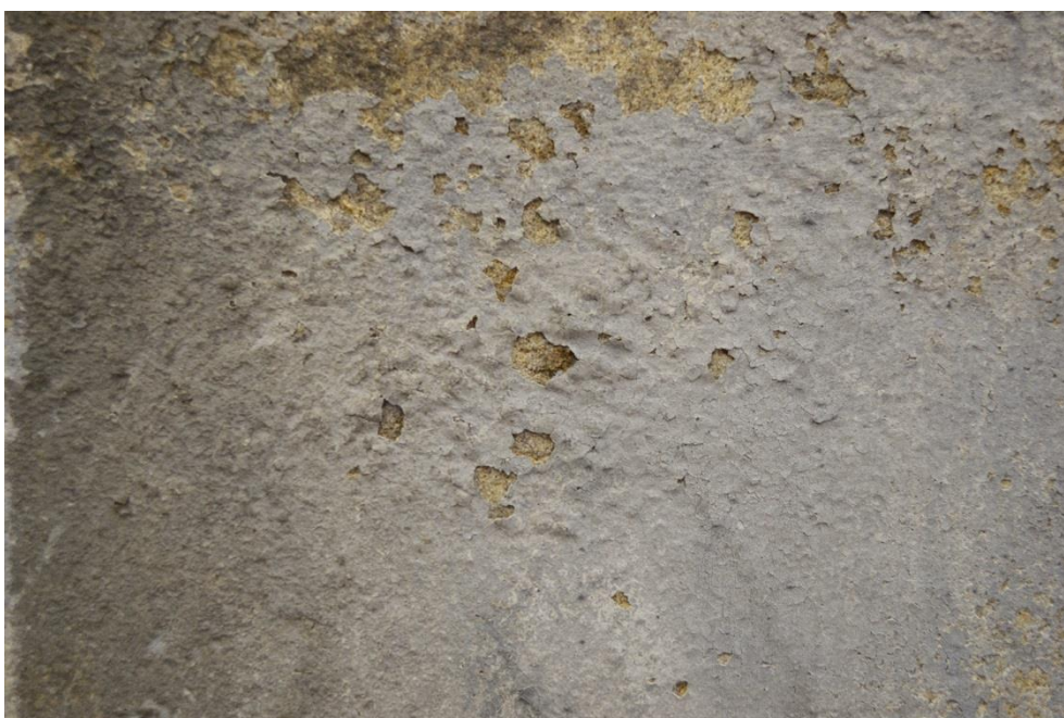
Obr. 4. 9 Detail poškození – oddělující se barevná vrstva
