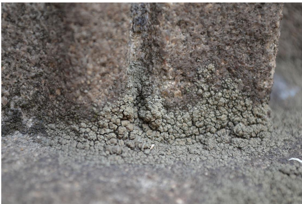
Obr. 4. 8 Detail poškození – biologického napadení
