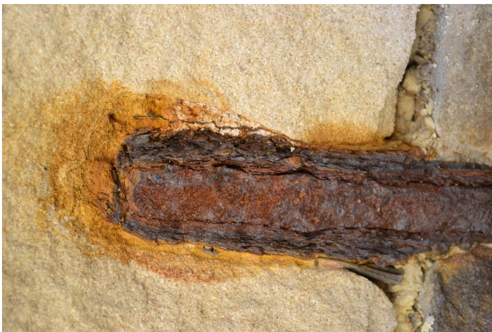
Obr. 4. 12 Detail poškození – koroze čepu
