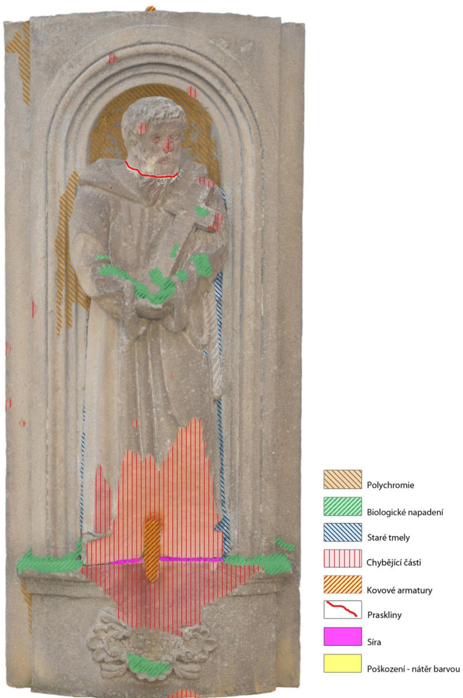
Obr. 4. 35 Zákresy poškození - přední strana
