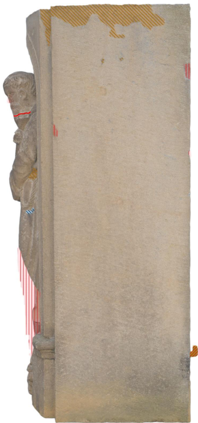
Obr. 4. 38 Zákresy poškození - pravá strana
