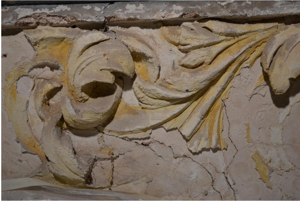
Obr. 2. 4 Detail poškození - síť prasklin v pozadí vlysu
