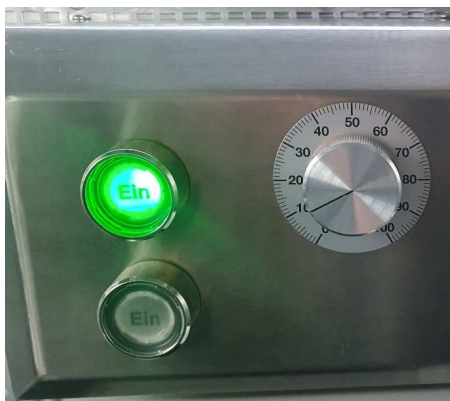
Obr. 19 Ovládací panel vytápění a chlazení vnitřních prostor
