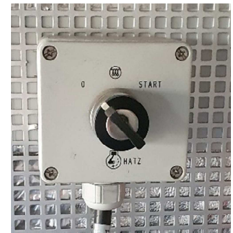
Obr. 16 Přepínač pro start nouzového agregátu
