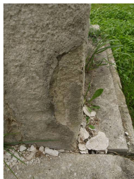
Obr. 126 Tmely odpadlé od hmoty kamene (sokl)
