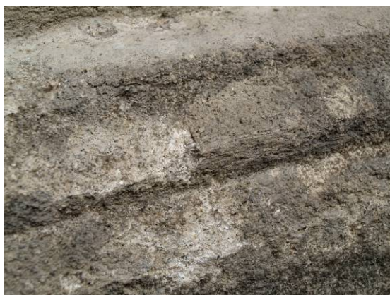
Obr. 118 Místo po odpadlém tmelu (profilovaný sokl)
