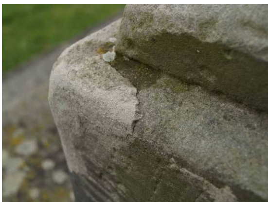
Obr. 100 Detail vymytý okraj tmelu
