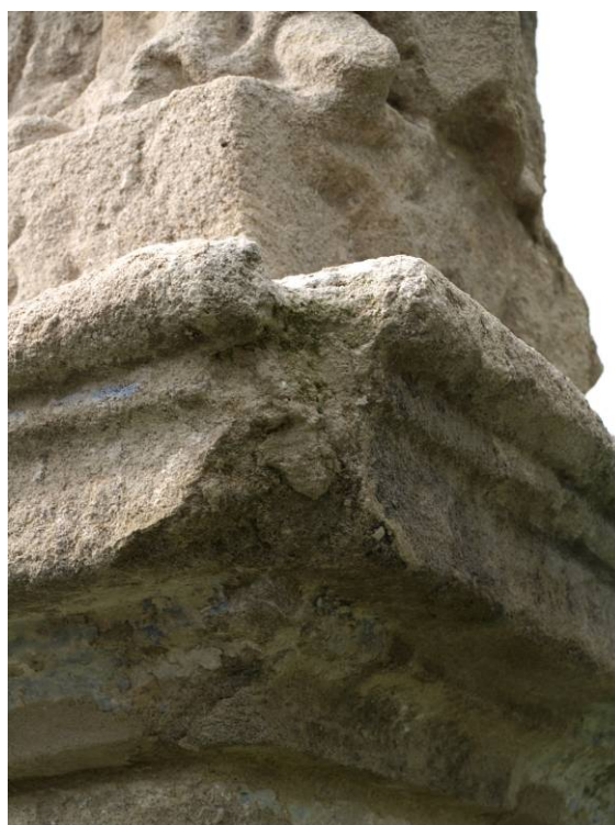
Obr. 124 Detail roh hlavice upadlý tmel
