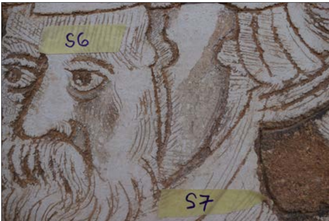
Sondy 6 a 7 - sondy na původní povrch renesanční omítky s dochovaným původním bíancem. Výjevy A4 a A5.
