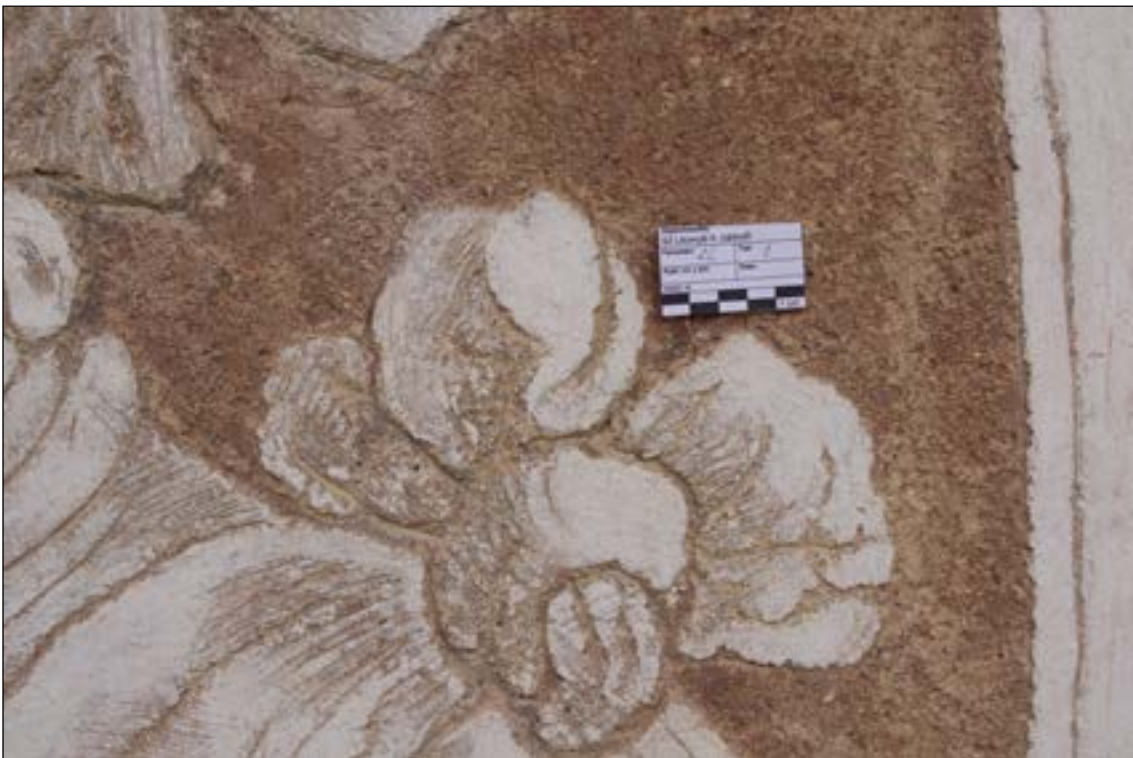
Bílý nátěr (bianco) - oprava 1984–1987 - Zoubek, Boštík, Palcr, Podhrázský (2C/1). Intenzita nátěrů kolísala, dle dochování původního povrchu. V místech, kde byl dochován původní povrch, jedná se o horní partie) byl nátěr hlavně aplikován na hladká šrafurou nestínovaná místa (evokuje tak trochu nasazení světla) a míst se šrafurou se restaurátoři vyhýbali (dobře to pak imituje a podporuje stínování).
