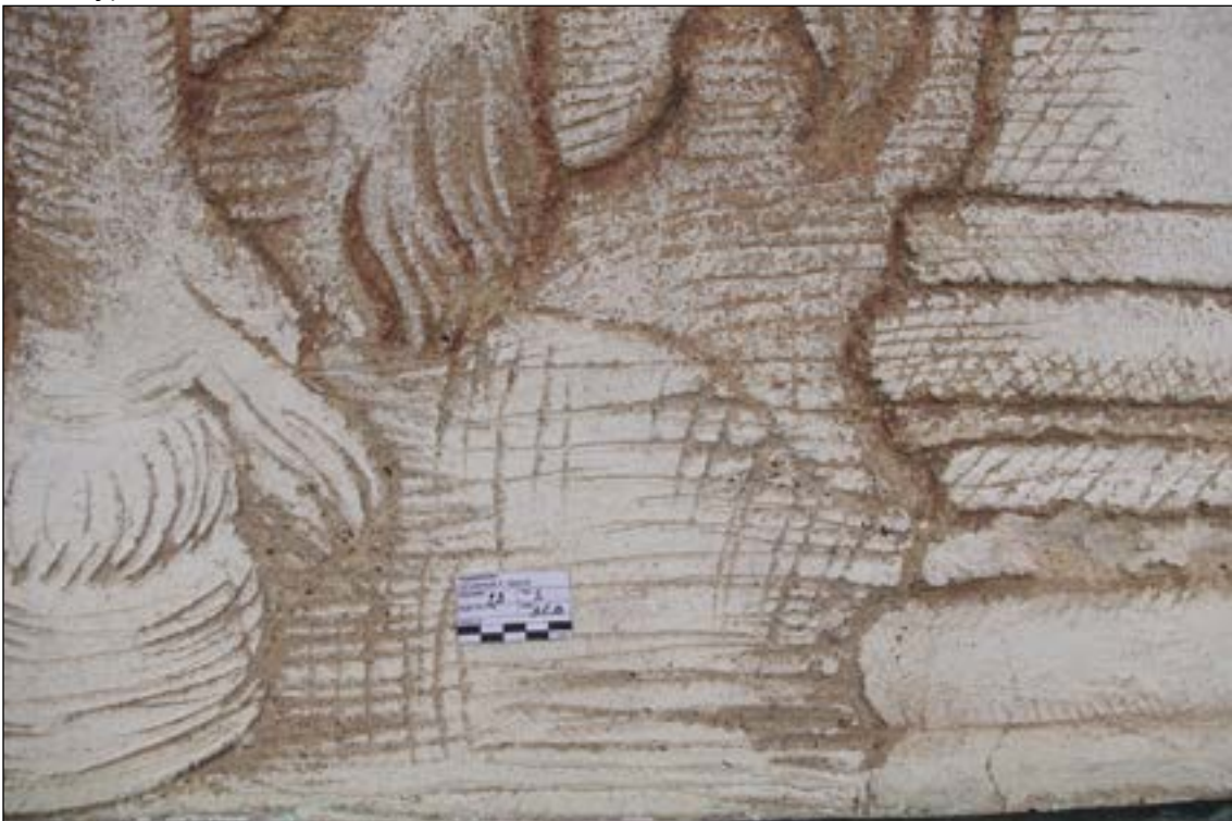
Oprava 1984 - 1987 - Zoubek, Boštík, Palcr, Podhrázský (2B/2). Omítka světle šedé barevnosti. Jednalo se patrně o omítku s menším podílem pojiva (souzeno dle rytých linií, vytrhávali se zrna plniva, okraje jsou okousané). V omítce nejsou patrné primární trhliny.
