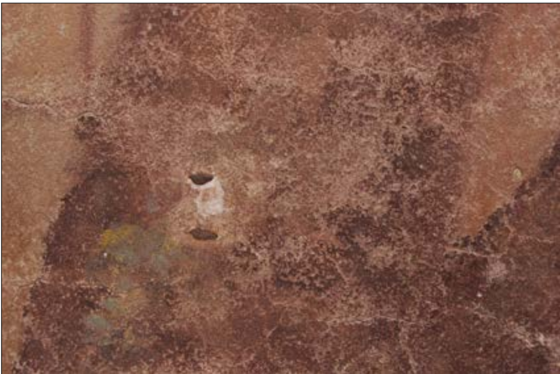
Detail kovového prvku v původní omítce hodin a degradace povrchu a barevné vrstvy (ztráta).
