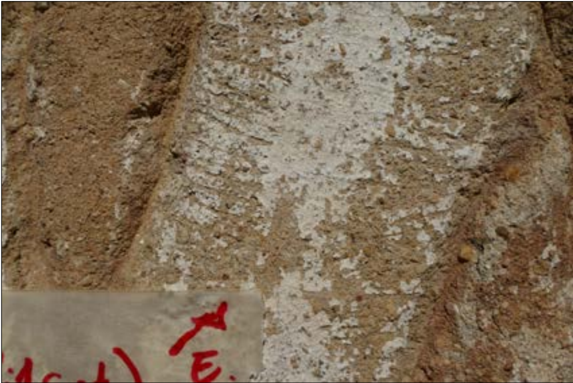
Zkouška K10 - Ethanol - zkouška na renesanční omítce (výjev B5) Zkouška pro vyloučení, že bílý zákal vzniká napuštěním ethanolem. Ethanol netvoří bílý zákal.
