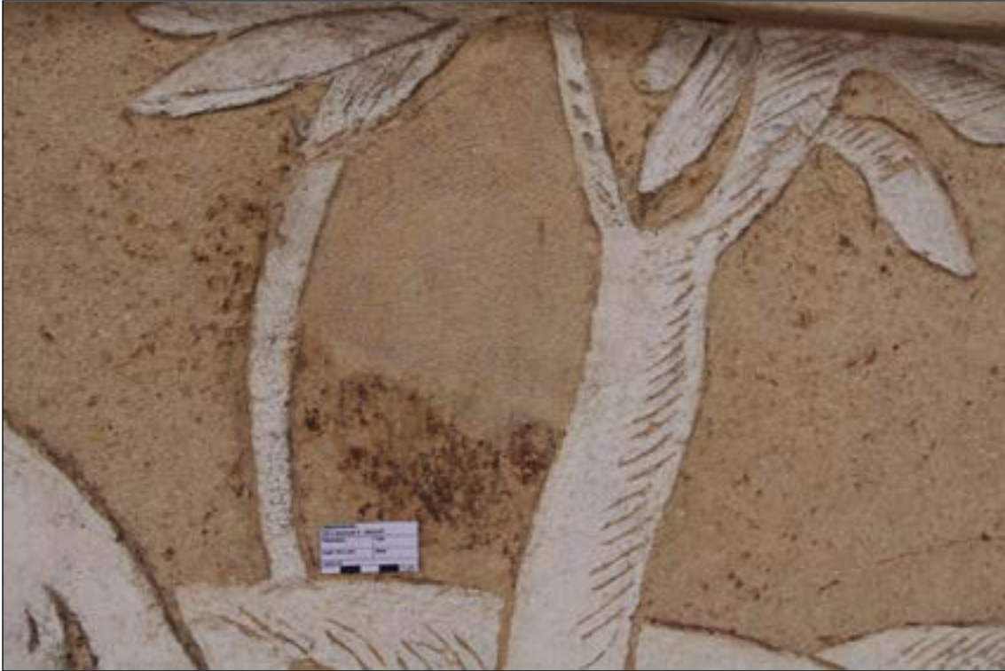
Oprava 1984 - 1987 - Zoubek, Boštík, Palcr, Podhrázský (2B/2). Omítka světle šedé barevnosti, zaretušovaná okrovou barvou. Na povrchu odrytých ploch raně barokní omítky - oprava po požáru 1635 (2B/1) jsou fragmenty nesoudržné okrové jemnozrně vrstvičky a fragmenty černočervené vrstvy (odstraněné druhotné zásahy).
