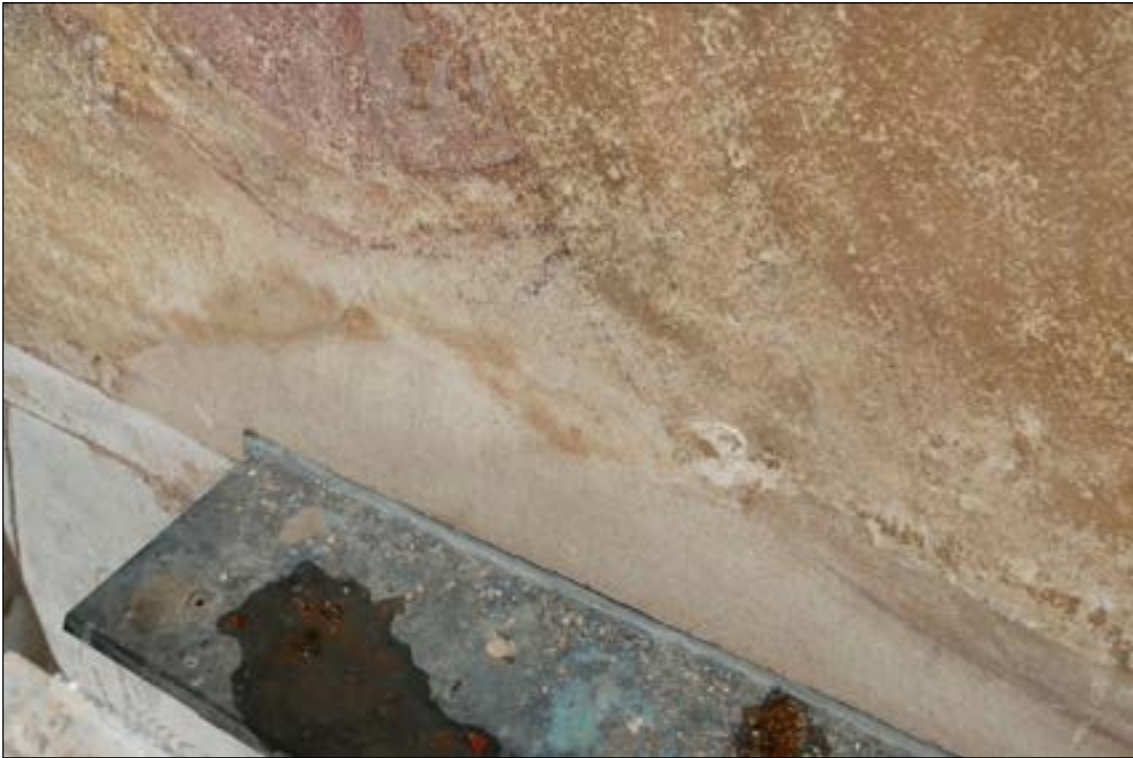
Poškození omítek slunečních hodin vlhkostí nad oplechováním nadokenních parapetů. Dobře patrné vlhké mapy. V těchto partiích se jedná o hranice mezi rekonstrukcí z 80. let. a původní omítkou patrně barokních slunečních hodin).
