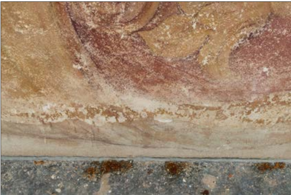
Poškození omítek slunečních hodin vlhkostí nad oplechováním nadokenních parapetů. Nejcitlivější místo je hranice mezi rekonstrukcí z 80. let. a původní omítkou patrně barokních slunečních hodin.
