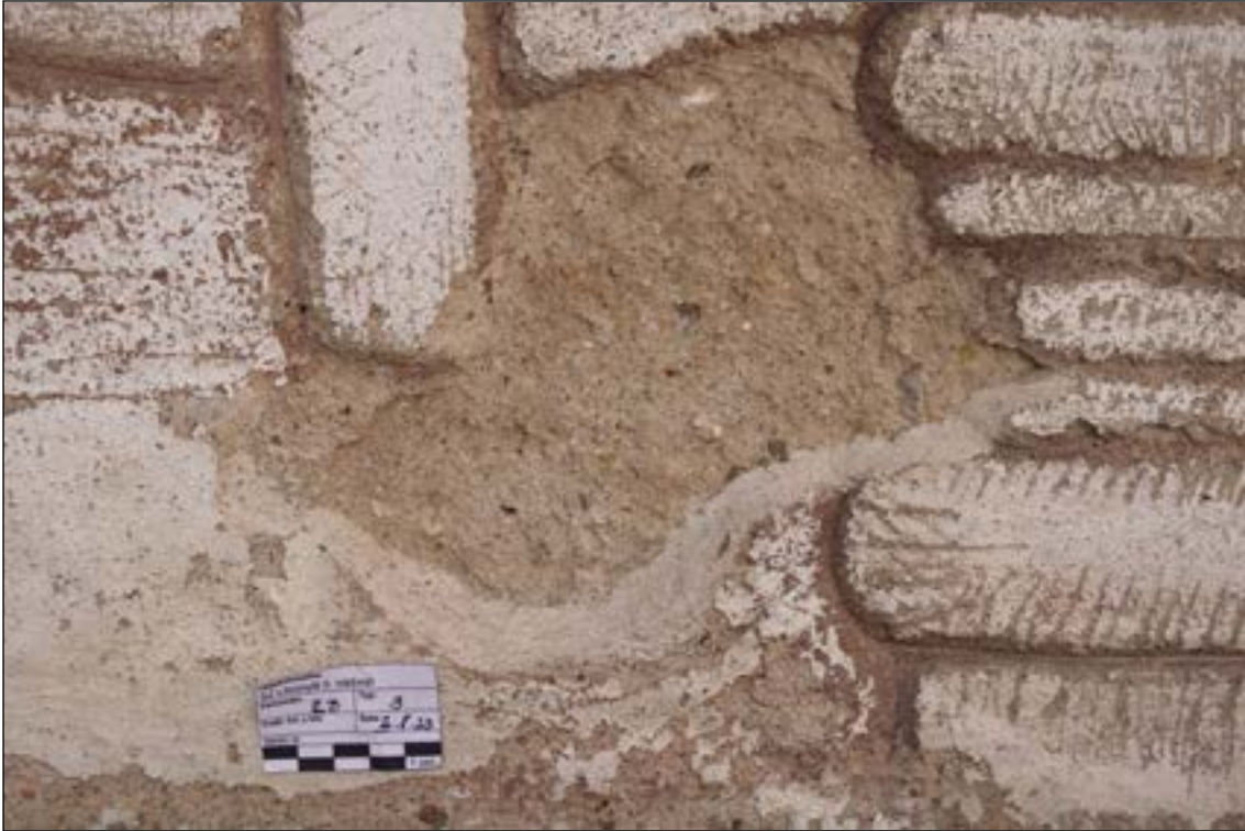
Zajištění 2011 - fakulta restaurování (2B/3). Na místech bezprostředně hrozících odpadnutím byly provedeny drobné „obtmelovací“ vysprávky v rámci havarijního zajištění degradovaných míst.
