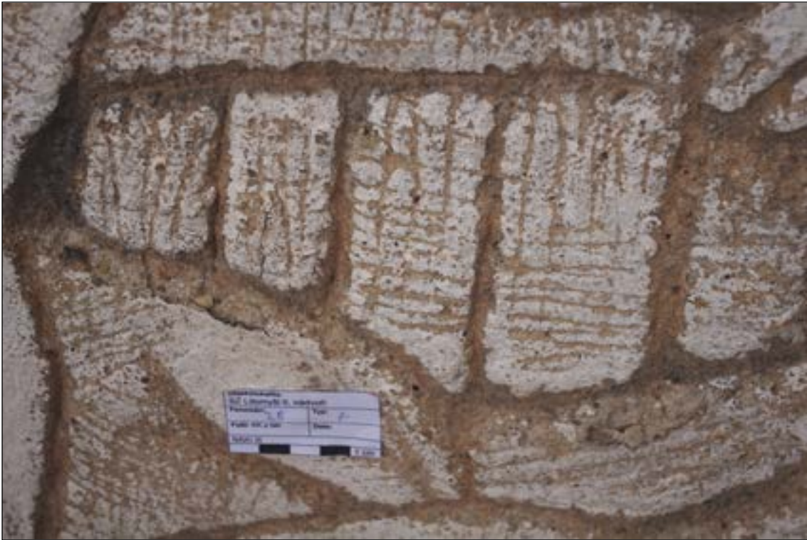
Specifické jsou poškození horních okrajů hlubokých rytých linií renesančních sgrafit (2E/7).
