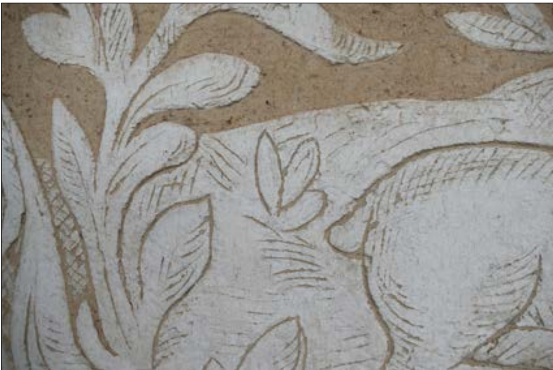
Bílý nátěr (bianco) - oprava 1984–1987 - Zoubek, Boštík, Palcr, Podhrázský (2C/1). Specifická situace je na plochách raně barokní omítky, kde současný nátěr, spolu s nátěry předchozích zásahů tvoří nepropustnou vrstvu nanesenou na ve hmotě degradované omítku. Nátěr tak působí jako další degradační fenomén spolu s deformací malířského účinku výjevu (2C/6).
