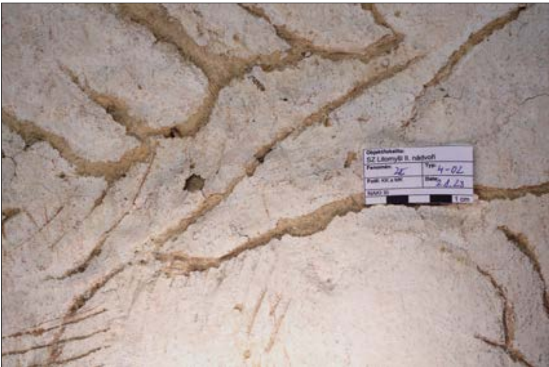
Poškození – defekty (2E). Dalším havarijním stavem lze označit plošné poškození omítek barokních (2E/4-02). Drobnými puchýři, kdy do hloubky až 1 cm, je poškozena hmota omítky, je nesoudržná, rozpraskaná a potřebuje okamžitý a důkladný konzervační zásah.
