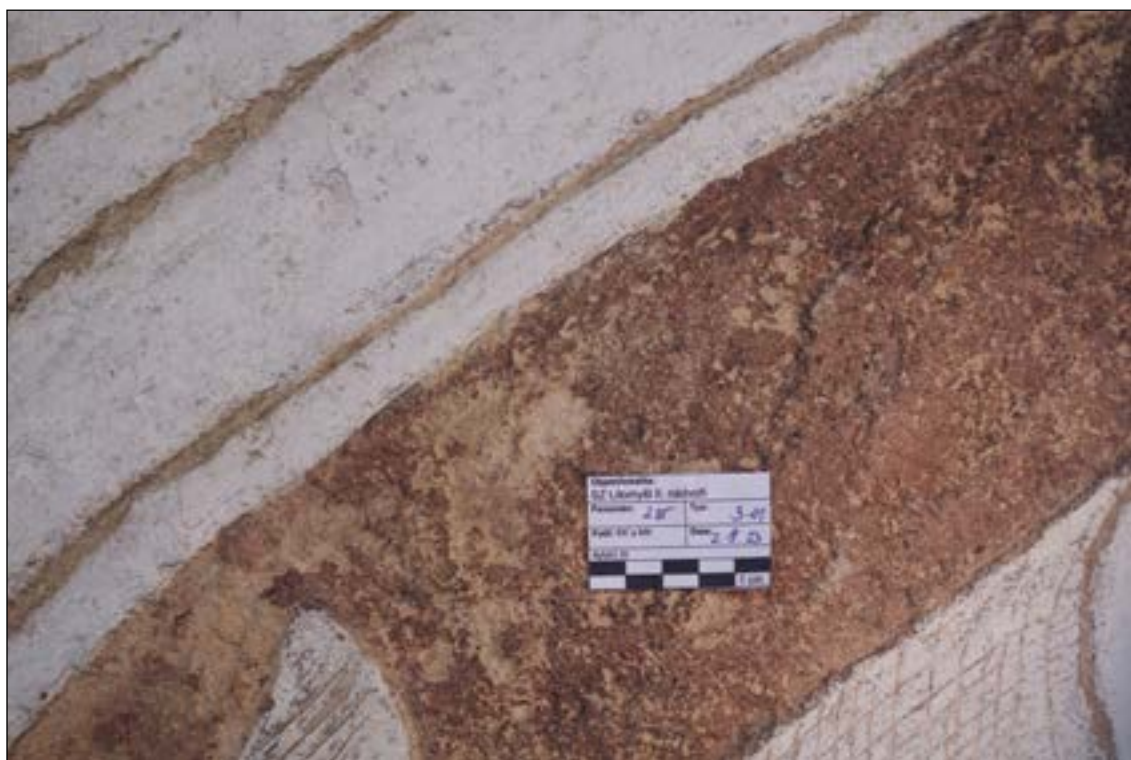
Velmi rozsáhlým poškozením omítek i nátěrů je koroze povrchu. Rozsáhlá eroze po-vrchu omítek renesančních (2E/3-01) kompletně na celé ploše (méně na 4. pásu, ale i zde dochází k erozi).
