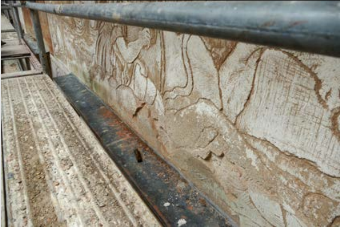
Poškození omítek vlhkostí nad oplechováním nadokenních parapetů. Degradace omítek ve hmotě, jedná se především o rekonstrukce z 80. let.
