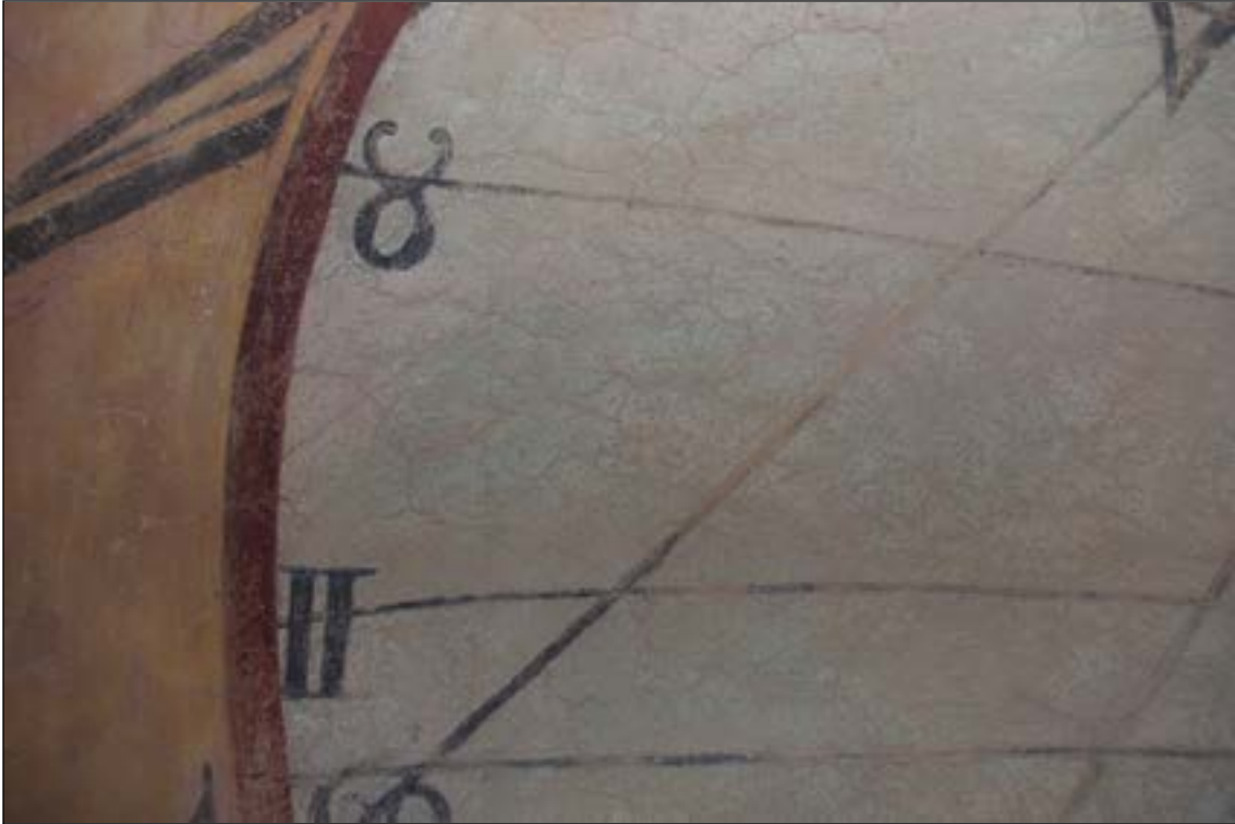
Původní povrch slunečních hodin se liší úpravou povrchu od omítek sgrafit. Je hrubší, filcovaný, pokrytý sítí vlasových primárních trhlin.
