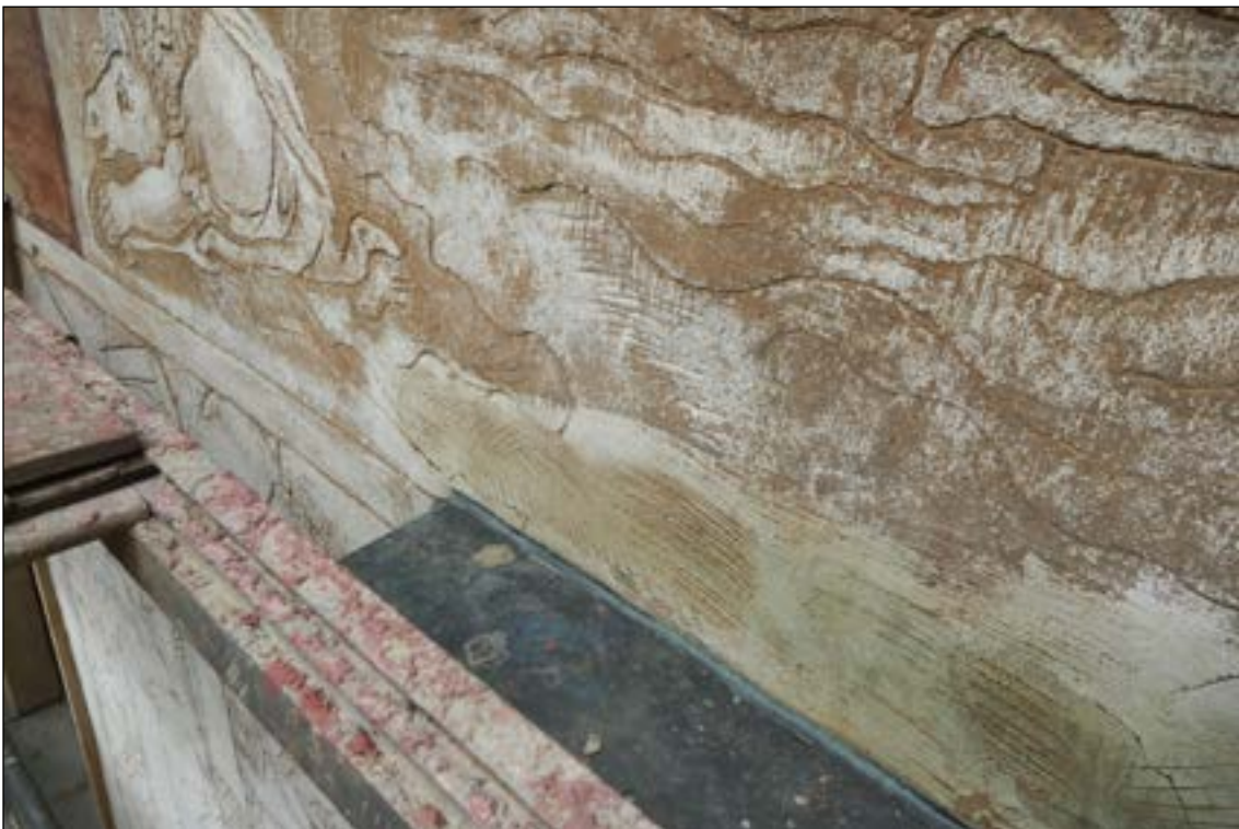
Poškození omítek vlhkostí nad oplechováním nadokenních parapetů. Dobře patrné vlhké mapy a bionapadení (v těchto partiích se jedná především o rekonstrukce z 80. let.).
