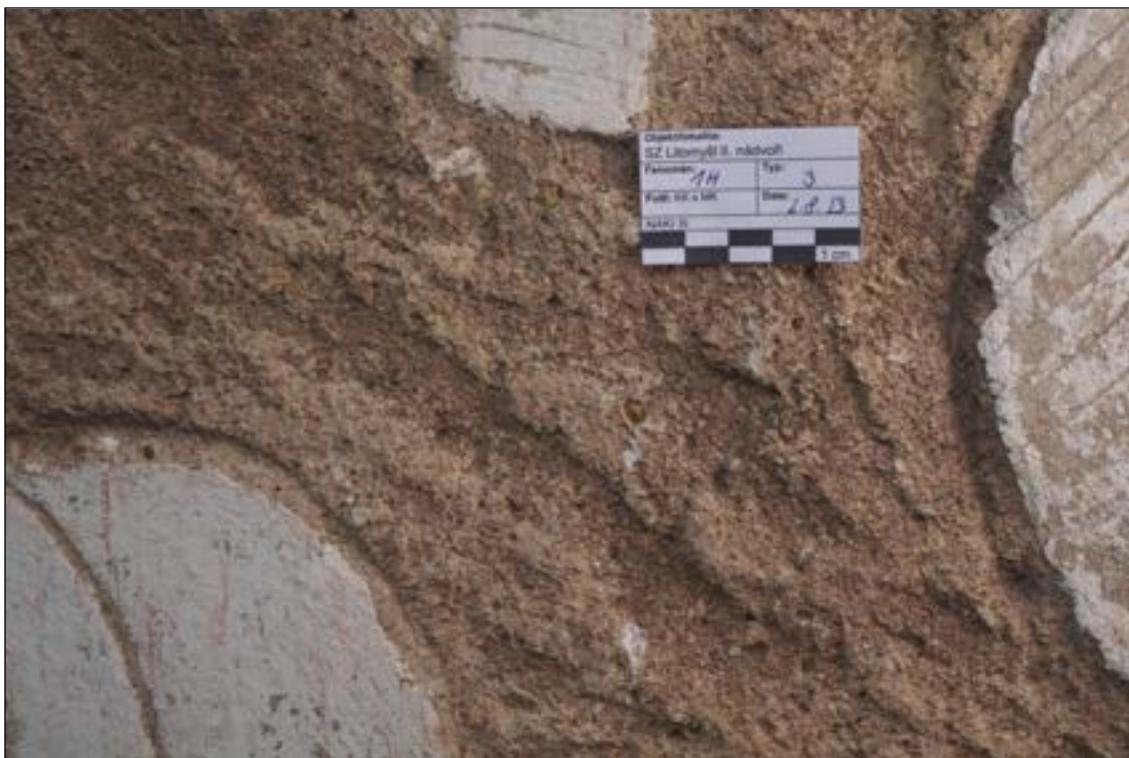
Stínování 1H. Na fasádě bylo identifikováno i klasické stínování odrytím (1H/3).
