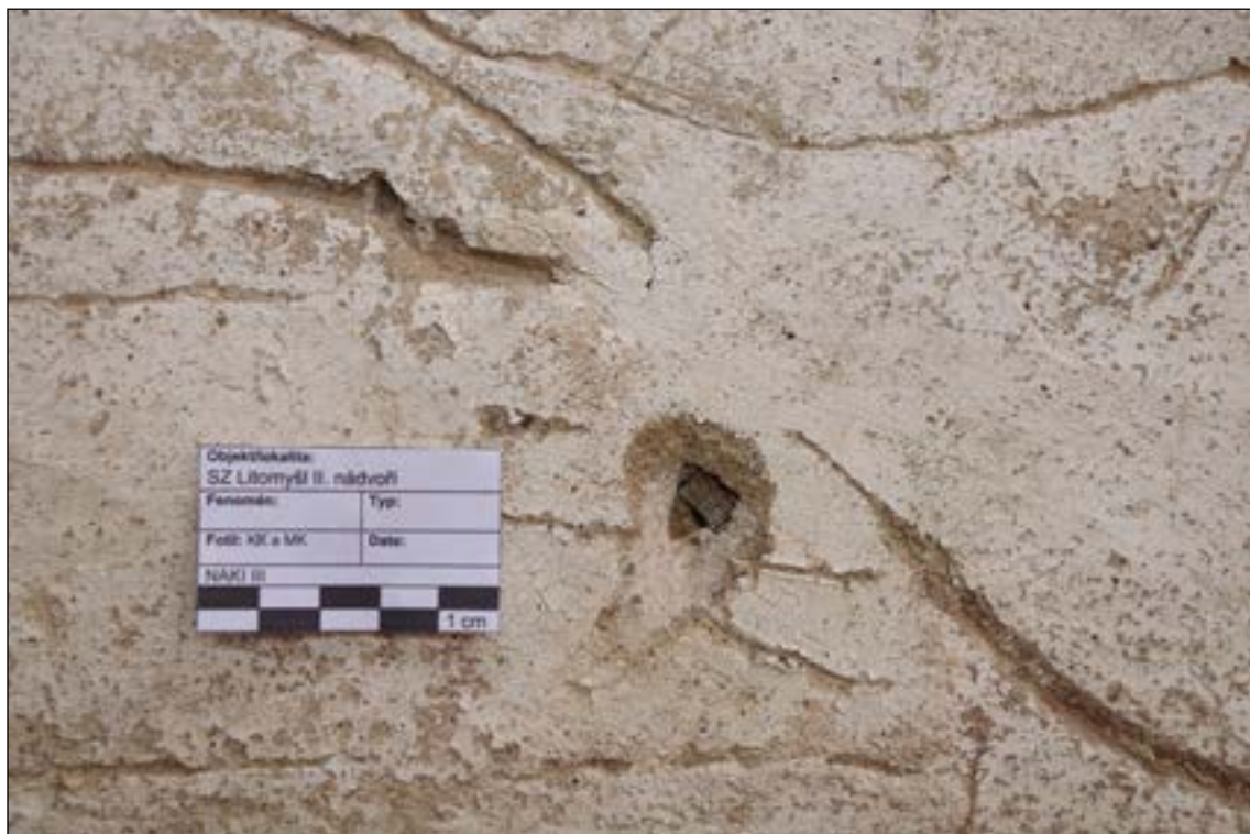
Zdivo 1A. Na jednom místě byl identifikován kus dřeva ve zdivu (1A/4) u kterého však nelze přesvědčivě určit zda se jedná o původní či druhotný prvek.
