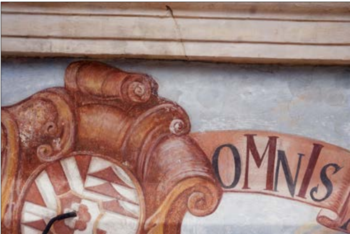
Stav maleb horní partie římsy. Lokální degradace barevné vrstvy - místa odpadlí od posledního komplexního restaurování v 80. letech.
