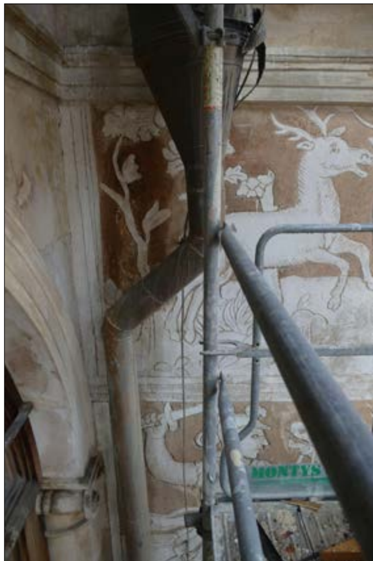
Barevné vrstvy – změny barevnosti (2D). Mokrā místa (2D/9) v rozích u okapových svodů jsou samozřejmě nejlépe patrná po dešti.
