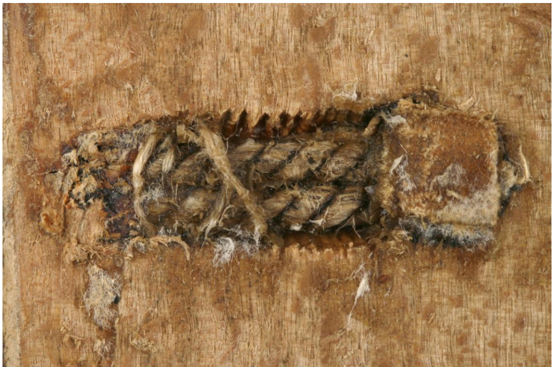
Obr. č. 68: Urbář z r. 1625, detail původního upevnění vazů
