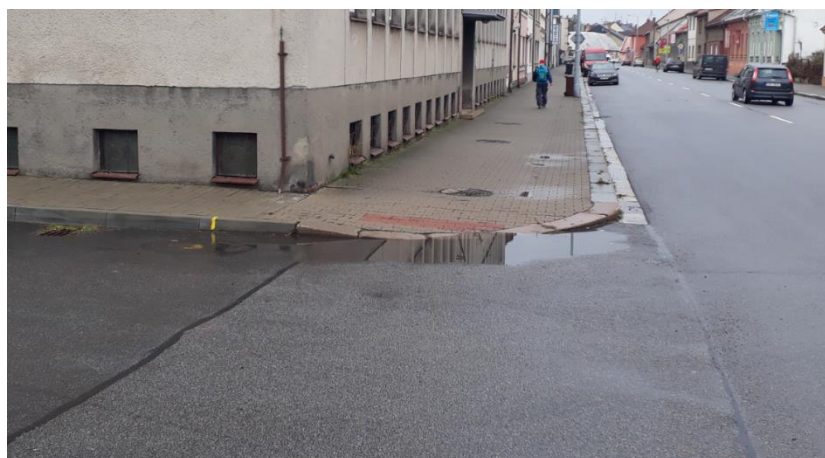
Obrázek 56 – Porucha č. 1 Místní pokles, neodvodněná plocha
