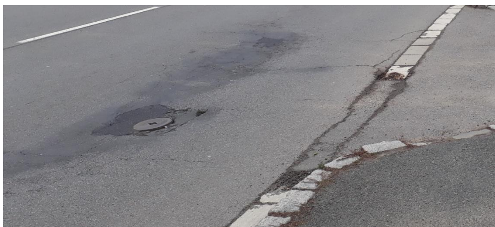
Obrázek 45 – Porucha č. 10 – Výtlupek ve vozovce s lokálními vysprávkami
