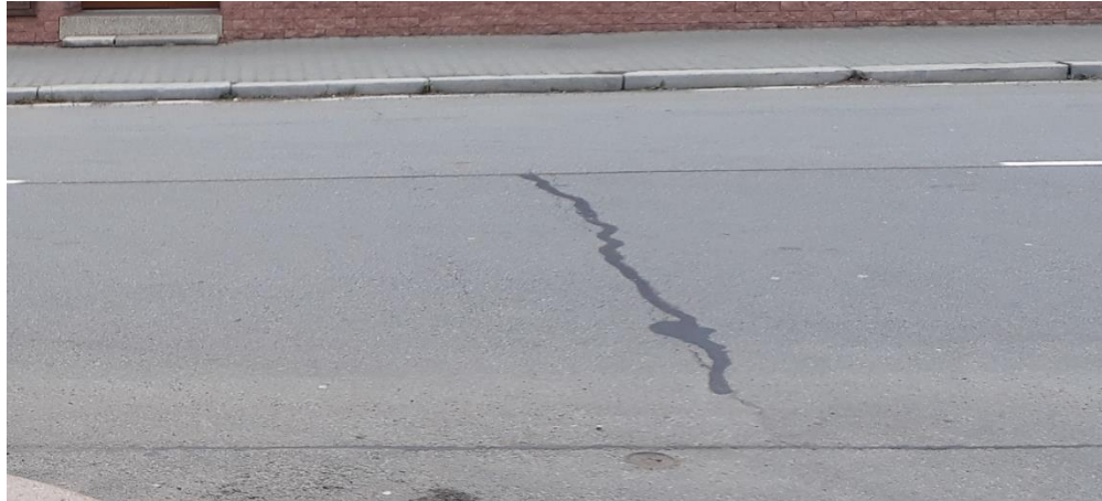
Obrázek 41 – Porucha č. 5 – Příčná vysprávka trhliny v šířce jízdního pruhu
