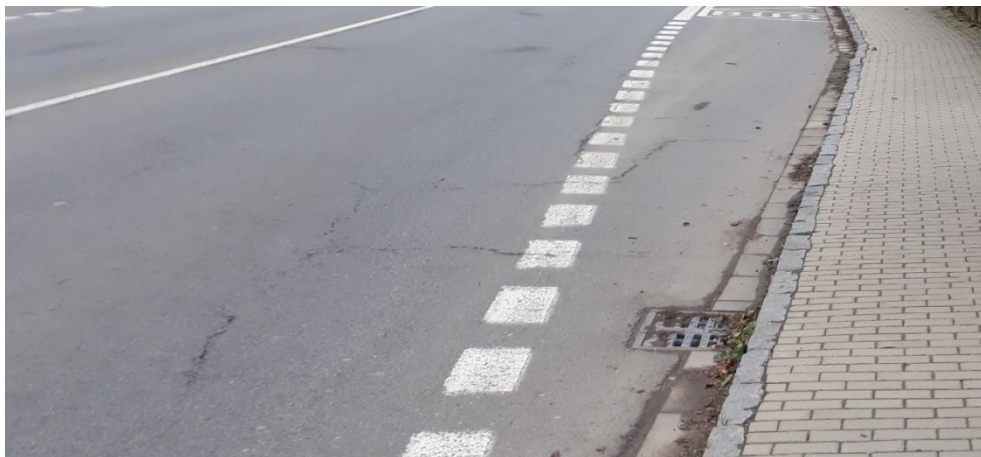
Obrázek 54 – Porucha č. 20 – Síť mikrotrhlin ve vozovce autobusové zastávky
