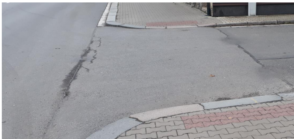
Obrázek 40 – Porucha č. 4 – Rozvětvená podélná trhlina v pracovní spáře
