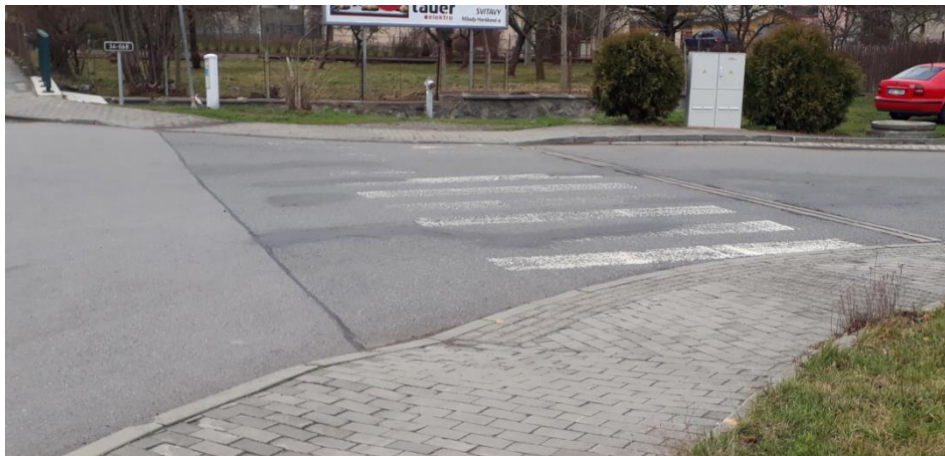
Obrázek 64 – Porucha č. 9 – Opotřebované VDZ – Přechod pro chodce
