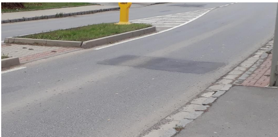
Obrázek 52 – Porucha č. 18 – Vysprávka ve vozovce
