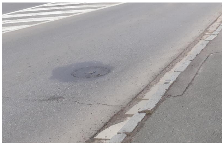
Obrázek 48 – Porucha č. 14 – Vysprávka kolem hrníčku, včetně vznikajících mikrotrhlin v okolí
