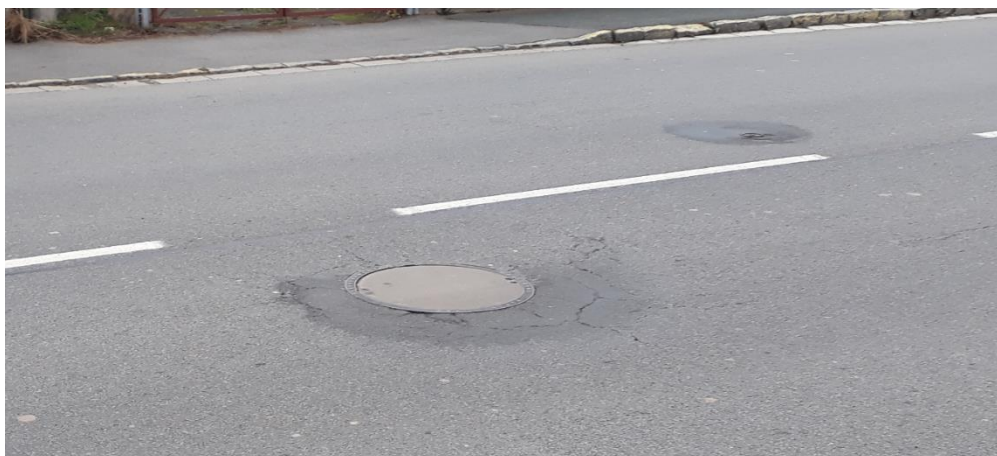
Obrázek 50 – Porucha č. 16 – Lehce propadlý poklop s lokální vysprávkou
