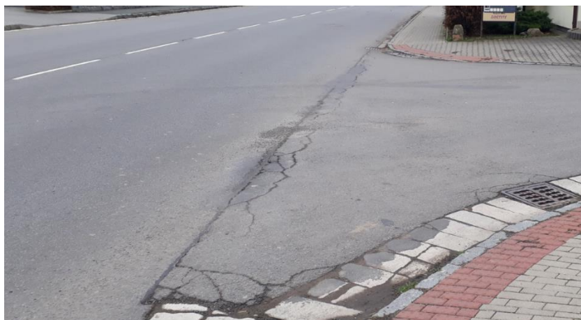
Obrázek 51 – Porucha č. 17 – Podélná rozvětvená trhлина v pracovní spáře
