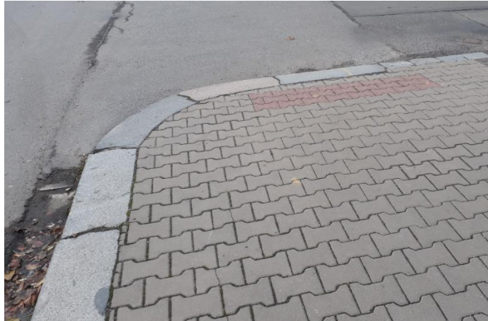
Obrázek 61 – Porucha č. 6 – Rozpad okrajů vozovky
