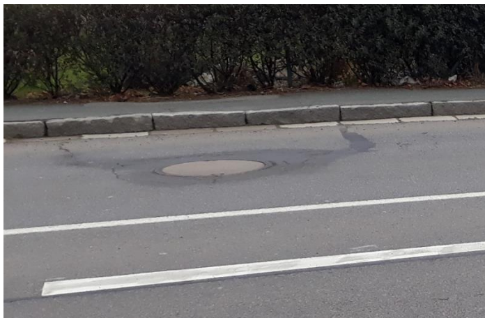
Obrázek 47 – Porucha č. 13 – Vznikající trhliny kolem lehce propadlého poklopu s lokální vysprávkou
