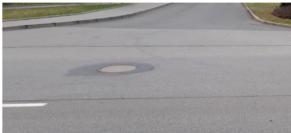
Obrázek 44 – Porucha č. 9 – Vysprávka kolem poklopu
