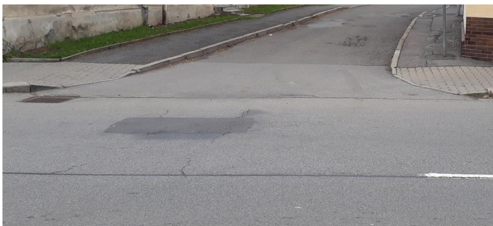
Obrázek 38 – Porucha č. 1 a 2 – Trhлина v pracovní spáře, místní pokles s lokální vysrávkou s okolními mikrotrhlinami
