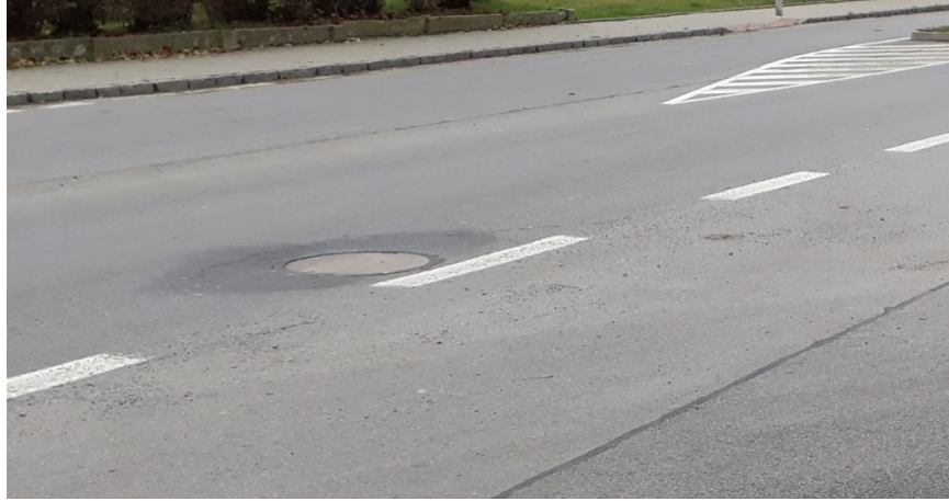
Obrázek 53 – Porucha č. 19 – Lehce propadlý poklop s lokální vysprávkou
