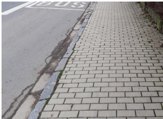
Obrázek 55 – Porucha č. 21 – Trhliny na okraji vozovky
