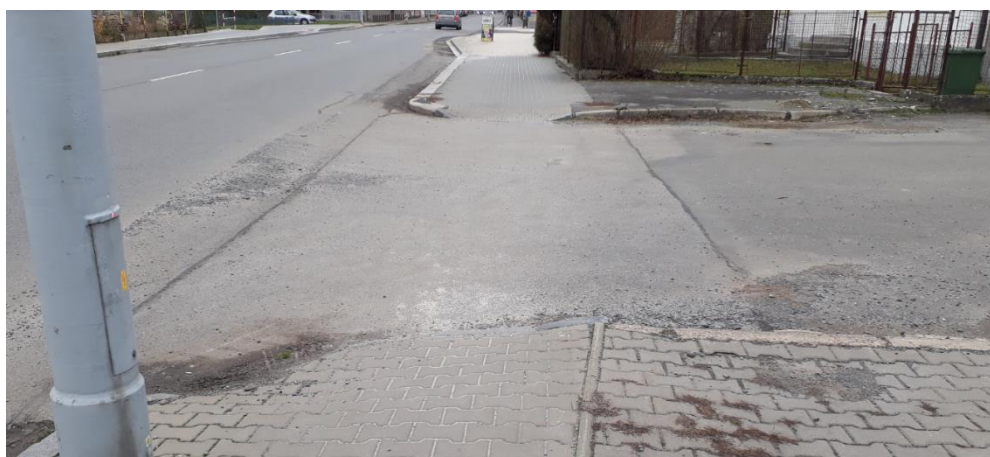
Obrázek 60 – Porucha č. 5 – Zanesení okraje vozovky, zvlněné chodníkové plochy
