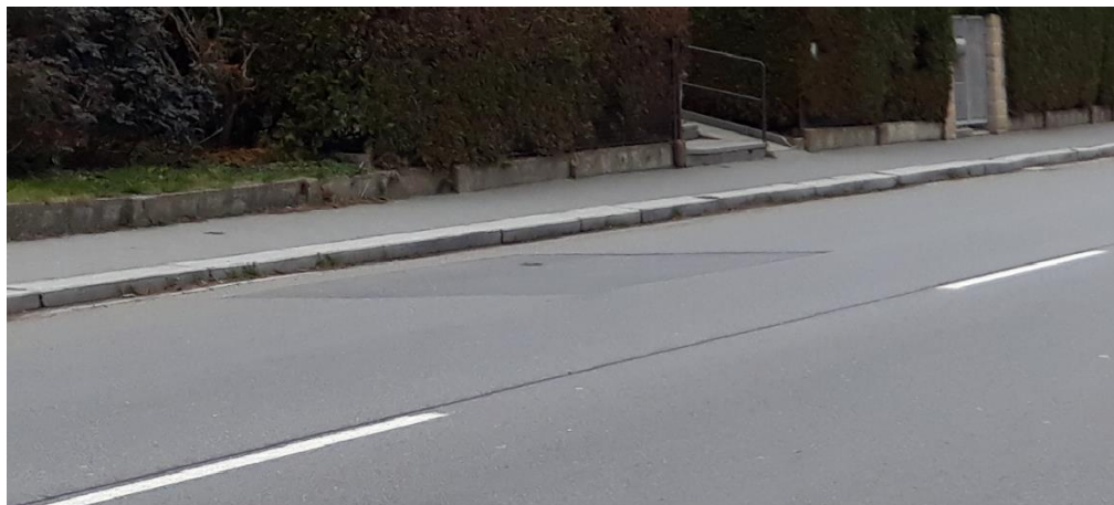
Obrázek 42 – Porucha č. 6 – Místní pokles s vysprávkou
