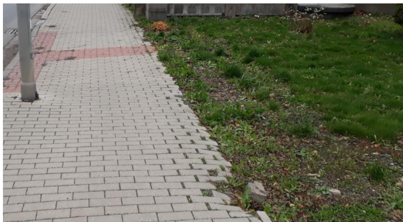
Obrázek 59 – Porucha č. 4 – Rozpadající se dlažba v kontaktu se zelenou plochou
