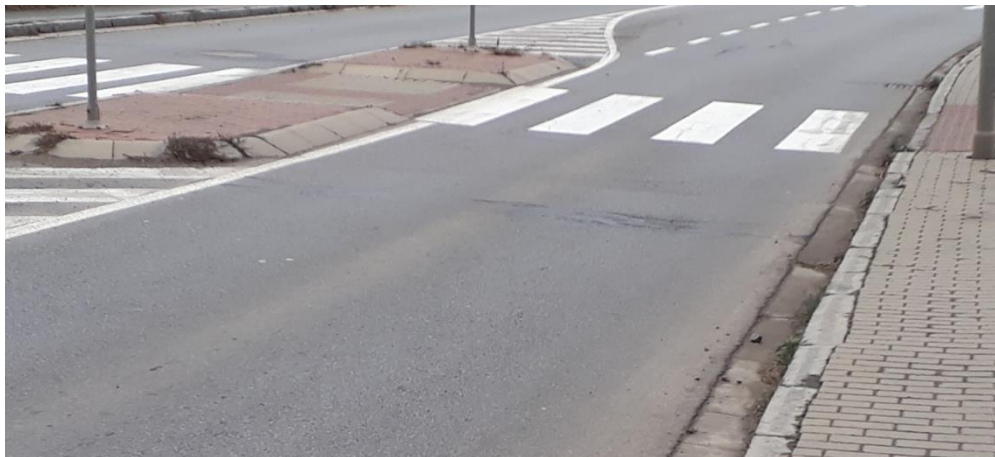
Obrázek 49 – Porucha č. 15 – Síťová trhlina ve vozovce
