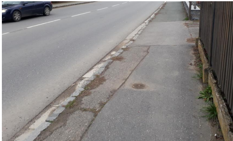
Obrázek 57 – Porucha č. 2 – Hlubková koroze, zvlněný chodník
