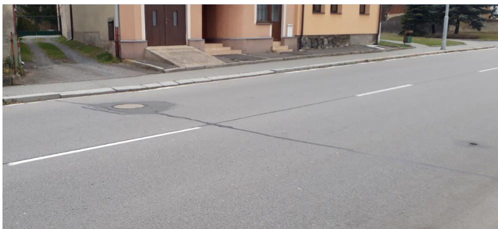
Obrázek 43 – Porucha č. 7 a 8 – Pokleslý poklop a utěsněná příčná spára
