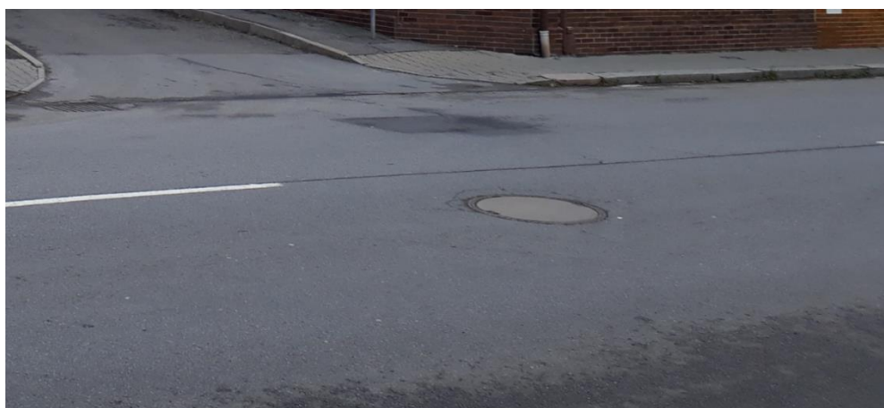
Obrázek 39 – Porucha č. 3 – Mírně pokleslá vozovka kolem poklopu
