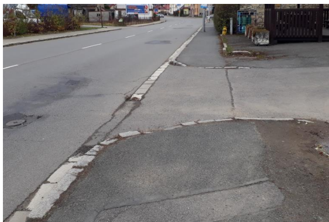
Obrázek 58 – Porucha č. 3 – Výtluk, zvlněné chodníky
