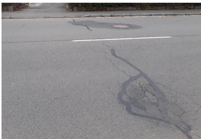
Obrázek 46 – Porucha č. 11 a 12 – Příčná trhlina v celé šířce vozovky, vysprávka kolem poklopu
