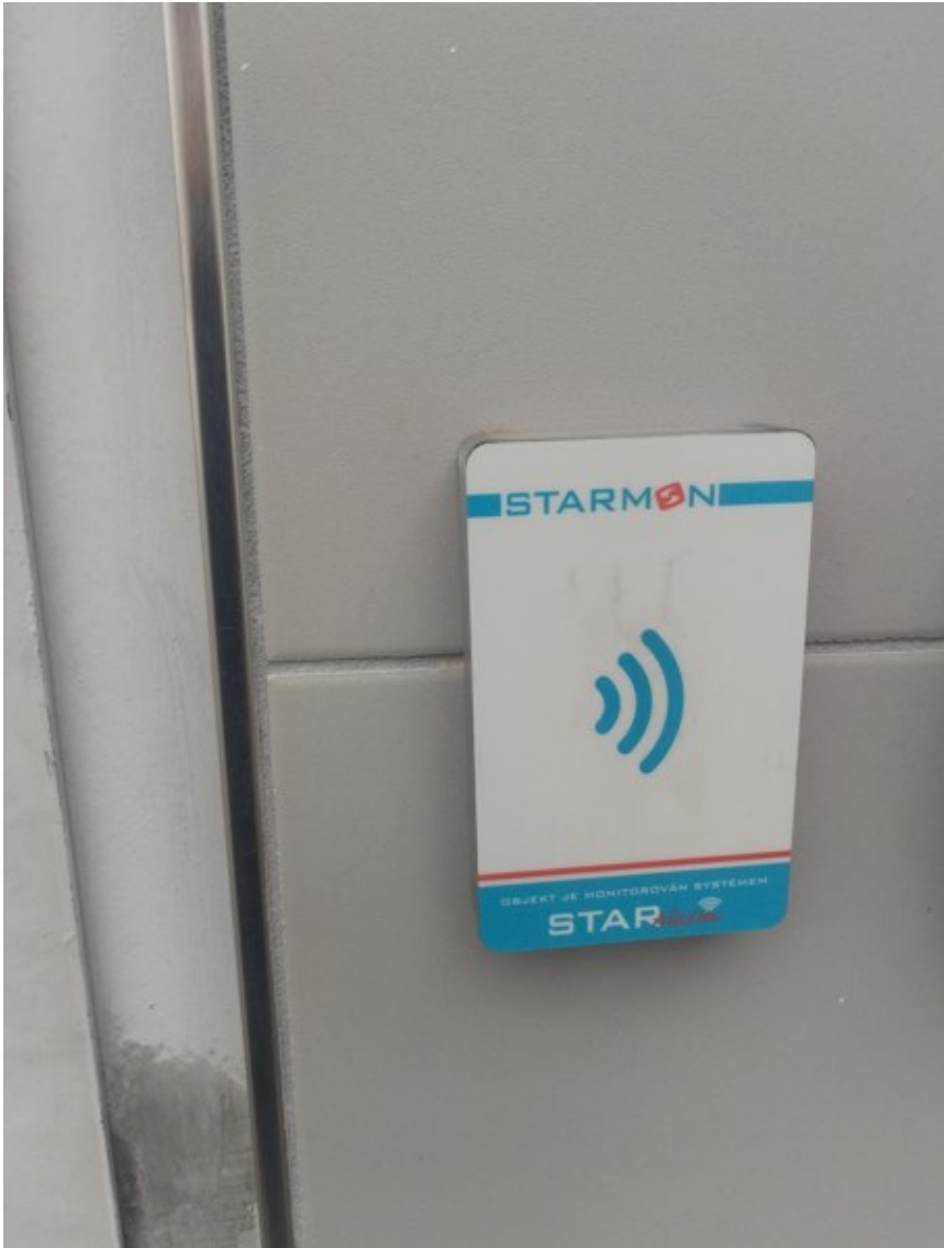
Obrázek 12 Dveřní zabezpečení StarAlarm pro vstup do skladu (autor)
