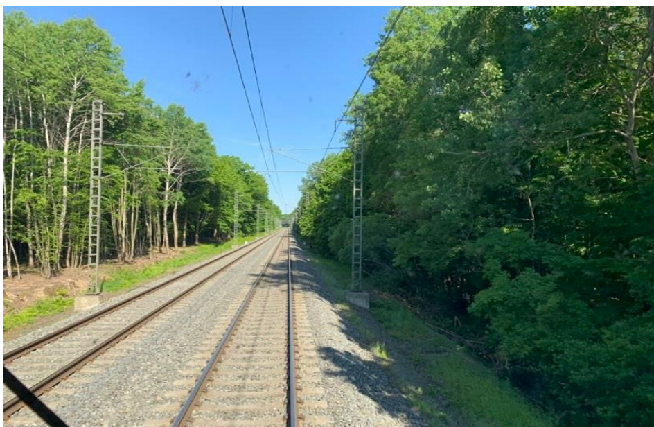
Obrázek 9 Trat' 309A Přerov - Česká Třebová, vzrostlé stromy velmi blízko sloupů trolejového vedení
