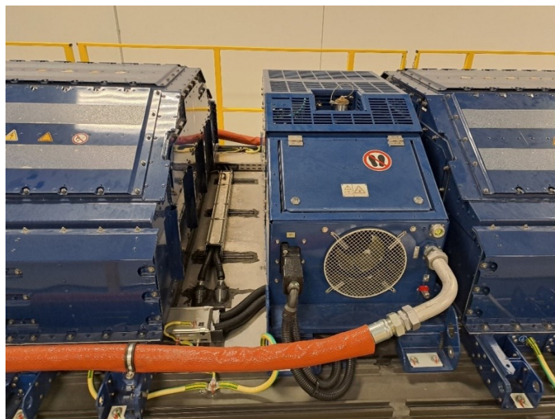
Obr. 4: Termoregulační jednotka trakční bateriové skříně
