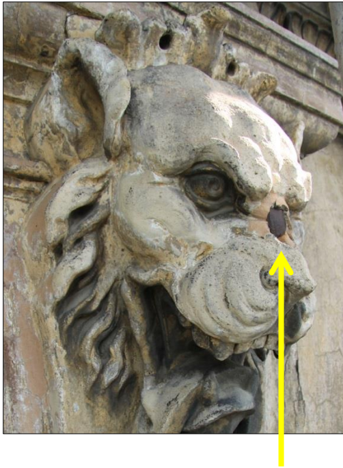
Obr. 60 - Odlitek hlavy lva je připevněný k fasádě železným hřebem.
