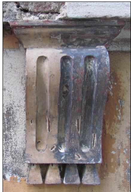
Obr. 63 - Korodující armatury, zvětšily svůj objem a tím došlo k ztrátě originálního povrchu odlitku.
