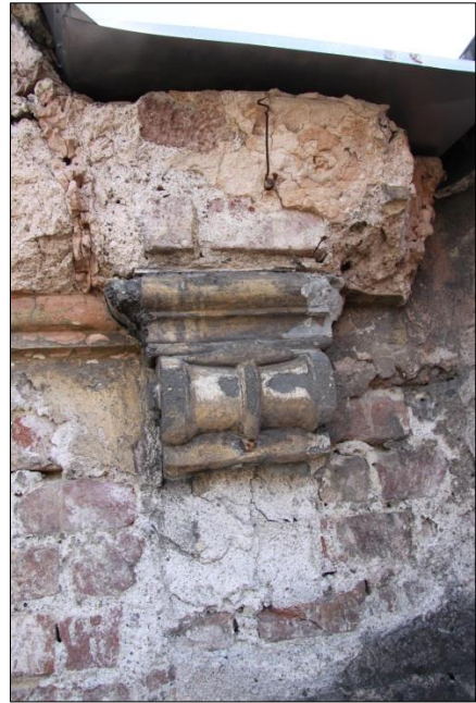
Obr. 61 - Špatný svod vody způsobil ztrátu výzdoby fasády.
