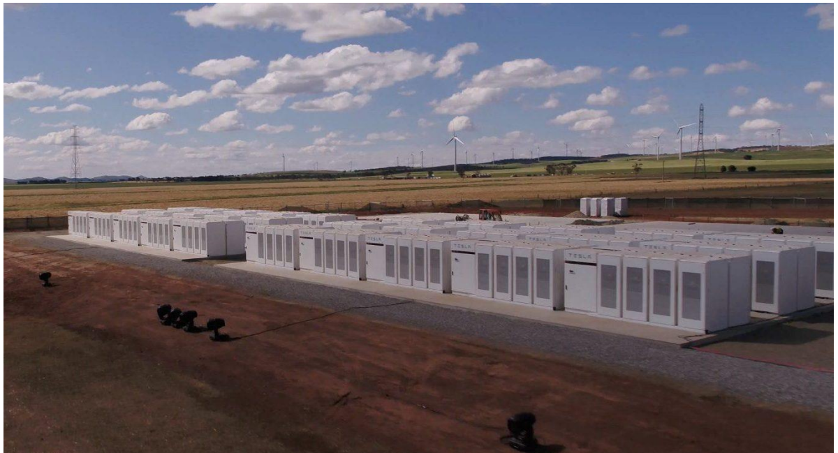
Obrázek 8 Úložiště elektrické energie v jižní Austrálii. 69
