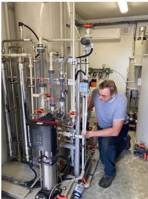
a) Kontrola potrubní trasy modulu RO
