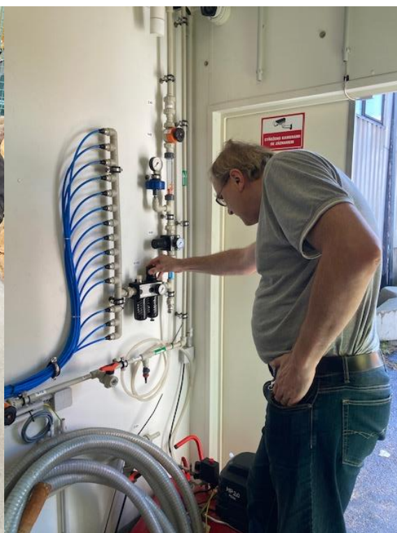
d) Nastavení tlaku vzduchu před distributorem
