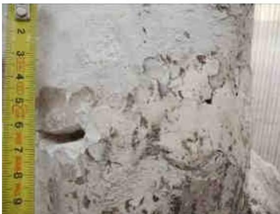
53. Posunutý spoj v úrovni kotníků Putta
