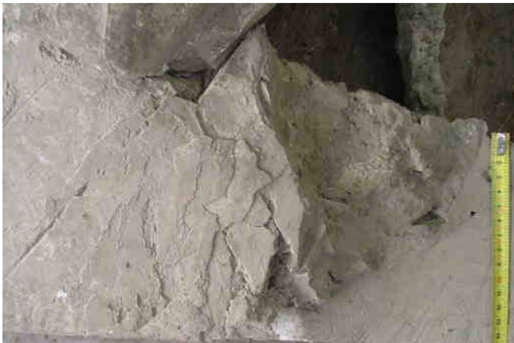
9. Dolní díl trupu Sv. Mikuláše, detail plintu – stav před restaurováním
