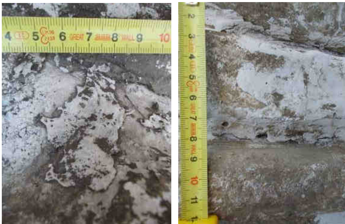
45. 46. Nánosy sádry z předchozích oprav pod nátěrem v záhybech drapérie
