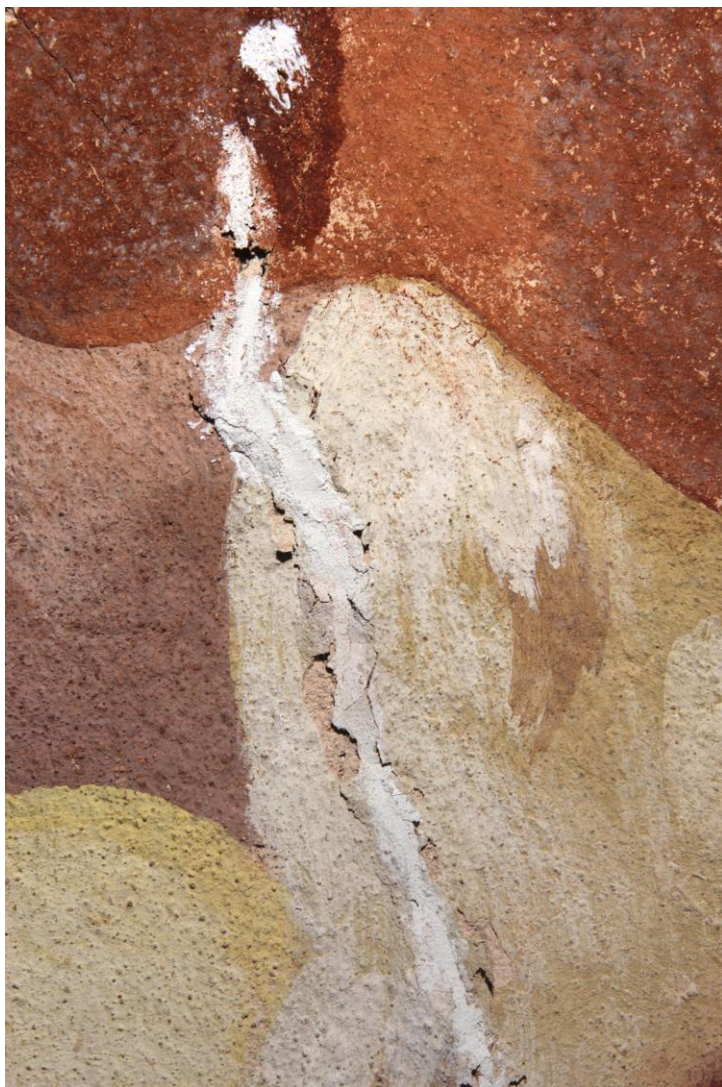
Obr. 89: Detail praskliny v malbě anděla. Stav před restaurováním.
