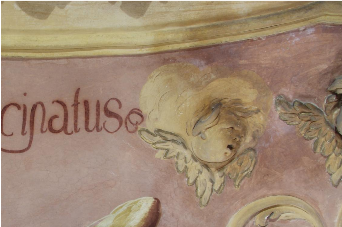
Obr. 58: Detail malby a štukové hlavičky andílka blíže andělskému kůru Angeli. Stav před restaurováním. Detail poškození – ztmavnutí barevné vrstvy v důsledku silného zatékání a přítomnosti síranů. Ve ztmavlé oblasti jsou patrné i bílé výkvěty solí.
