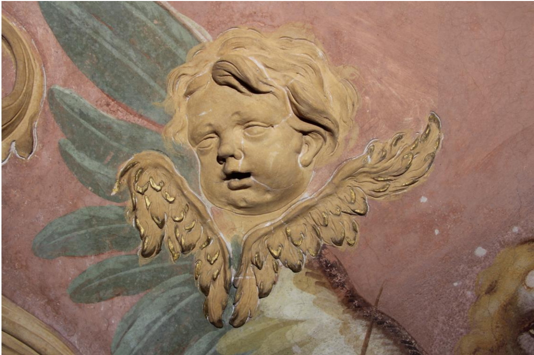
Obr. 77: Štuková okřídlená hlavička andílka, blíže k andělskému kůru Virtutes. Stav po očištění a vytmelení.
