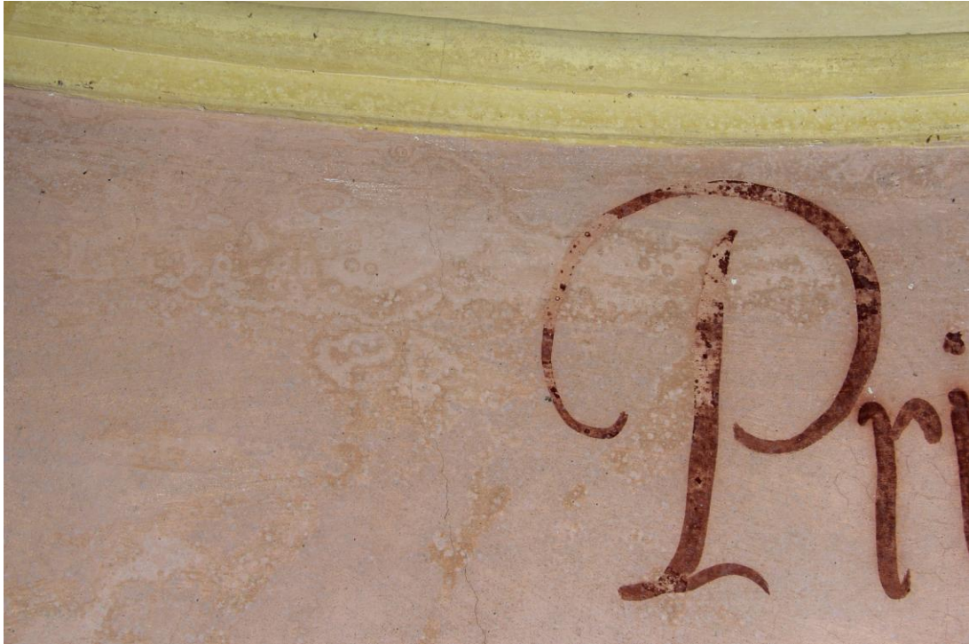
Obr. 57: Detail malby pod rámem z vavřínových lístků. Stav před restaurováním. Detail poškození – zatekliny.
