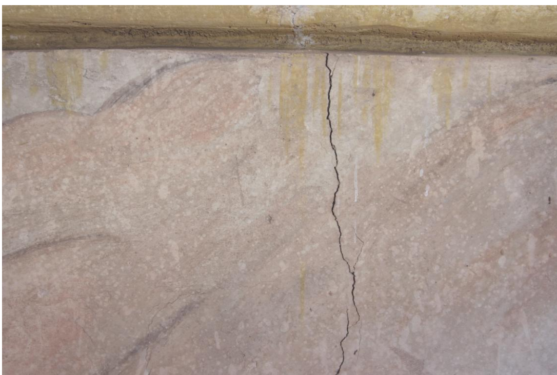
Obr. 62: Detail pásu s malbou mraků. Stav před restaurováním. Detail poškození – vertikální trhlina; potřísnění stékanci okrové barvy; stopy po kapkách neznámého původu, jimiž byla smyta zpráškovatělá barevná vrstva.
