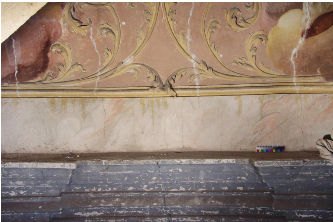
Obr. 46: Pás s malovanými oblaky, v horní části lemovaný profilovaným štukovým rámem. Stav před restaurováním. Vymezený úsek se nachází mezi andělským kůrem Principatus a andělským kůrem Virtutes
