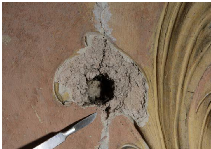
Obr. 124 Defekt v levé dolní části výjevu Seraphim, detail, vzorek O1 (7340).
