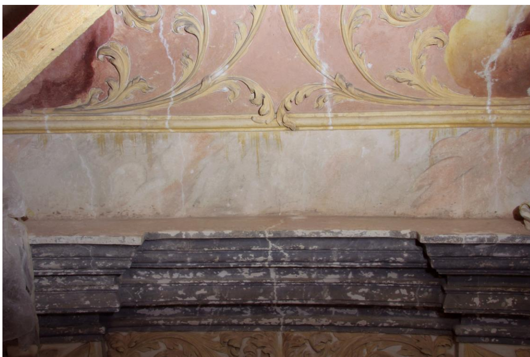
Obr. 76: Pás s malovanými oblaky. Stav po očištění a vytmelení.
