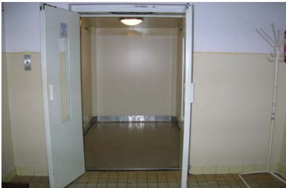
Evakuační výtah na poliklinice
