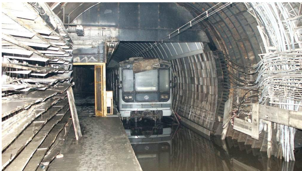
Obrázek 3 Zatopená stanice metra B (metroweb, 2002)
