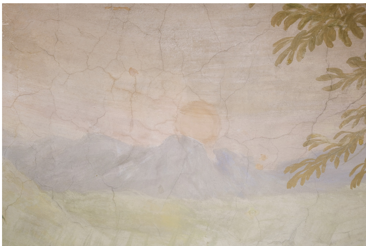
Obr. 71: Snímek zobrazující esteticky nevyhovující druhotný tmel v oblasti nohy anděla. Na snímku lze pozorovat nevhodně zapojený tmel se značně posunutou barevností.
