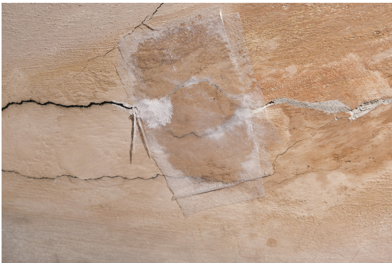
Obr. 87: Na snímku lze pozorovat proces přelepení uvolněných částí omítky před injektáží.
