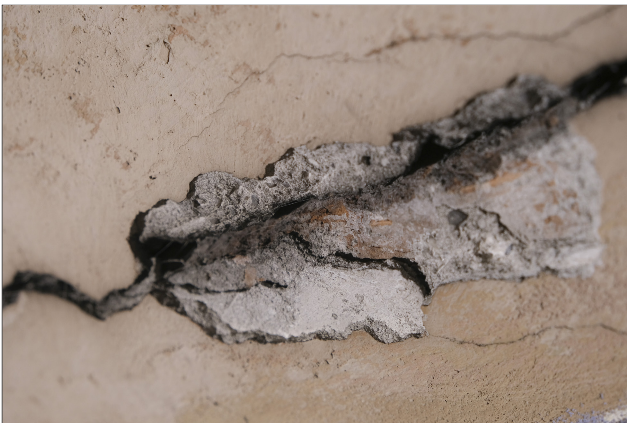
Obr. 75: Na snímku lze pozorovat skleněný pásek, který je připevněn na sádro sledující aktivitu trhliny v oblasti oblohy. Stav před restaurováním.
