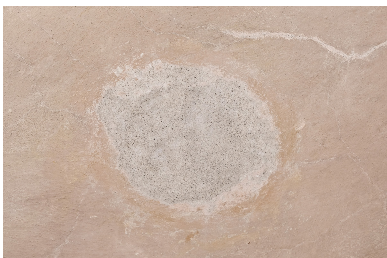
Obr. 97: Snímek dokumentující stav defektu po vytmelení.
