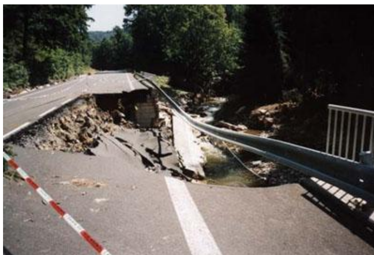
Obrázek 7: Škody na silnici č. 19
