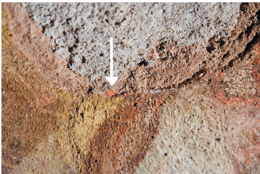
Obr. 70: Šipka vyznačuje místo, kde se po odstranění přelepů pod intonacem objevila barevná vrstva. Předpokládáme, že se jedná o autorskou přemalbu.
