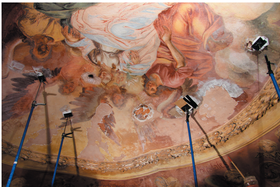
Obr. 78: Stav malby v průběhu konsolidace. Hloubkově injektovaná malba je zajištěna vzpěrami.
