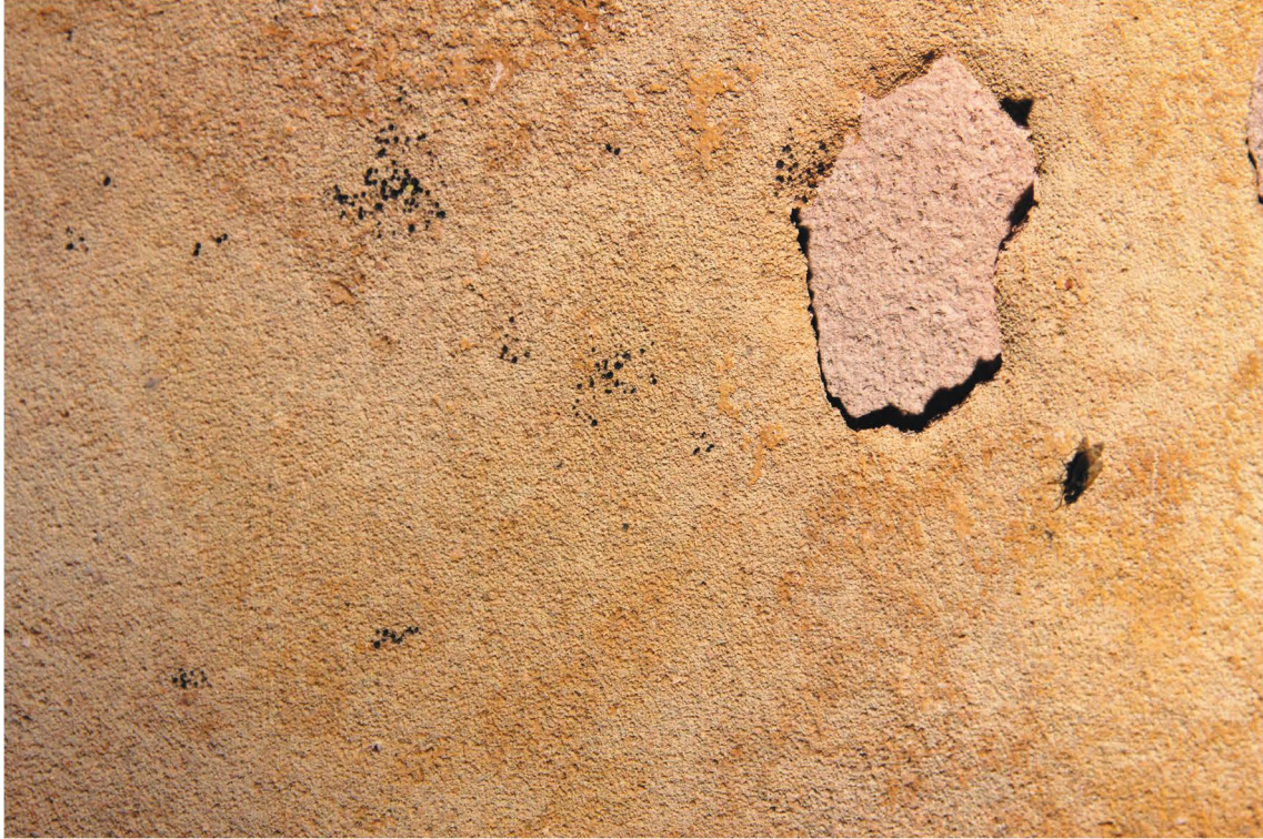
Obr. 40: Zpraškovaná malba, lokálně s drobnými puchýřky a výkvěty soli. Viditelné je znečištění povrchu malby hmyzem. V defektu malby je patrná narušovaná barevnost omítky.
