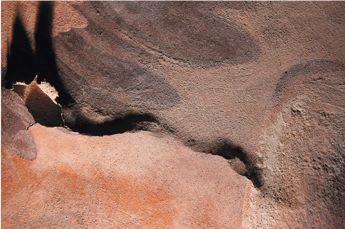
Obr. 39: V bočním nasvícení se zdůraznily nerovnosti povrchu zapříčiněné způsobyřováním malby.
