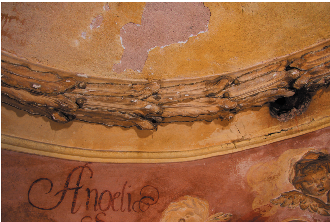
Obr. 53: Západní část štukového rámu; lokálně došlo ke ztrátě jeho barevné vrstvy. Viditelný je větrací otvor vedoucí do krovu. Ve spodní části obrázku se nachází okřídlené hlavičky andělů, které byly také restaurovány v rámci této práce.
