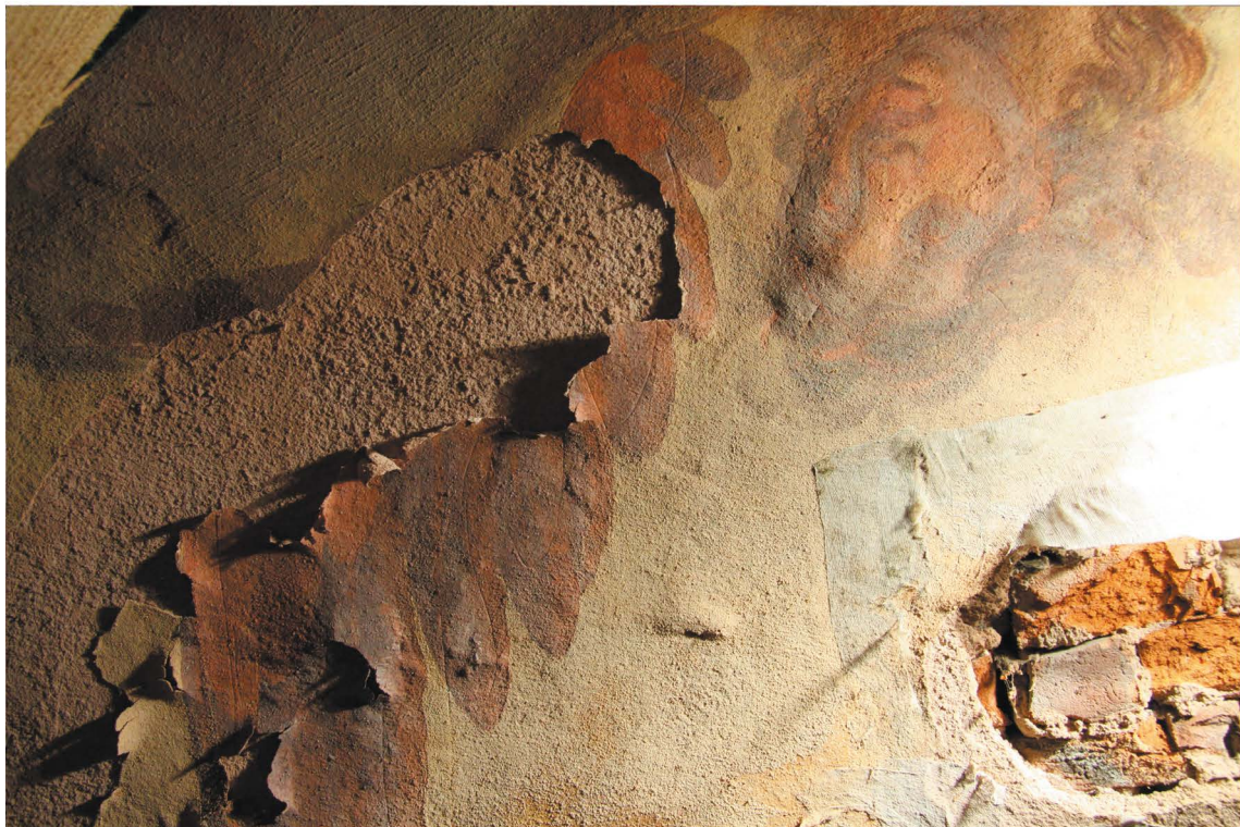
Obr. 37: Detail poškození barevné vrstvy v bočním osvětlení. V obličejí anděla se vytvořil puchýř. Barevná vrstva je křehká a silně zpráškovatělá. Viditelný je defekt s degradujícím přelepem.
