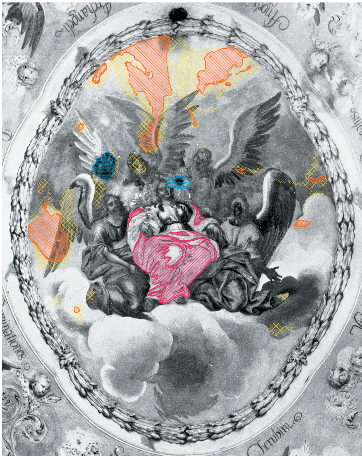
Obr. 43: Výjev Nanebevzetí Panny Marie v centru kupole kaple sv. Isidora. Grafické znázornění jednotlivých poškození:
