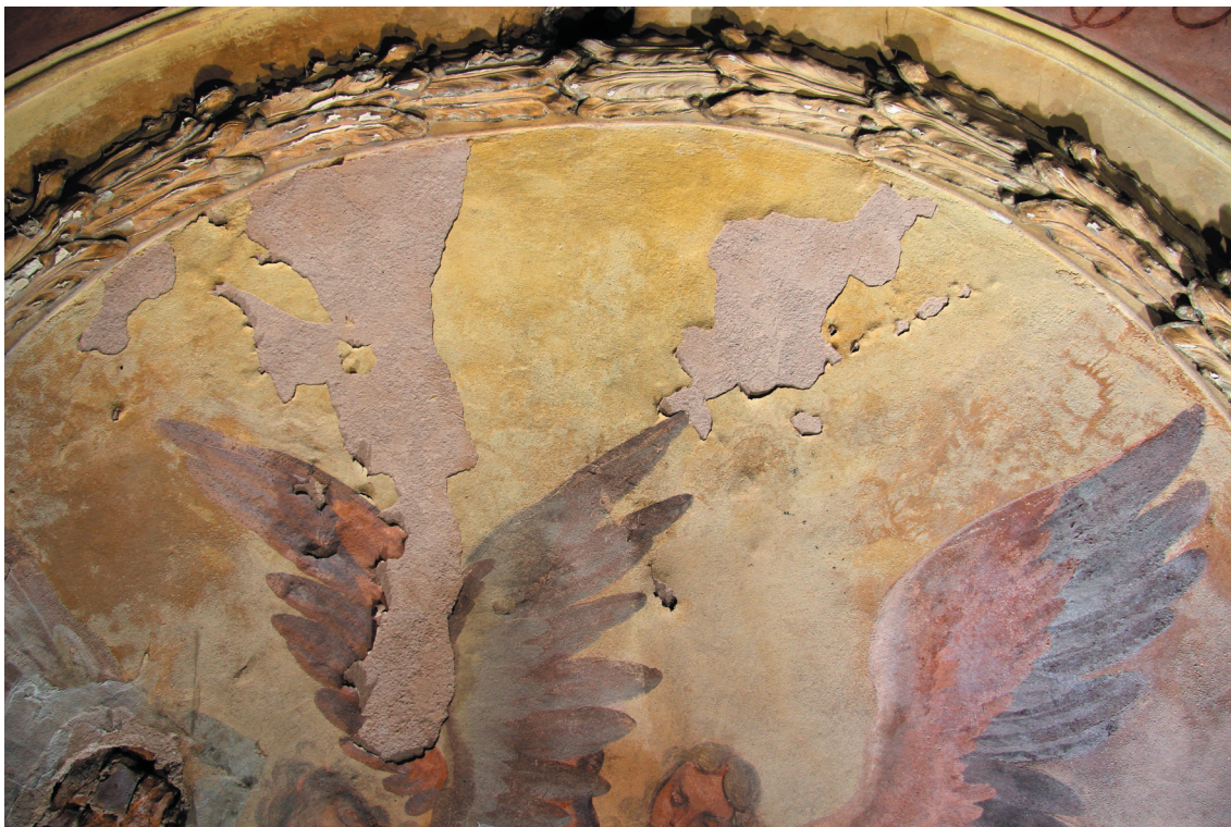
Obr. 52: Horní (západní) část malby je nejvíce poškozená zatékáním. Barevná vrstva je silně zpráškovatělá. Lokálně se změnil barevný tón malby, povrch ztmavl. Štukový rám v této partii byl zahrnut do referenční plochy určené k samostatnému restaurování.
