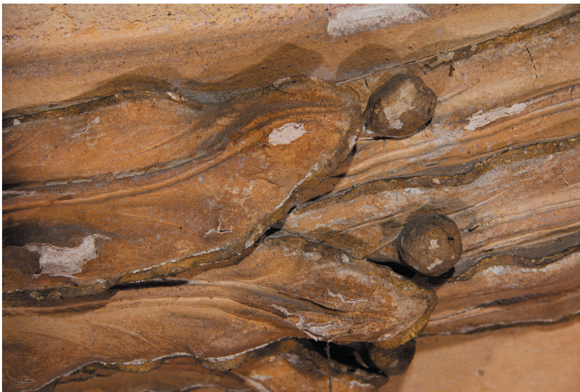
Obr. 54: Detail štukového rámu; lokálně došlo ke ztrátě okrové barevné vrstvy. Zlacení odpadáva ve formě šupin.
