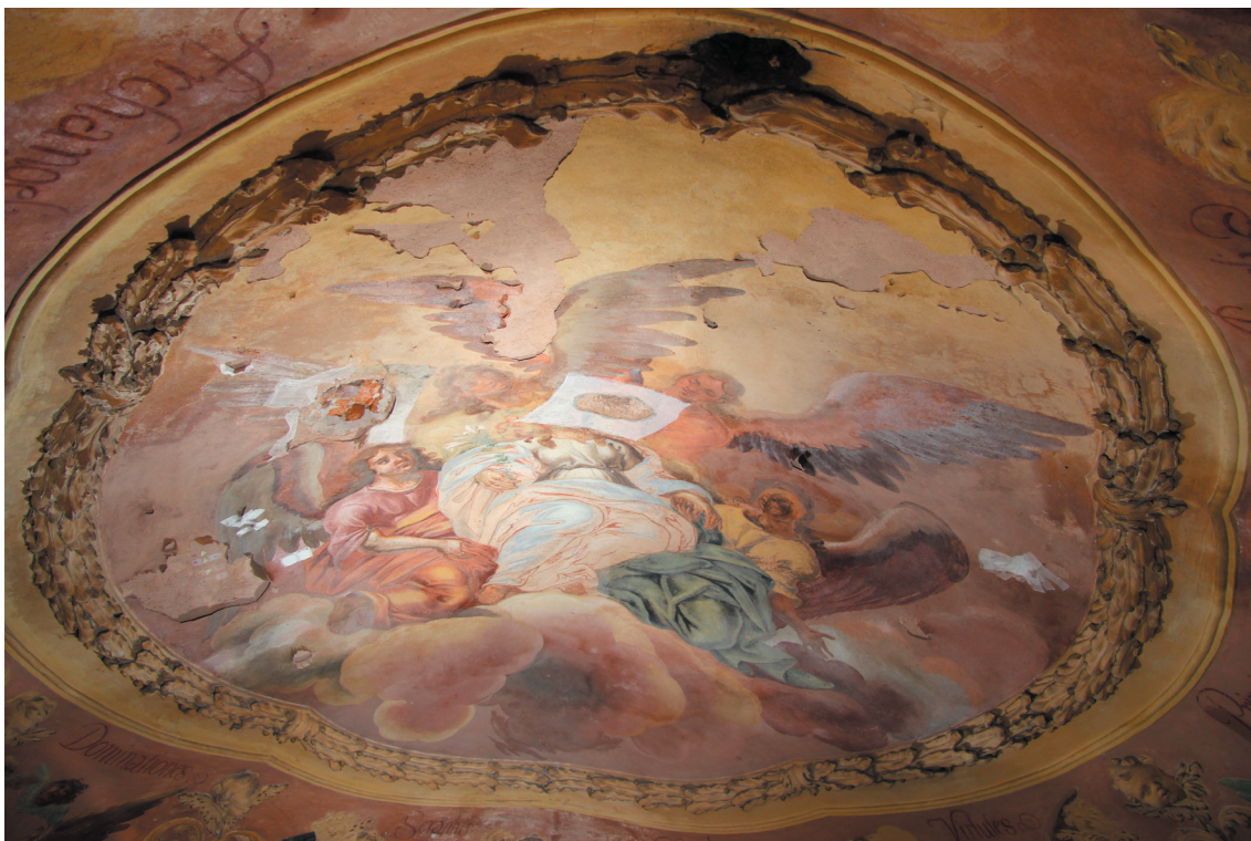
Obr. 50: Výjev Nanebevzetí Panny Marie lemovaný štukovým rámem z vavřínových lístků. V průběhu restaurátorského průzkumu bylo upraveno lešení tak, že bylo možné vyfotografovat malbu jako celek. Dobře viditelný je rozsah ztrát barevné vrstvy.
