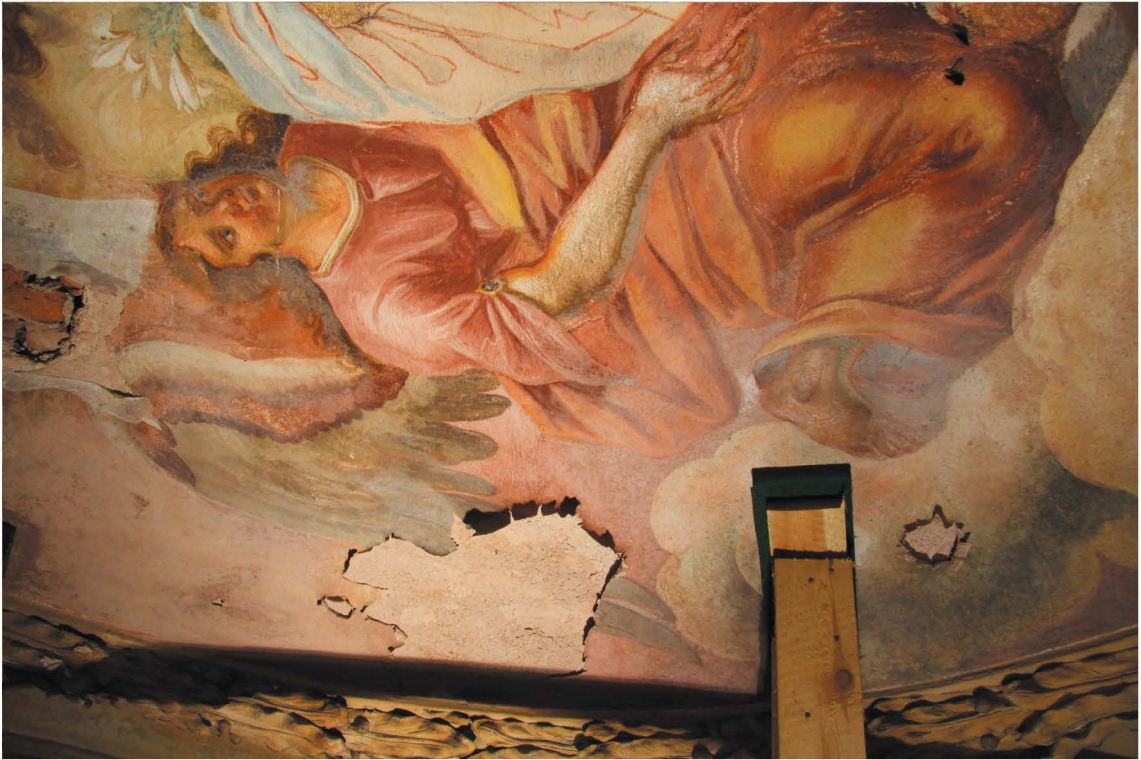
Obr. 31: Levá (severní) část výjevu Nanebevzetí Panny Marie. Na postavě anděla, zejména v oblasti malovaných stínů, se objevuje šedý zákal. Barevná vrstva ztratila adhezi a svítkově se odlupuje. Lešení je vzeptřené přímo o malbu.
