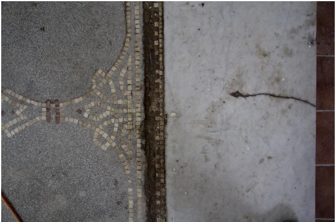
Obr. 60 Schodišťová hala, detail poškození ozdobného mozaikového pásu
