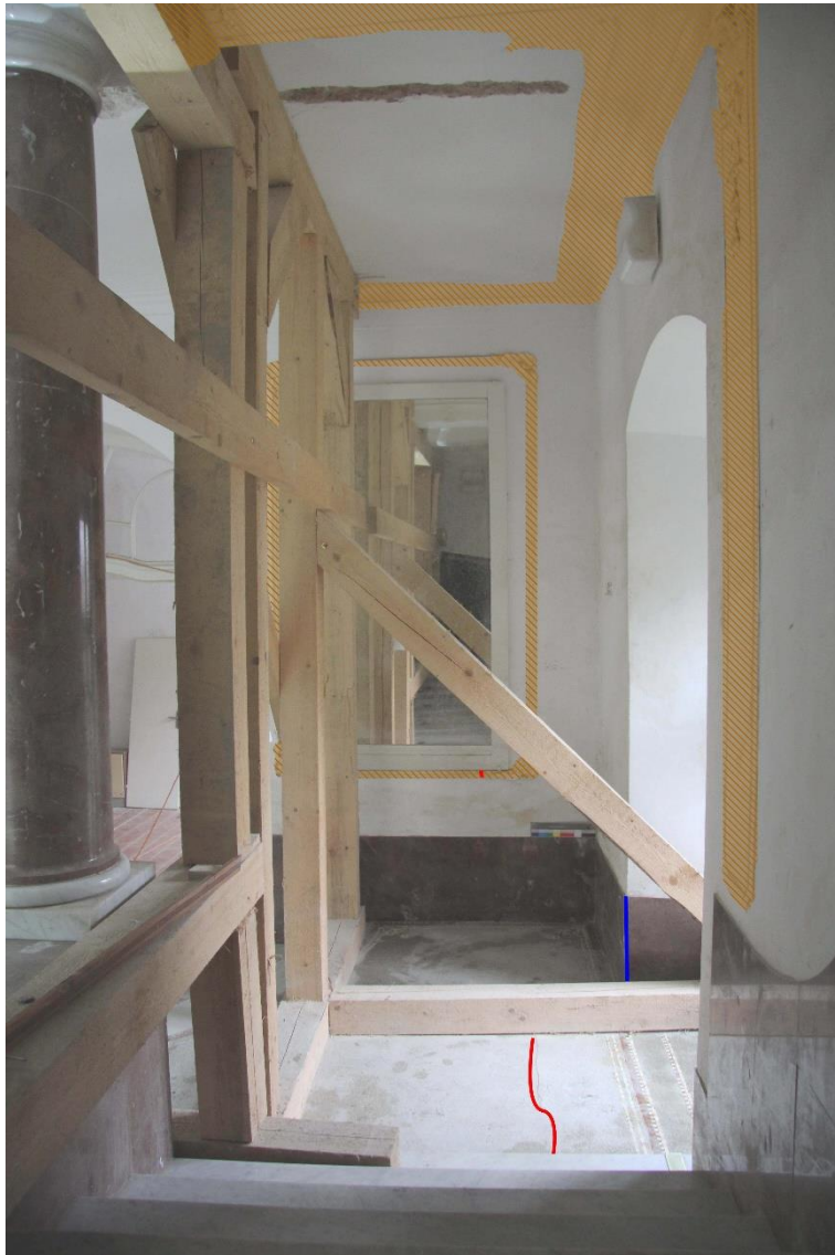
Obr. 64 Zákresy poškození schodišťová hala, severní stěna
