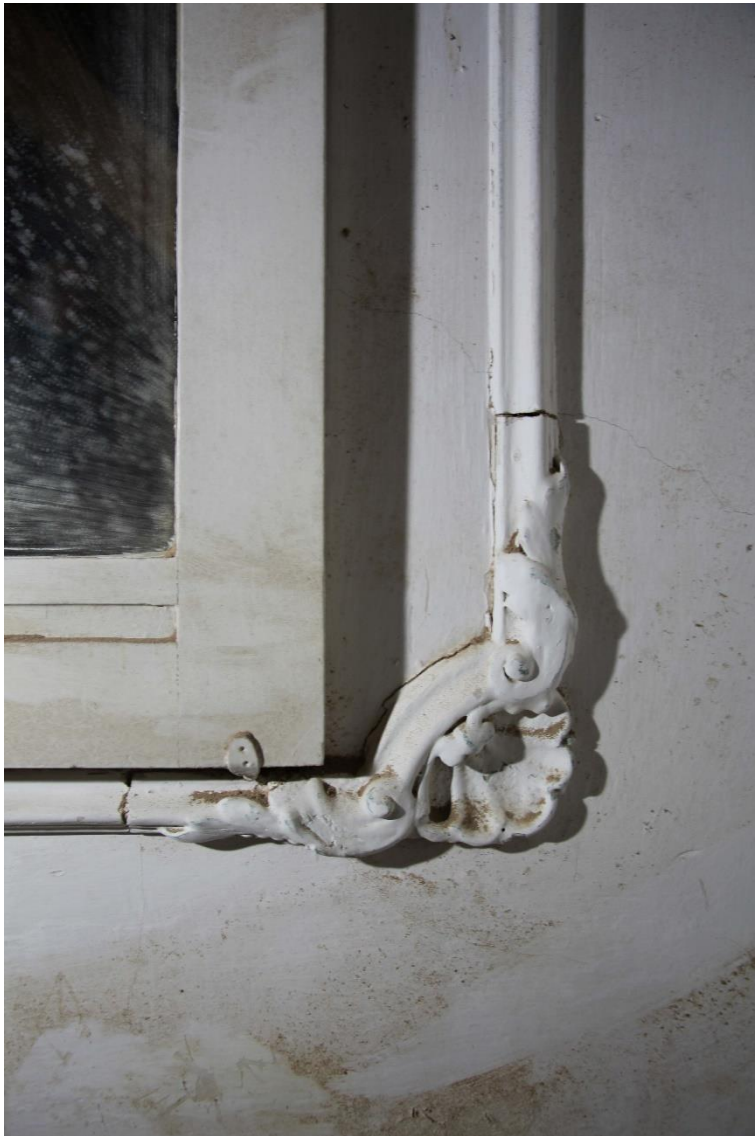
Obr. 56 Schodišťová hala, detail poškození štukového rámu
