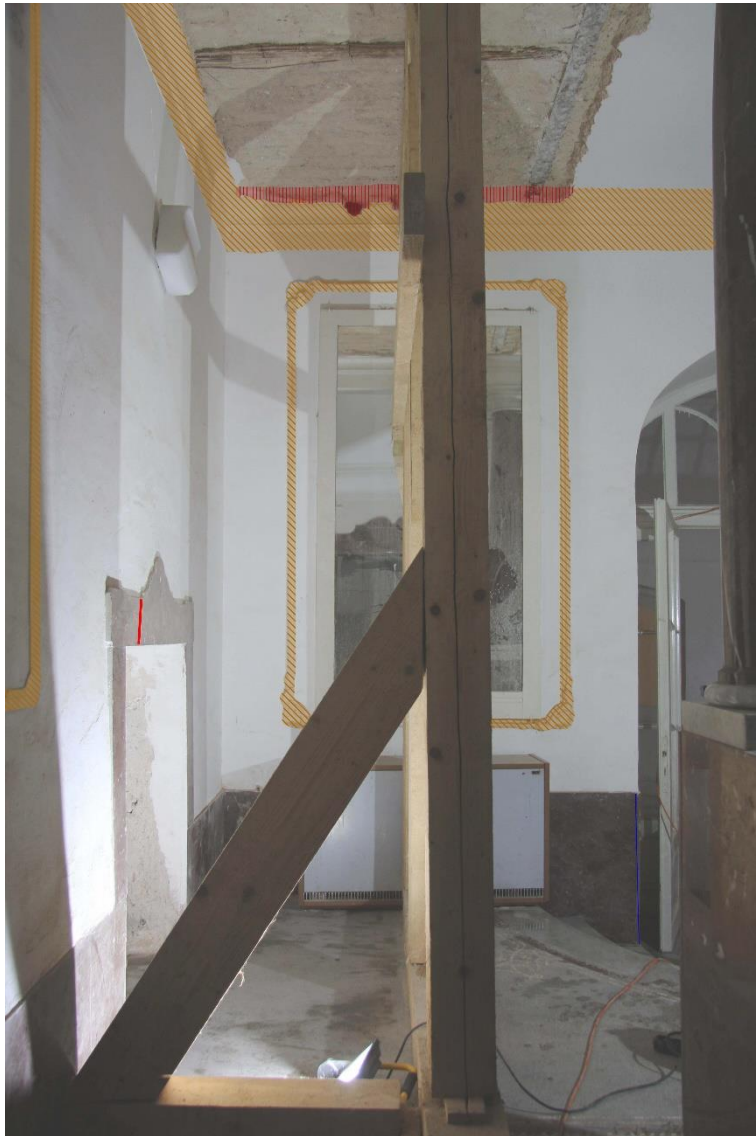
Obr. 63 Zákresy poškození schodišťová hala, jižní stěna
