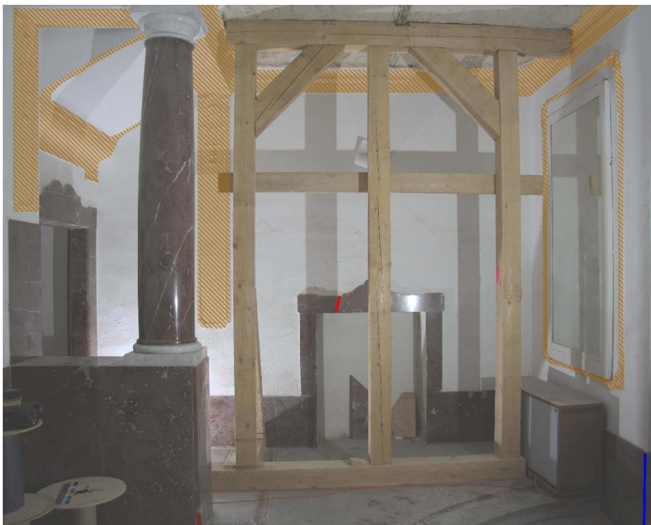
Obr. 67 Zákresy poškození schodišťová hala, jižní stěna
