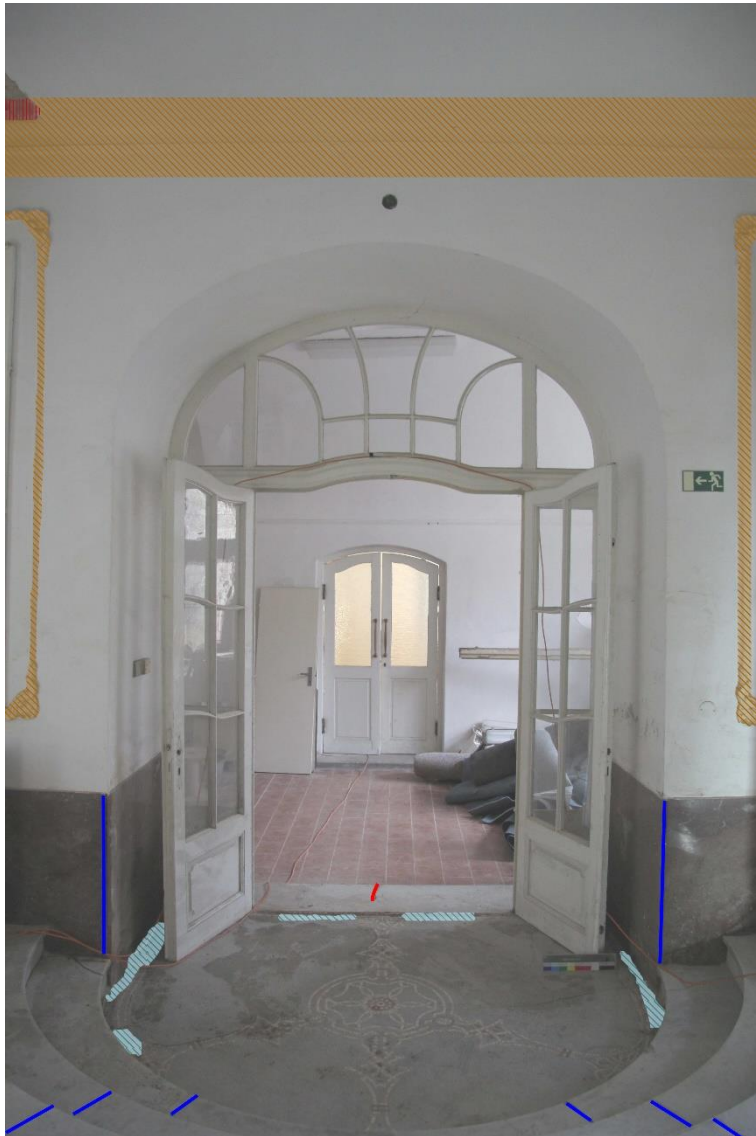
Obr. 65 Zákresy poškození schodišťová hala, hlavní vstup
