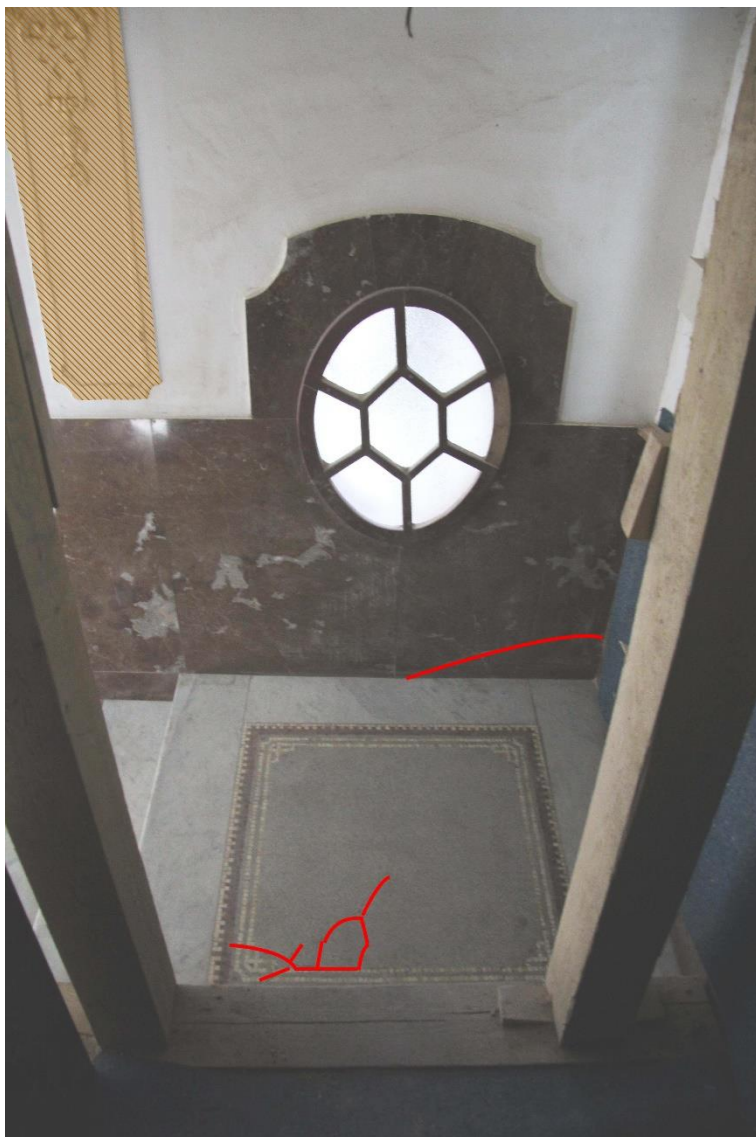
Obr. 69 Zákresy poškození schodišťová hala, severní schodiště mezipatro
