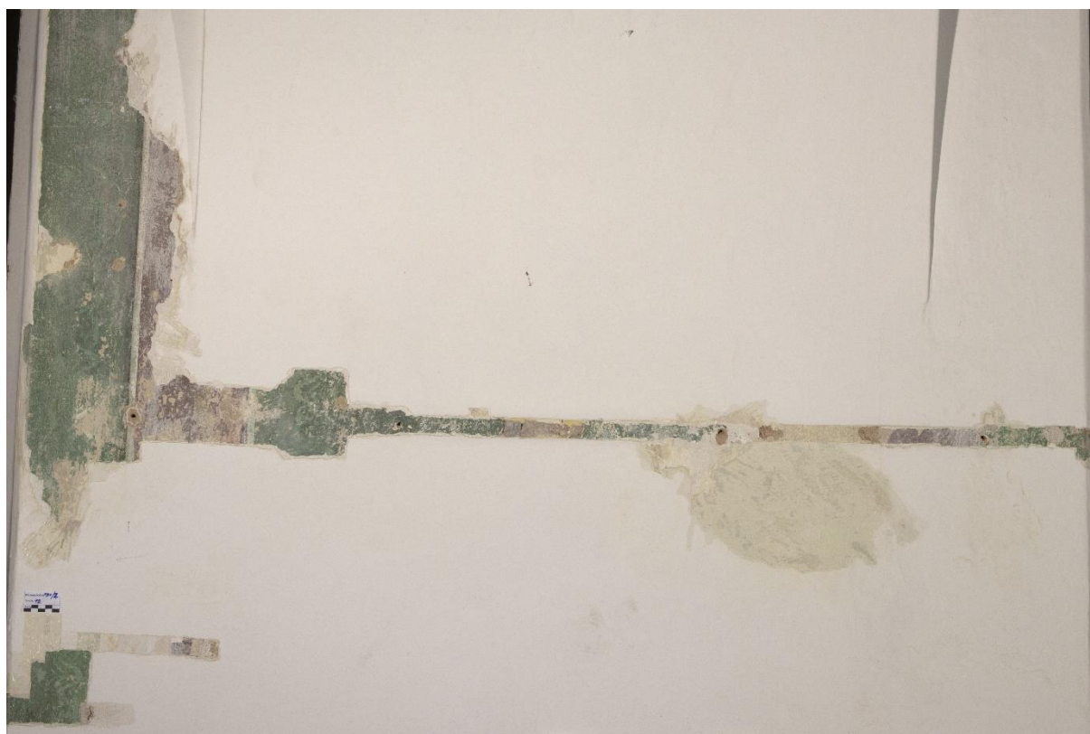
Obr. 31 Sonda 12, detail vrstvy č. 3 na rozmezí stěny a klenby
