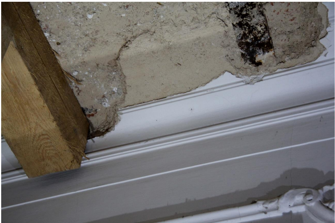
Obr. 58 Schodišťová hala, detail poškození stropu
