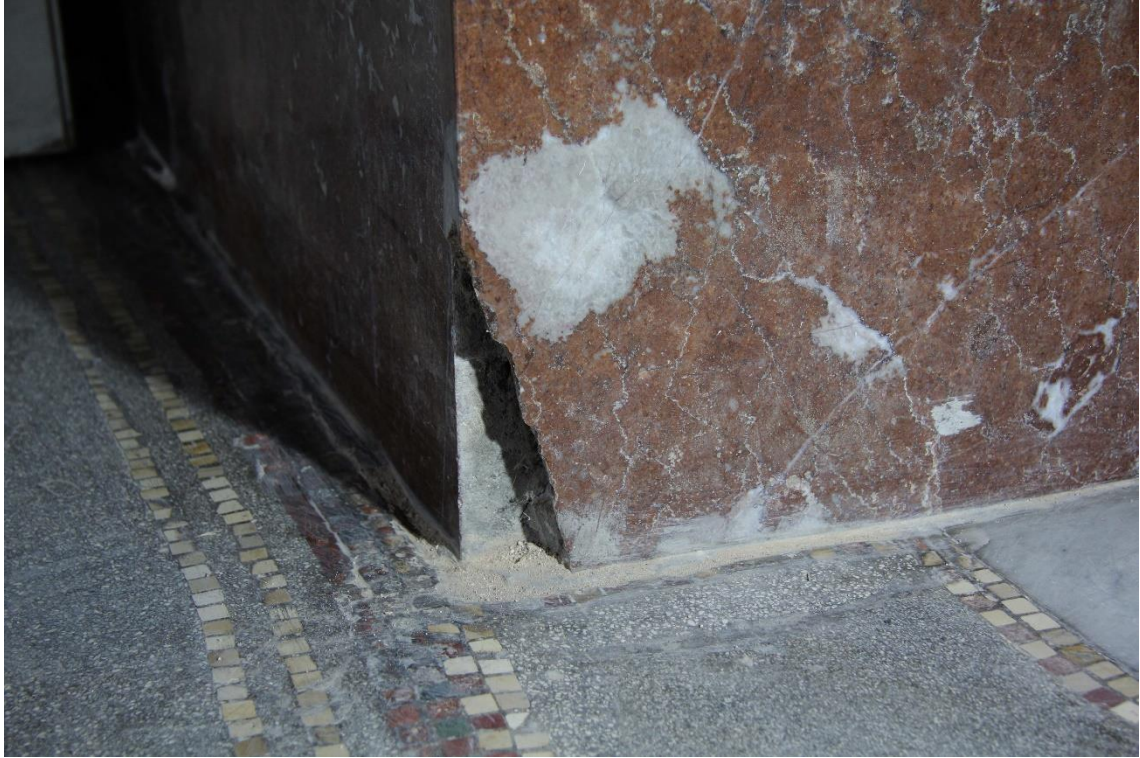
Obr. 59 Schodišťová hala, detail poškození mramorového obkladu
