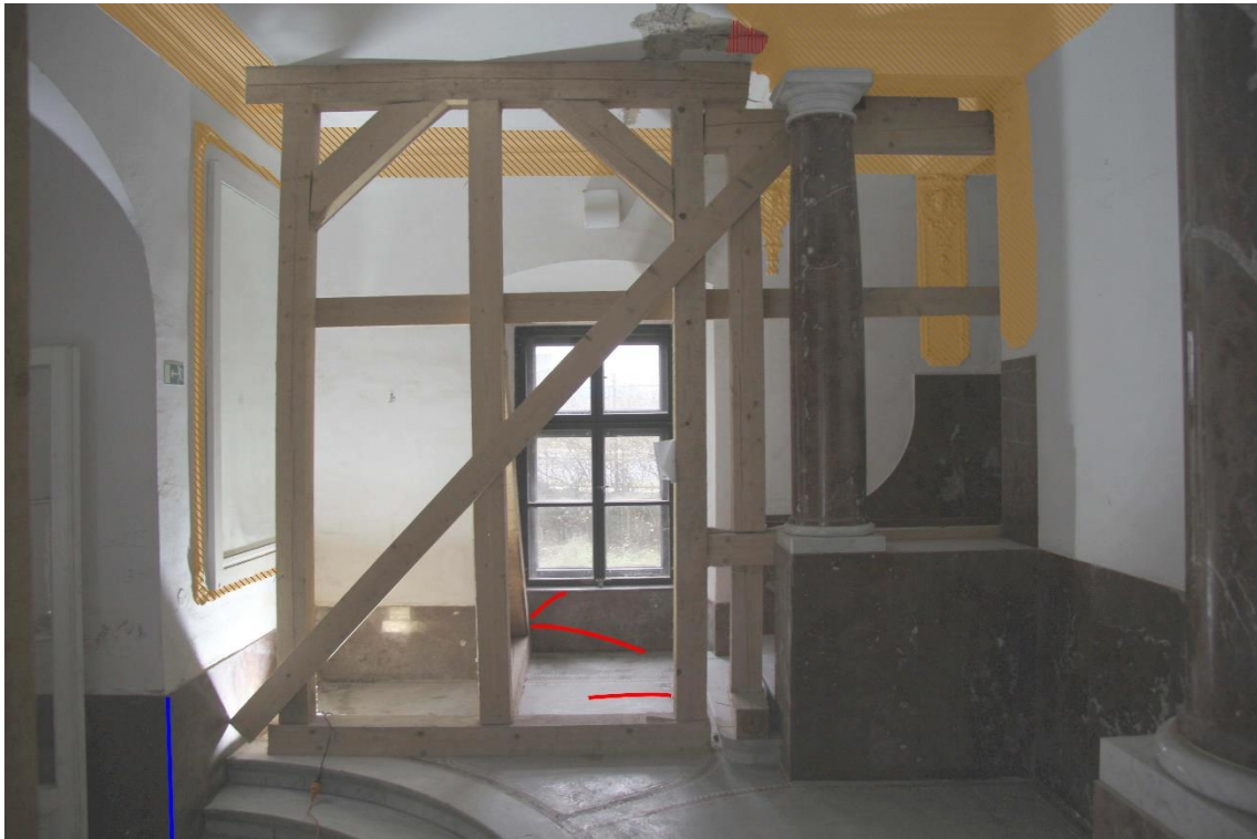
Obr. 66 Zákresy poškození schodišťová hala, severní stěna
