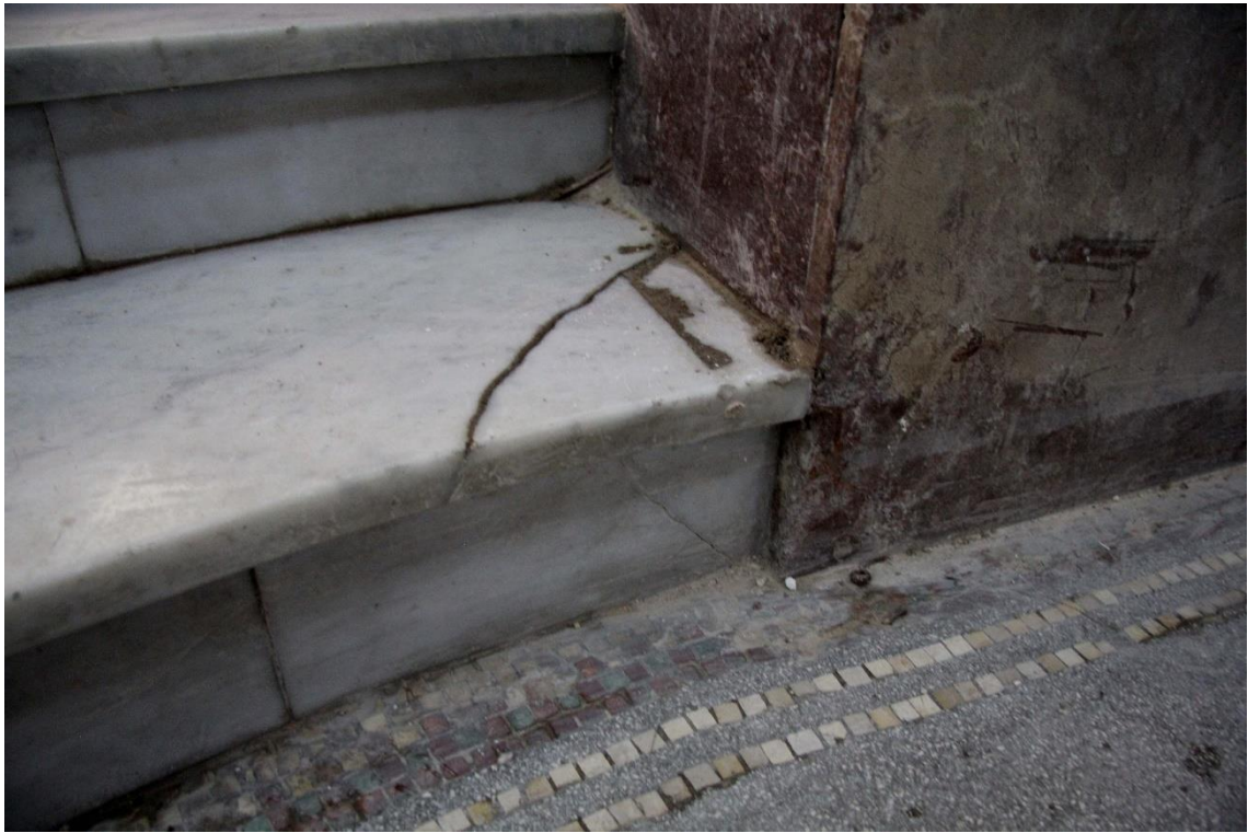
Obr. 61 Schodišťová hala, detail poškození vstupního schodiště
