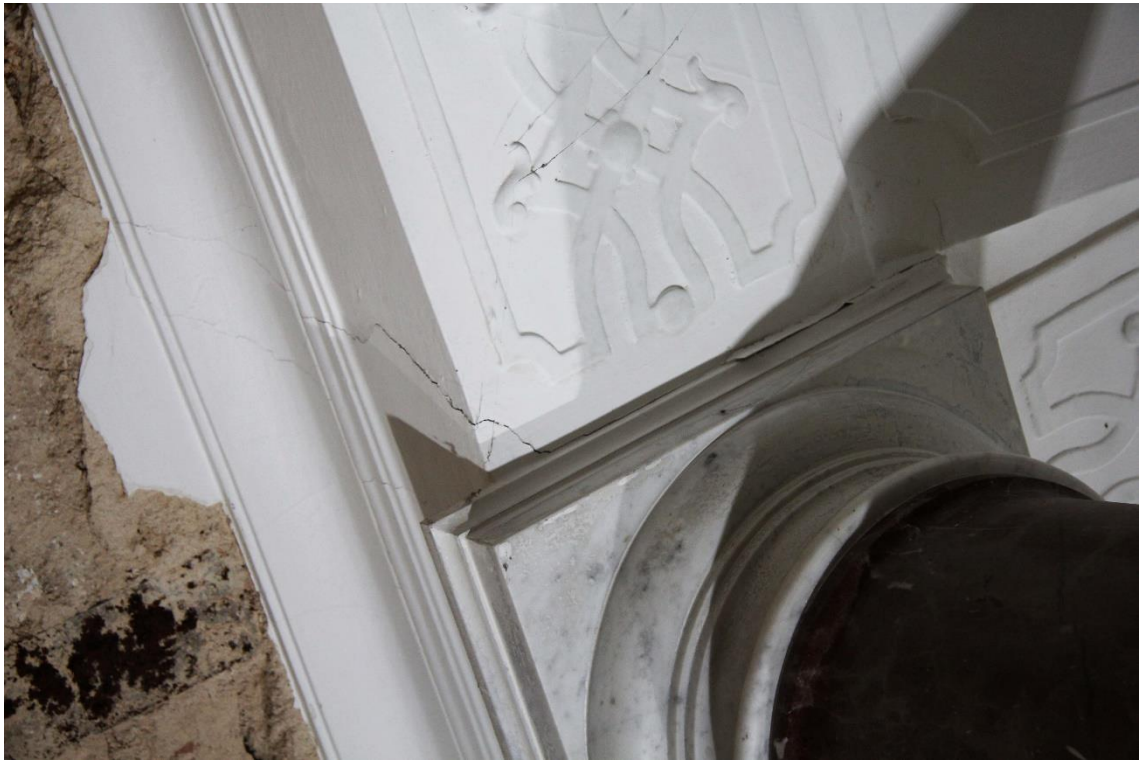
Obr. 57 Schodišťová hala, strop, detail poškození štukového dekoru
