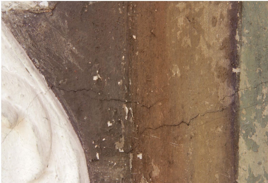
Obr. 71. Detail prasklin a poškození barevné vrstvy
