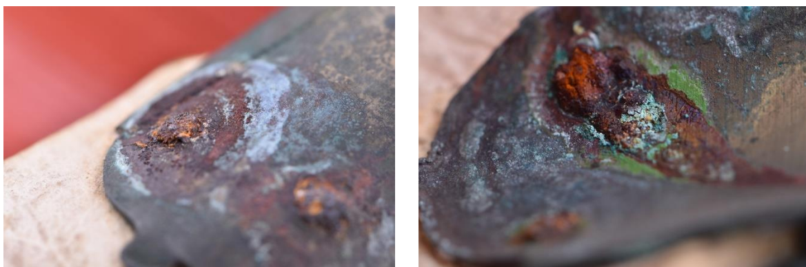
Obr. č. 76 Ďalšie príklady spon poškodených v mieste fixácie galvanickým článkom. Sign. I E 3, I E 9
