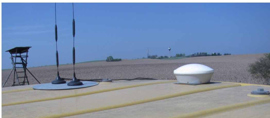
Obrázek 5.10 – Umístění dvou GSM antén a GNSS antény na střeše
