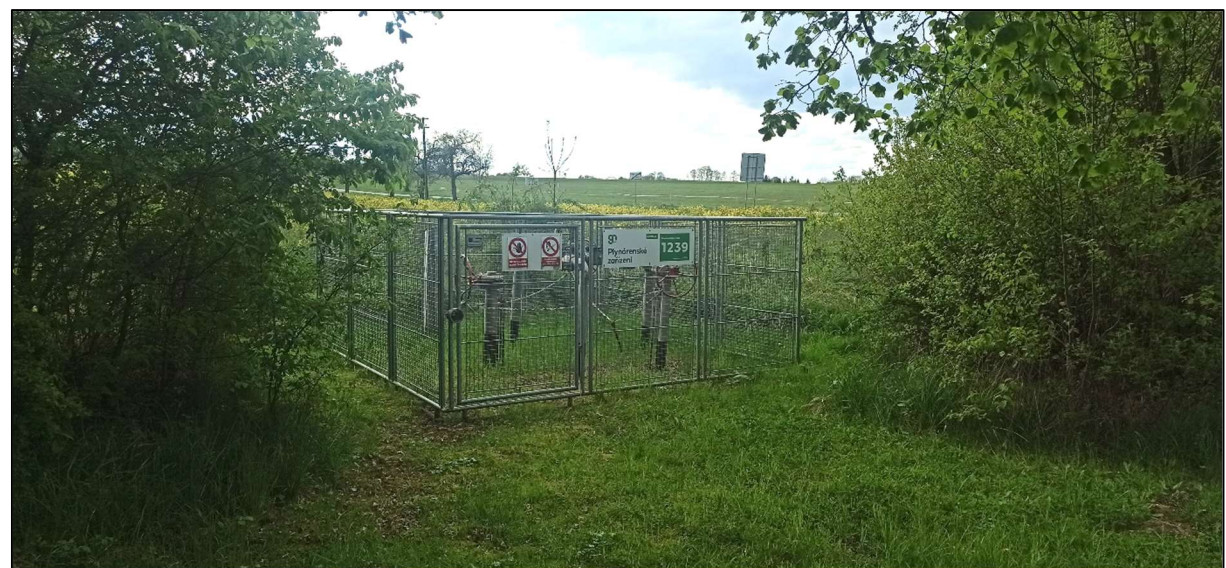
Obrázek 10: Plynárenské zařízení VTL plynovodu
