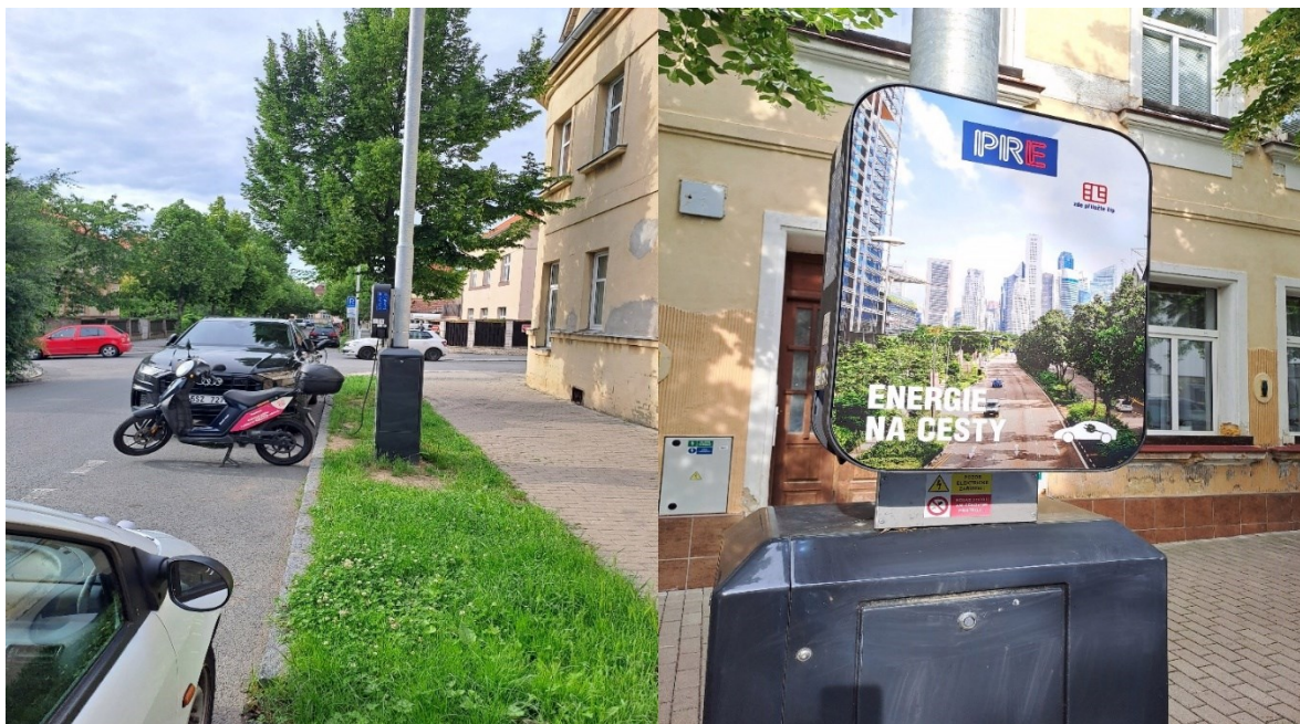
Obrázek 10: Dobíjení EV z veřejného osvětlení
