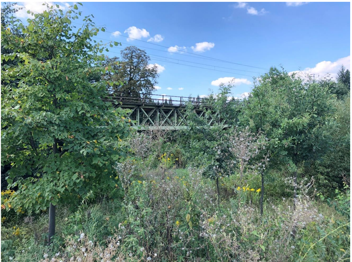
Obrázek 5 - Boční pohled na mostní objekt z druhé strany Cidliny [fotografie: archive autora]
