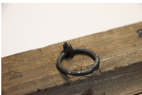
Obr. 22 Stav před restaurováním, detail koroze na závěsném systému
