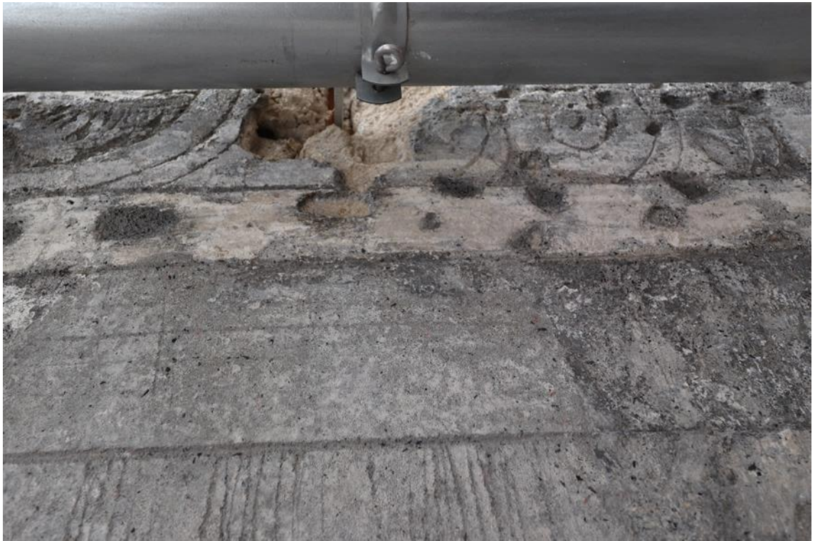
Obr. 55. Stav před restaurováním.
