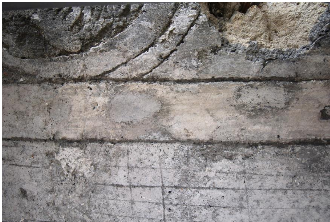
Obr. 17. Detail oblasti rollwerku v pravé části výjevu „č.34“ ve stavu před restaurováním. Zachycuje otevřenou strukturu defektu v oblasti ukotvení okapového svodu a odhaluje omítkové souvrství.
