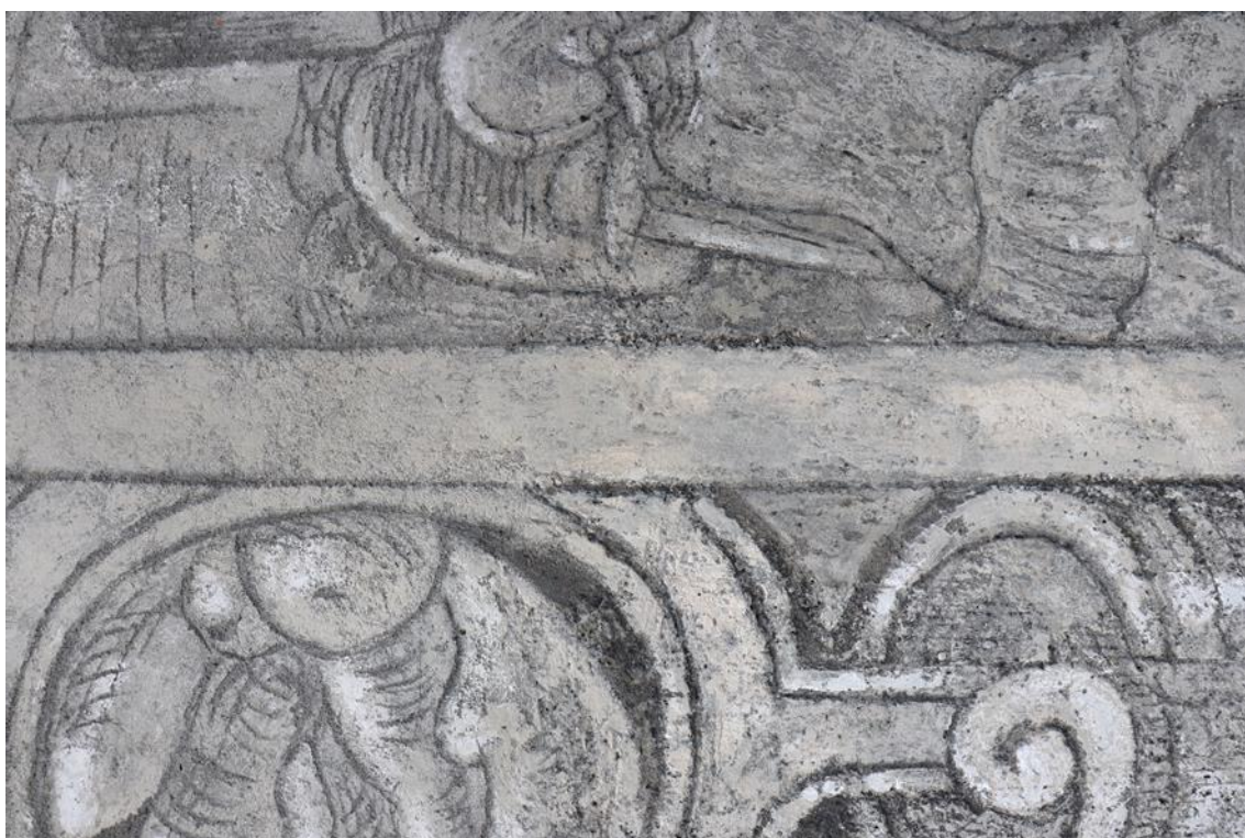
Obr. 61. Detail stejné oblasti. Původně s probíhající prasklinou. Stav po restaurování.
