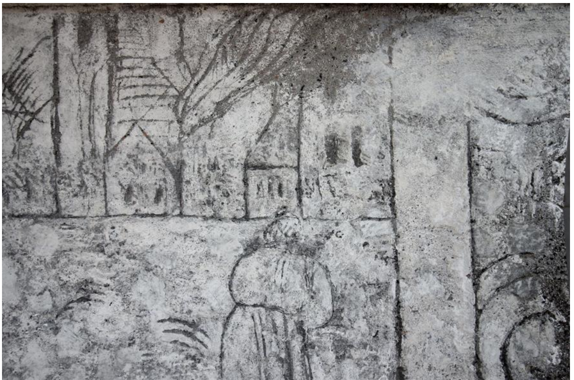
Obr. 13. Detail pravého horního rohu výjevu „č. 19“ ve stavu před restaurováním. Viditelný rozdíl v barevnosti druhotných tmelů v horní části nad architekturou vedle originálních omítkových vrstev. Zejména v části s rollwerkem, kde je probarvená vrstva bez povrchového vápenného nátěru.
