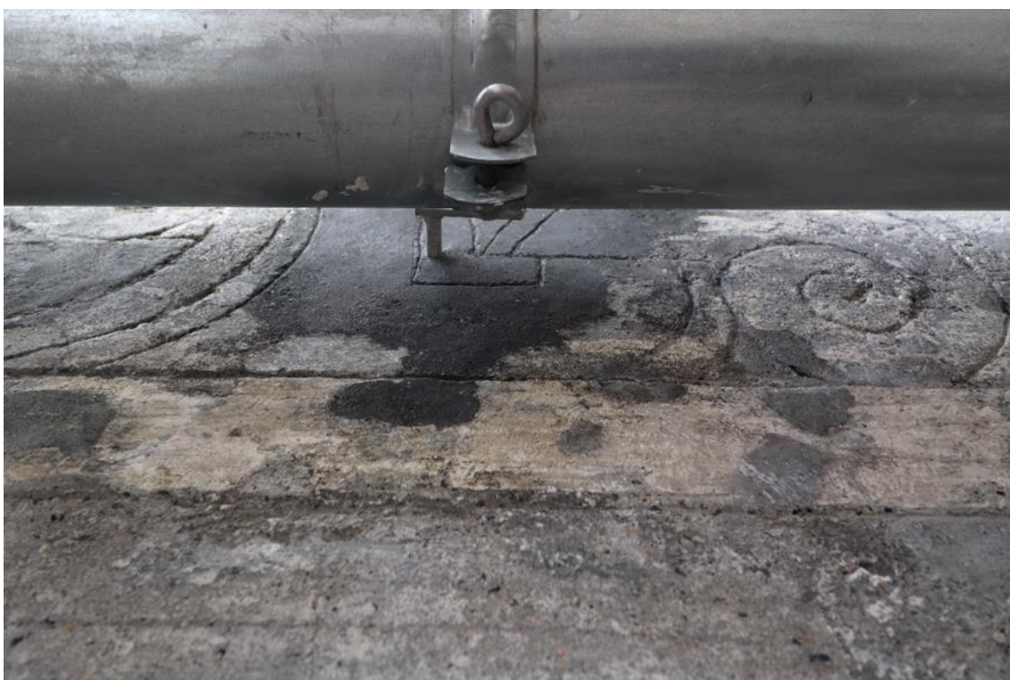
Obr. 58. Stav po vytmelení probarvené omítkové vrstvy.
