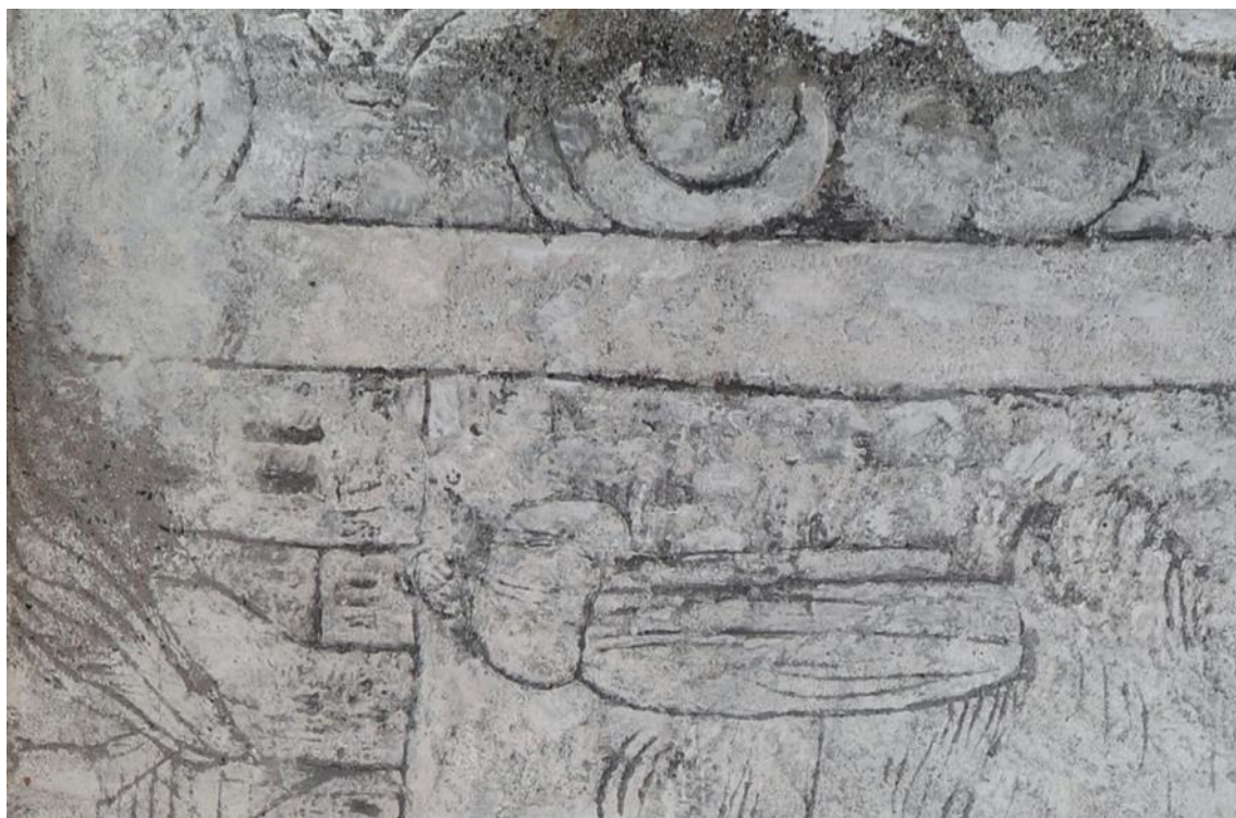
Obr. 39. Stav před restaurováním.
