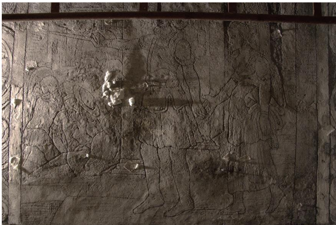
Obr. 23. Větší část výjevu „č. 34“ v umělém bočním nasvícení. Stav v průběhu injektáže. Zvýraznění struktury a nerovností povrchu. V centrální části viditelná vypouklina omítkových vrstev.
