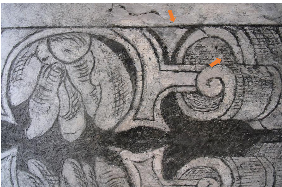
Obr. 18. Detail oblasti rollwerku v levé části výjevu „č.34“ ve stavu před restaurováním. Zachycuje prasklinu probíhající z oblasti stočeného pásku v dolní části směrem do plochy výjevu.
