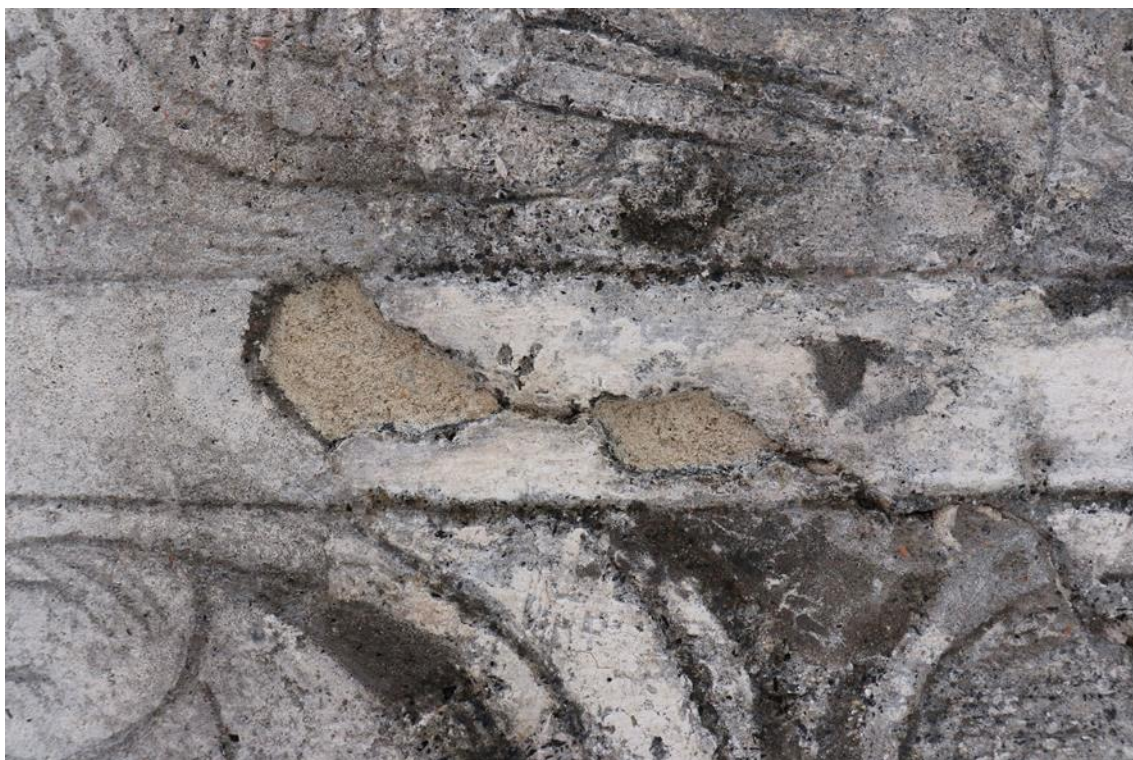
Obr. 33. Detail defektu v oblasti rámové pásky v levé části výjevu „č. 34“. Stav po vytmelení vrstvy jádrové omítky.
