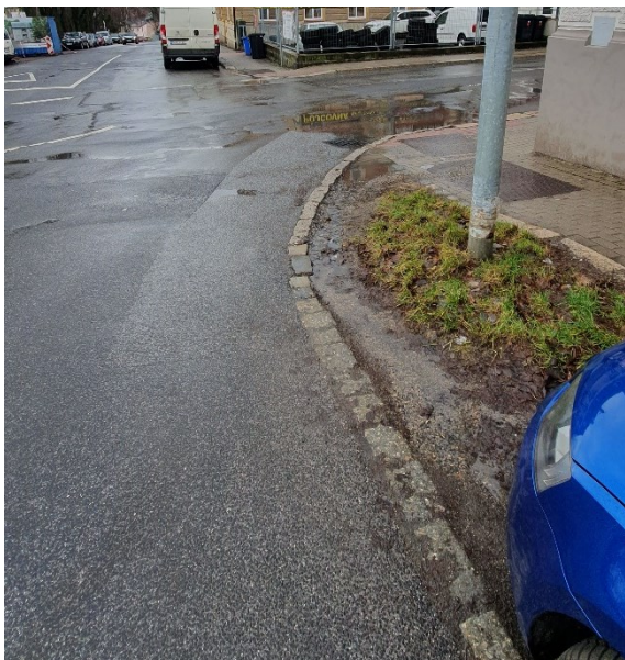
Obrázek 12 Deformace krajnice vozovky v křižovatce
