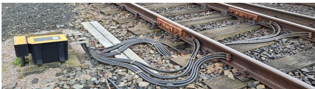
Obr. 7 Stykový transformátor s izolovaným stykem
